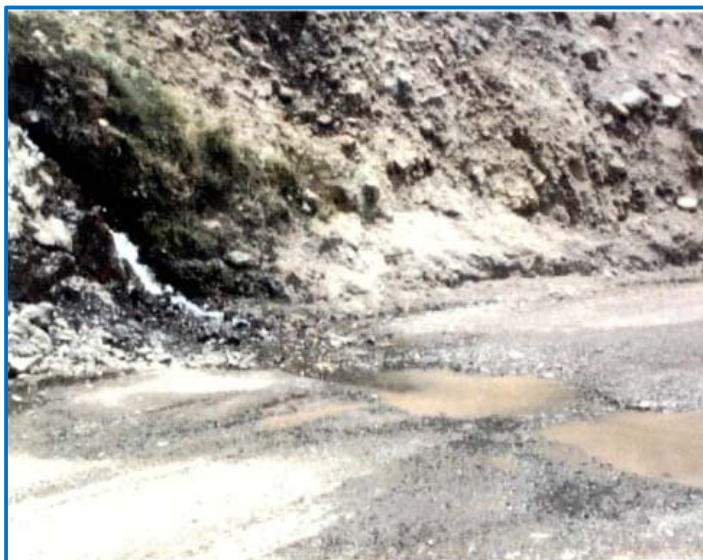
Figura N° 19: Cruce de aguas
