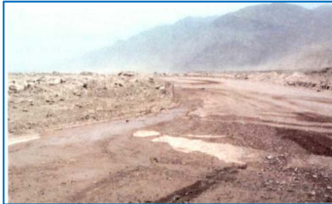
Figura N° 15: Baches (Huecos) - Gravedad 2: Necesita una capa de material adicional
