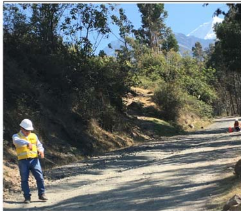
Foto 11: Inventario de fallas , en la KM 76+000 - carretera Vaqueria - Yanama
