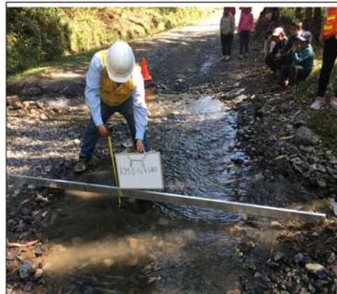
Foto 12: Inventario de fallas , en la KM 76+500 - carretera Vaqueria - Yanama
