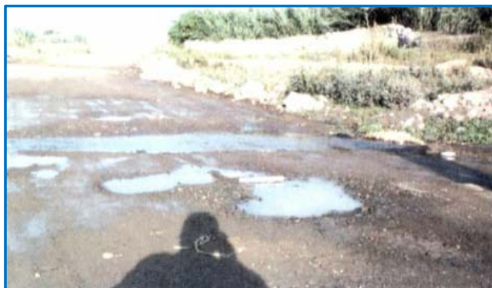
Figura N° 16: Baches (Huecos) - Gravedad 3: Necesita una reconstrucción
