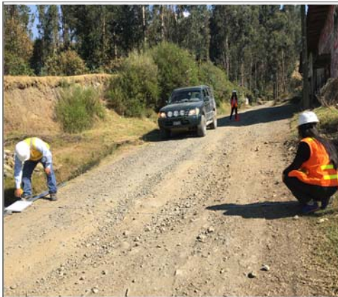
Foto 15: Inventario de fallas , en la KM 77+500 - carretera Vaqueria - Yanama
