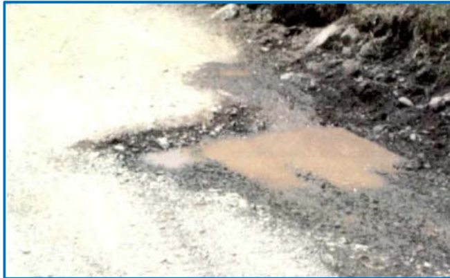
Figura N° 14: Baches (Huecos) - Gravedad 1: Pueden repararse por mantenimiento rutinario
