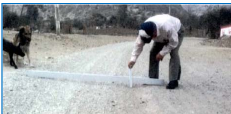
Figura N°9: Deformación - Gravedad 2: Huellas/hundimientos entre 5 cm y 10 cm
