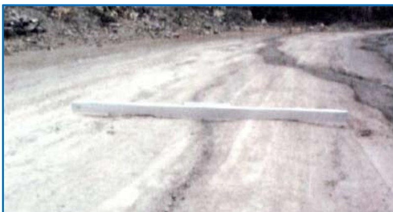
Figura N° 11: Erosión - Gravedad 1: Sensible al usuario, pero < 5 cm
