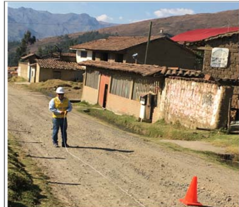
Foto 16: Inventario de fallas , en la KM 78+000 - carretera Vaqueria - Yanama
