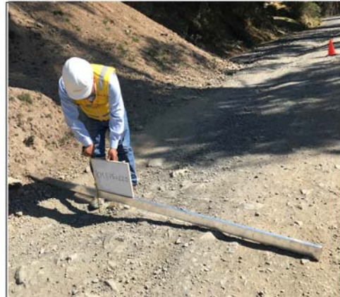
Foto 10: Inventario de fallas , en la KM 75+220 - carretera Vaqueria - Yanama
