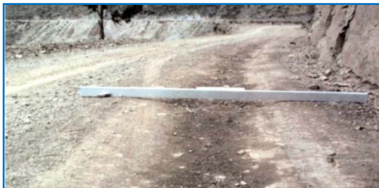
Figura N°10: Deformación - Gravedad 3: Huellas/Hundimientos \geq 10 cm
