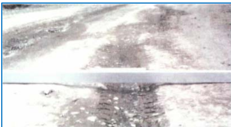
Figura N° 12: Erosión - Gravedad 2: Profundidad entre 5 cm y 10 cm
