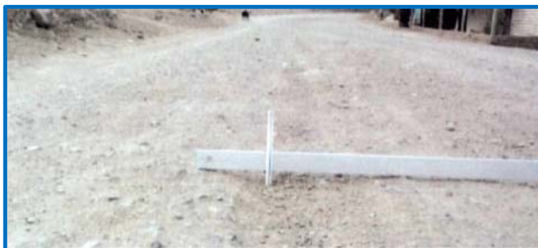
Figura N°8: Deformación - Gravedad 1: Huellas / hundimientos sensibles al usuario, pero < 5 cm
