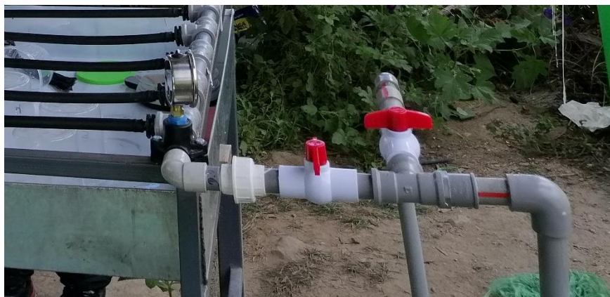
Figura 12: Llaves de paso adecuadas para controlar el caudal.
