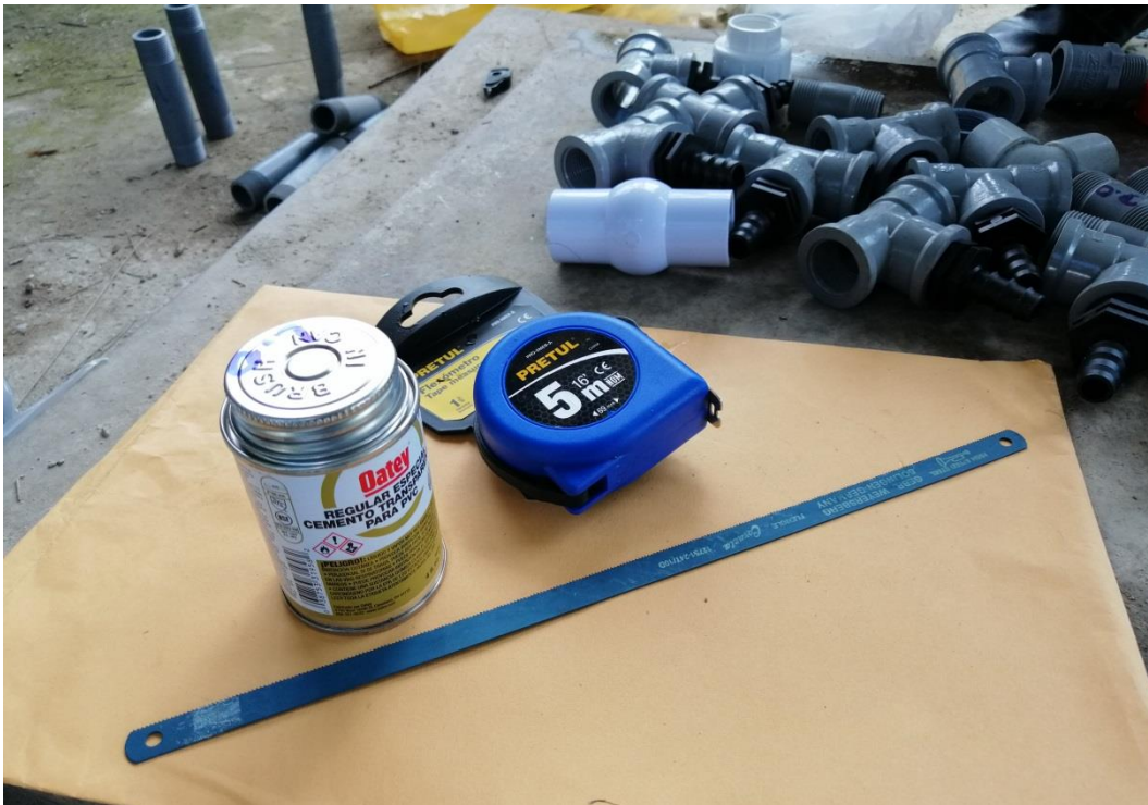
Anexo 9.7. instalación de tees y codos para la adecuar el banco de pruebas.
