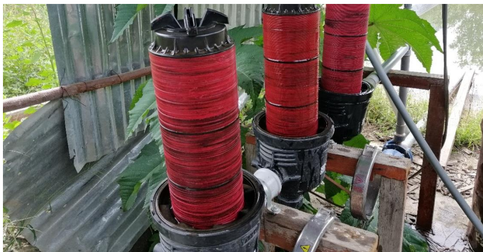
Figura 10: Unidad de filtrado instalado en el banco de pruebas.
