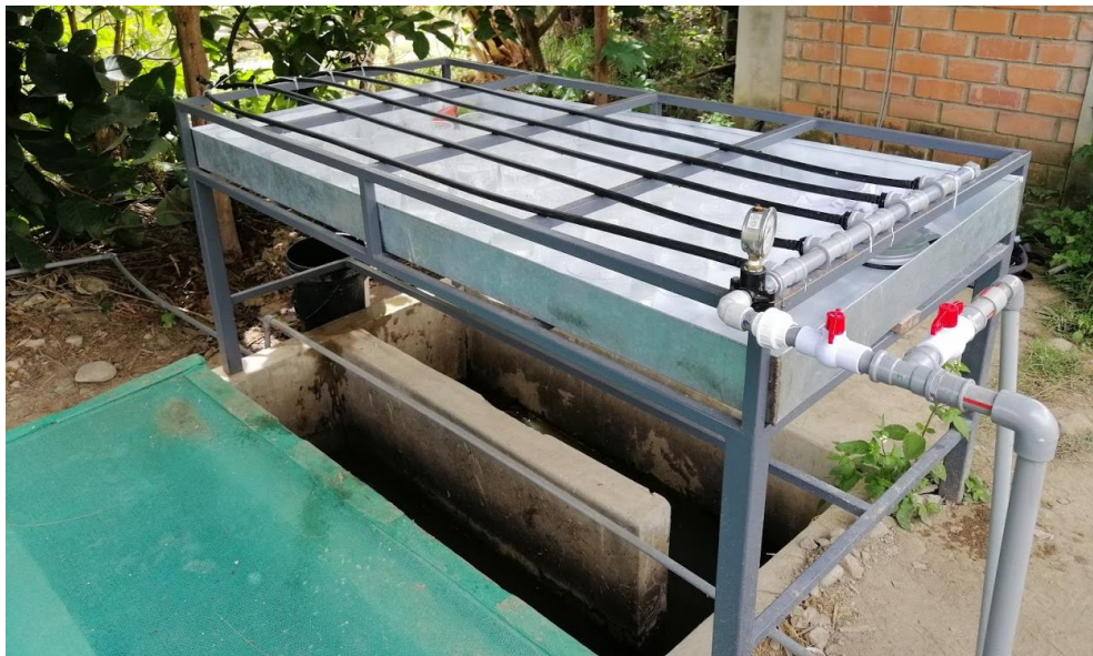
Figura 15: Banco de ensayos instalado.
