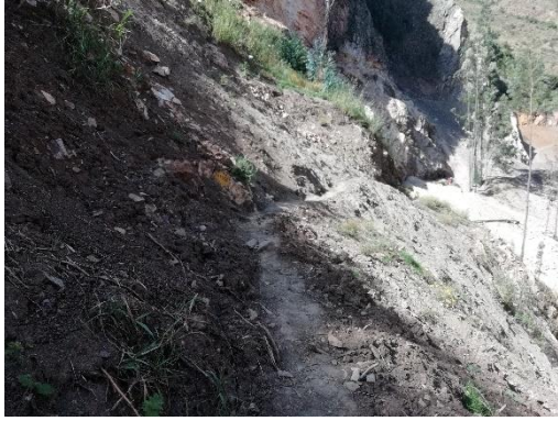
Vista del canal enterrado por el deslizamiento, progresiva 0+550
