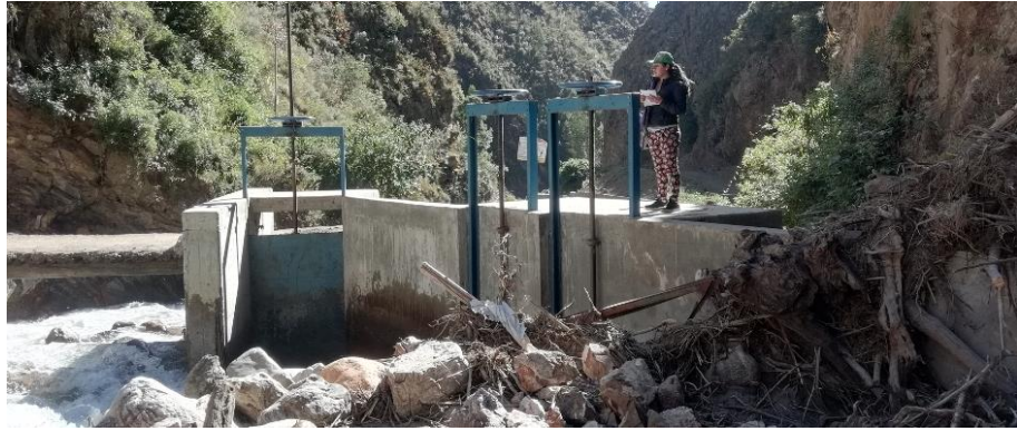
Figura 29. Agua arriba de la Captación.
