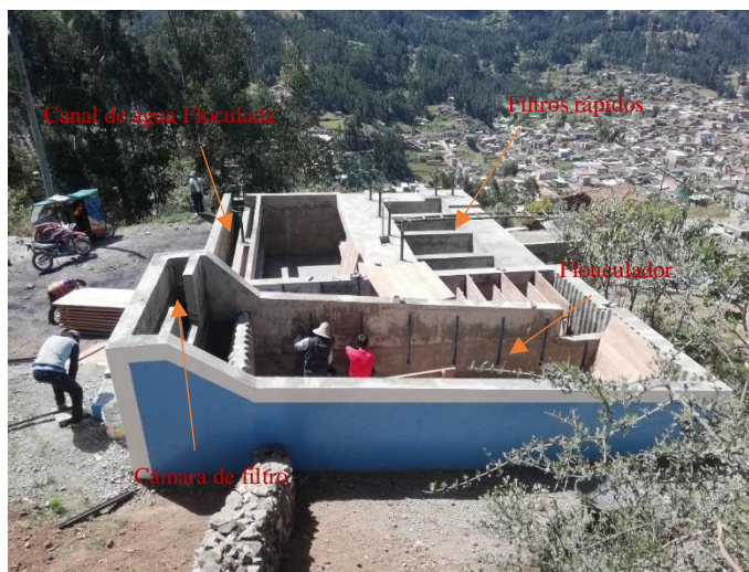
Figura 37. Decantador y floculador.
