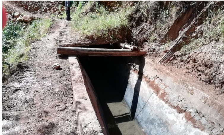
Figura 31. Canal abierto tapado con madera cubierto de tierra deslizada. Fuente: Fotografía tomada por Jhuliana Victoria, López Vega (2019)
