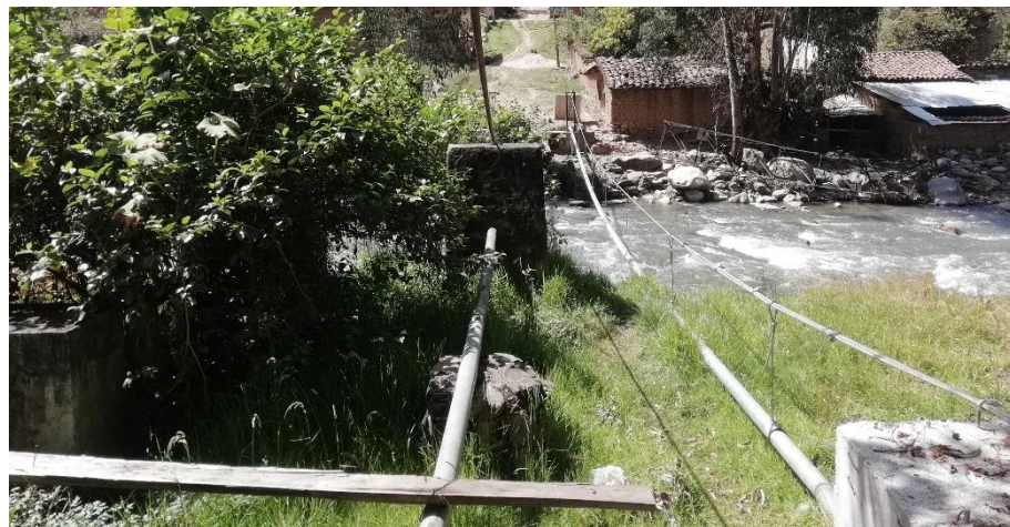
Figura 39. Línea de conducción (sifón invertido) - Pase aéreo.
