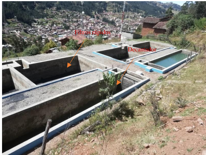
Figura 38. Decantador y filtros rápidos
