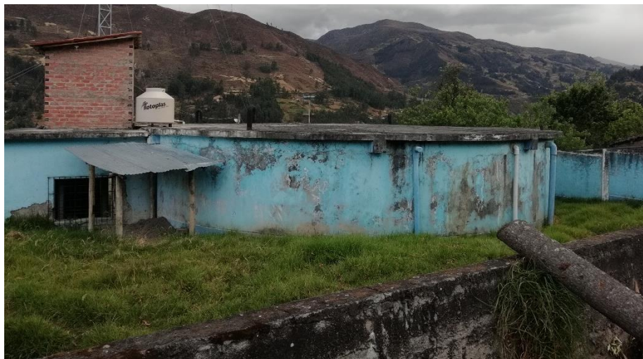
Figura 41. Reservorio en mal estado.
