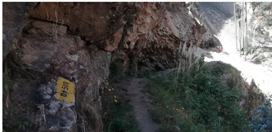
Figura 32. Canal abierto tapado con madera cubierto de tierra deslizada. Fuente: Fotografía tomada por Jhuliana Victoria, López Vega (2019)
