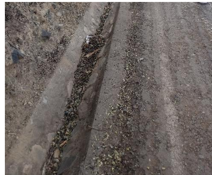
Fotografía 34. Cunetas de mampostería en buen estado estructural, parcialmente obstruido, además se nota en la calzada peladura y desprendimiento de gravedad 2.
