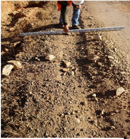
Fotografía 1. Calzada izquierda muy deteriorada, también se puede apreciar el deterioro total de la berma.
