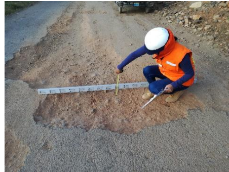
Fotografía 22. Bache de nivel de gravedad 3.
