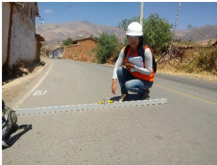
Fotografía 41. Medición de la pendiente transversal de la carretera, con ayuda de un eclímetro
