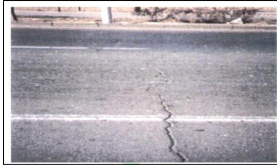
Figura 11. Deterioro Tipo Fisuras Transversales Fuente: Manual de Carreteras Mantenimiento o Conservación Vial (2014).
