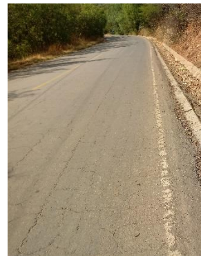
Fotografía 68. Fisuras longitudinales en la calzada.
