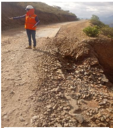
Fotografía 9. Peladura y desprendimiento de nivel de gravedad 3, bermas completamente deterioradas.
