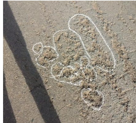
Fotografía 32. Presencia de baches de gravedad 1 en la calzada.
