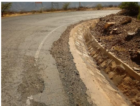
Fotografía 51. Cuneta de mampostería en buen estado funcional y estructural, berma deteriorado, peladura en la calzada, gravedad 2.
