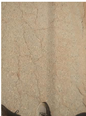
Fotografía 23. Piel de Cocodrilo de nivel de gravedad 2 en la calzada.
