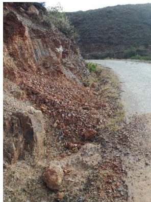
Fotografía 29. Deslizamiento de taludes, generan obstrucción en cunetas de tierras, además afectan la calzada.
