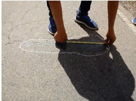
Fotografía 57. Exudación en la calzada.
