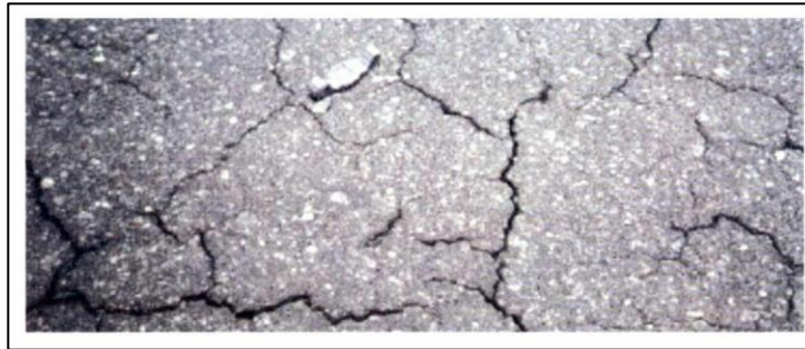
Figura 4. Deterioro Tipo Piel de Cocodrilo
