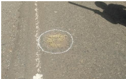
Fotografía 59. Bache de nivel de gravedad 2.
