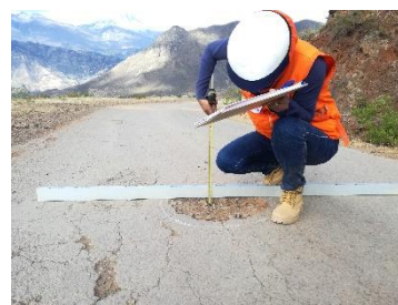
Fotografía 30. Bache de gravedad 3, además se observa piel de cocodrilo, que se extiende por toda la calzada.
