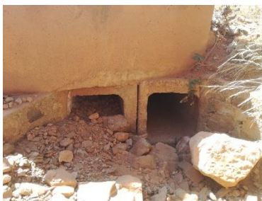
Fotografía 17. Alcantarilla de 2 Ojos, se Observa la Obstrucción Completa de un Ojo.
