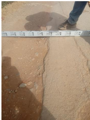
Fotografía 15. Peladura y Desprendimiento de Gravedad 3, de la calzada izquierda, también se puede observar deterioro del tipo deformación por deficiencia estructural en la calzada derecha.
