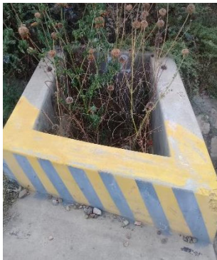
Fotografía 77. Alcantarilla en estado funcional obstruido y condición estructural buena.
