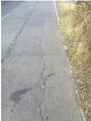
Fotografía 75. Fisuras longitudinales en la calzada, berma deteriorada.
