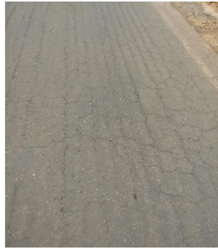
Fotografía 40. Piel de cocodrilo y f. longitudinales y transversales en toda la calzada.
