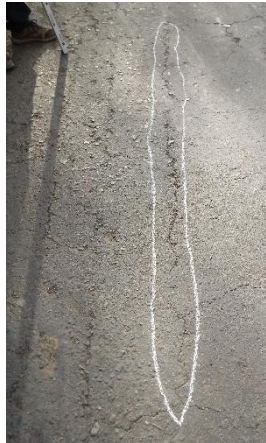
Fotografía 33. Fisuras longitudinales en la calzada.
