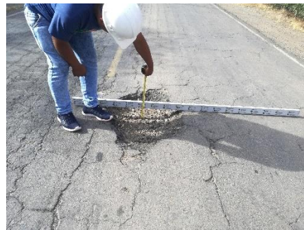
Fotografía 78. Baches de nivel de gravedad 3, además se puede observar deterioros de tipo piel de cocodrilo.
