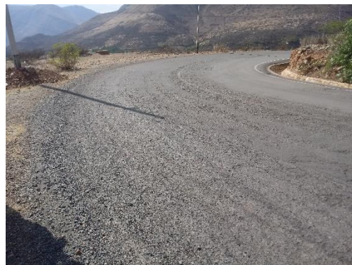
Fotografía 52. Peladura y desprendimiento de gravedad 2 en la curvatura de la vía.
