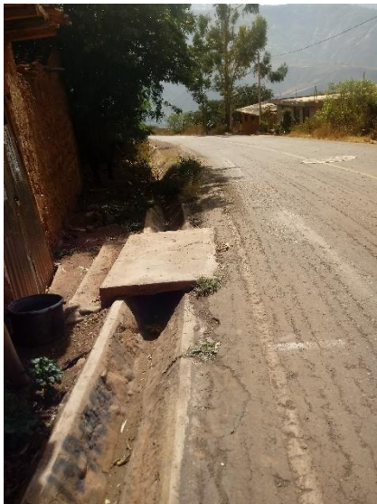
Fotografía 45. Cuneta en buen estado, berma deteriorada, fisuras longitudinales en calzada.
