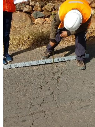
Fotografía 38. Deformación por deficiencia estructural y piel de cocodrilo en la calzada.
