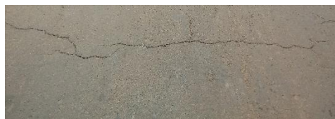
Fotografía 54. Fisuras transversales en la calzada
