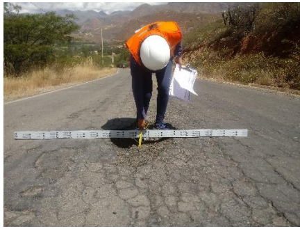
Fotografía 63. Baches de nivel de gravedad 3, piel de cocodrilo de nivel de Gravedad 3.
