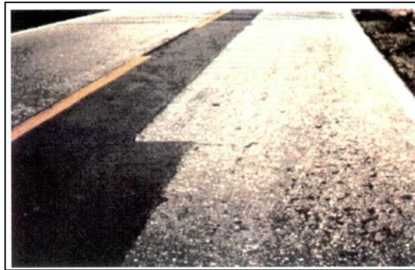
Figura 8. Deterioro Tipo Reparaciones o Parchado Fuente: Manual de Carreteras Mantenimiento o Conservación Vial (2014).
