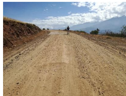
Fotografía 18. Vista panorámica de la calzada al km 136+000 - 137+000, completamente deteriorados.
