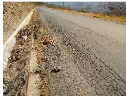
Fotografía 66. Piel de cocodrilo de nivel de gravedad 3 y deformación por deficiencia estructural.
