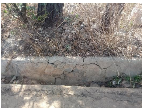
Fotografía 47. Presencia de fisuras en cuneta.
