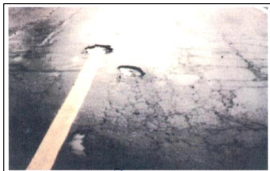
Figura 10. Deterioro Tipo Baches
