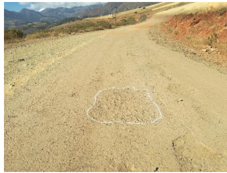
Fotografía 8. Presencia de peladuras de gravedad 2 y 3, bermas deterioradas completamente.
