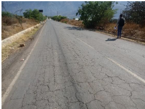
Fotografía 49. Piel de cocodrilo, y ahuellamiento en la calzada del carril izquierdo.
