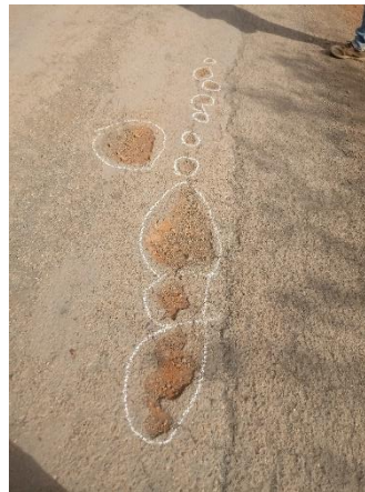
Fotografía 16. Presencia de múltiples baches de gravedad 1 y 2.
