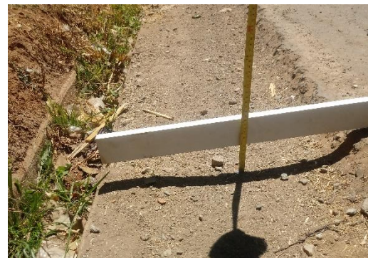
Fotografía 42. Canal completamente obstruido, berma deteriorada.
