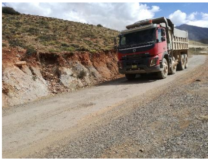
Fotografía 11. Vehículo en circulación, proveniente de la minera cercana, debido a la carga de transporte, causa deterioro instantáneo tras su paso por el km +136+000 - km 137+000.
