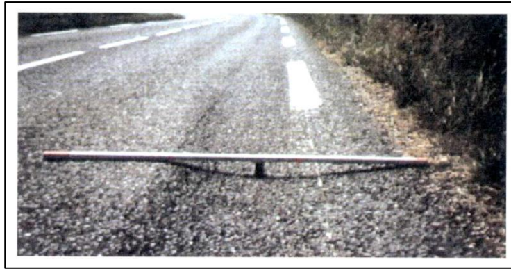
Figura 6. Deterioro Tipo Deformación por Deficiencia Estructural
