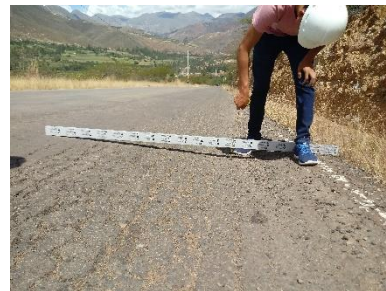
Fotografía 58. Deformación por deficiencia estructural.
