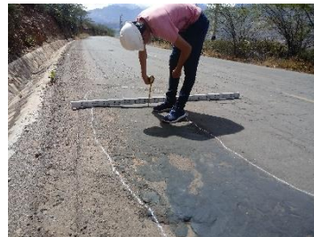
Fotografía 60. Exudación y deformación por deficiencia estructural.
