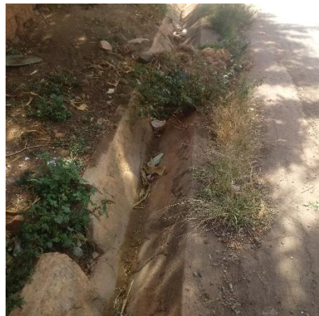
Fotografía 46. Cuneta en condición estructural y funcional regular.
