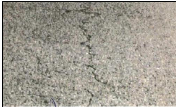
Figura 5. Deterioro Tipo Fisuras Longitudinales
