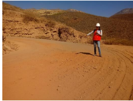
Fotografía 14. Curvatura de la carretera completamente deteriorada, desprendimiento total de la carpeta asfáltica.
