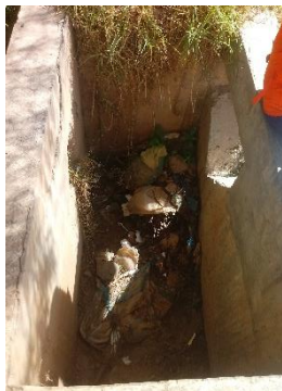
Fotografía 65. Vista interior de alcantarilla de paso obstruida.
