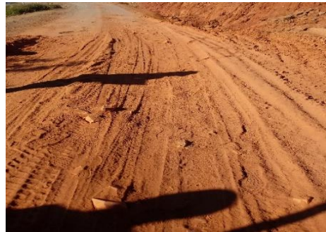
Fotografía 4. Desprendimiento total de la carpeta asfáltica de la calzada.
