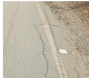
Fotografía 80. Fisuras transversales y longitudinales en la calzada.
