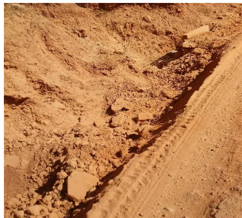
Fotografía 6. Cuneta de Tierra, Totalmente Obstruida, por deslizamiento de talud.
