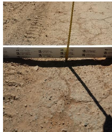
Fotografía 24. Deformación por deficiencia estructural de nivel de gravedad 2 y piel de cocodrilo de nivel de gravedad 2 en la calzada.
