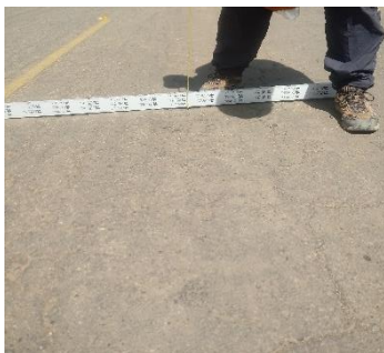
Fotografía 61. Ahuellamiento en la calzada.
