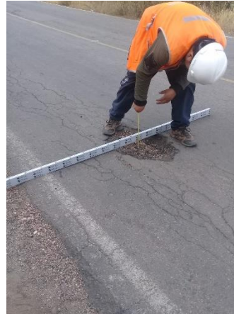
Fotografía 76. Baches de nivel de Gravedad 3, Presencia de deterioro tipo piel de cocodrilo.
