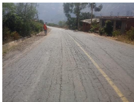
Fotografía 48. F. longitudinales, extendidas en toda la calzada.
