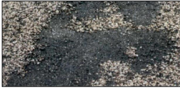
Figura 9. Deterioro Tipo Peladura y Desprendimiento
