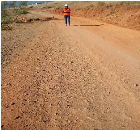
Fotografía 3. Estado de condición malo de la calzada, se puede observar un deterioro de peladura y desprendimiento de nivel de gravedad 3.
