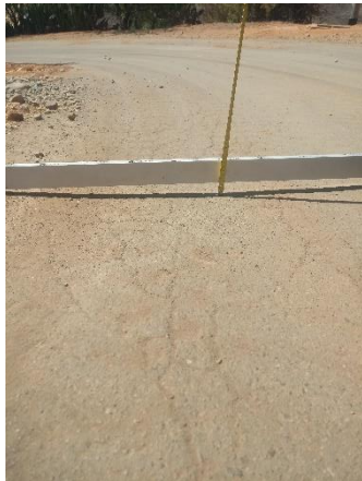
Fotografía 25. Presencia de ahuellamiento en la calzada, también se observan fisuras longitudinales.
