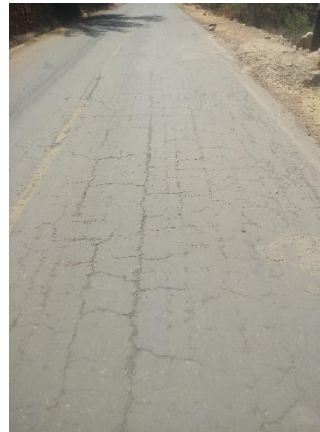
Fotografía 26. Piel de Cocodrilo que se extendida en toda la calzada.
