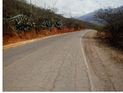
Fotografía 70. Piel de Cocodrilo extendida en el carril derecho.
