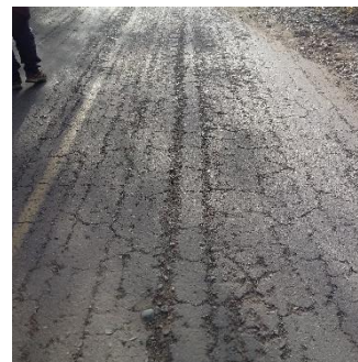
Fotografía 36. Presencia de piel de cocodrilo y fisuras longitudinales y pequeños baches de nivel de gravedad 1 en la calzada.
