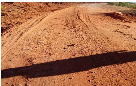
Fotografía 5. Desprendimiento total de la carpeta asfáltica.
