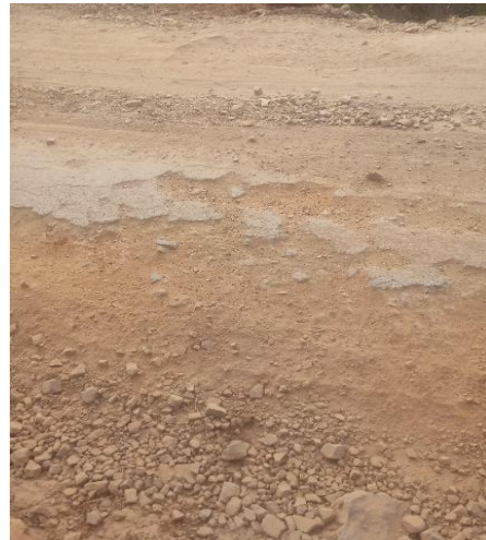
Fotografía 20. Peladura y desprendimiento de la calzada de nivel de gravedad 3.
