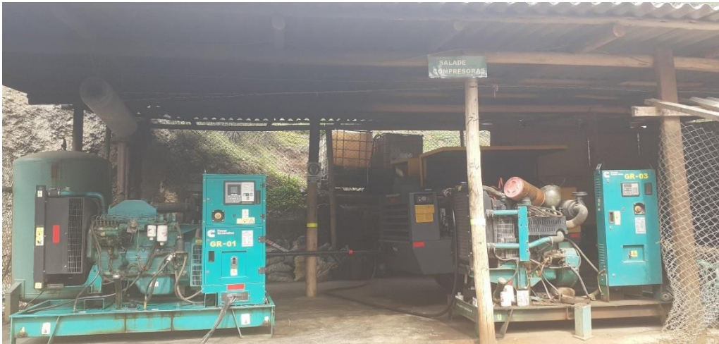
Fuente: MYGABY S.A.C, zona de compresoras, grupos electrógenos, etc.
