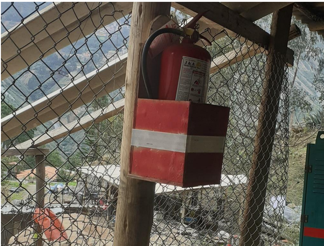
Fuente: MYGABY S.A.C, Señalización de seguridad.
