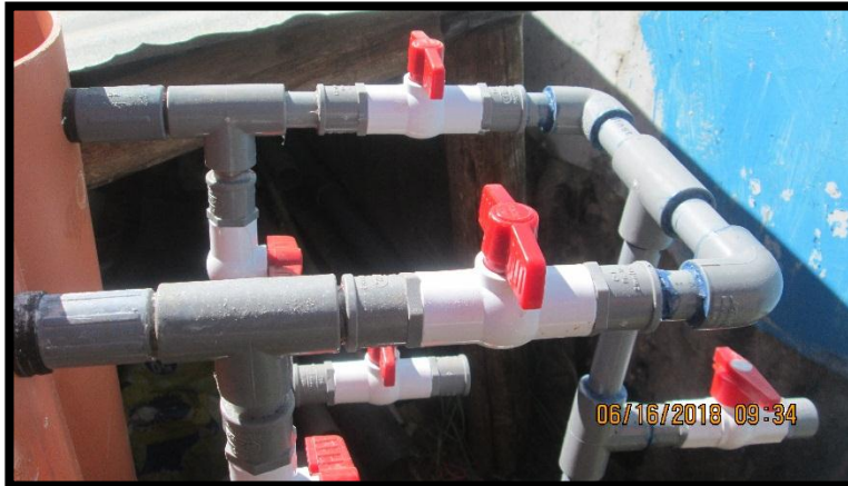
Fotografía 3.15 Sistema repartidor de caudal de los prototipo
