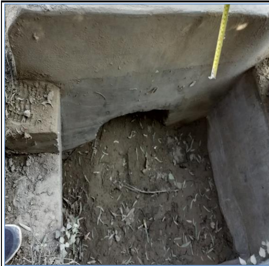
Foto N° 171 24+089 Tajea de piedra 0.40x0.30m, malo
