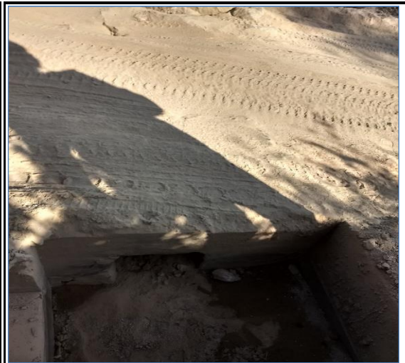
Foto N° 168 23+788 Tajea de piedra 0.40x0.30m, malo
