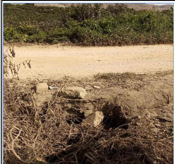
Foto N° 148 20+058 Tajea de piedra 0.40x0.30m, malo
