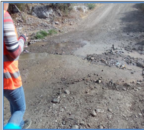
Foto N° 13 0+596 Baden colapsado, malo
