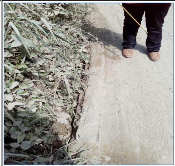
Foto N° 56 6+615 Alcantarilla concreto armado, malo
