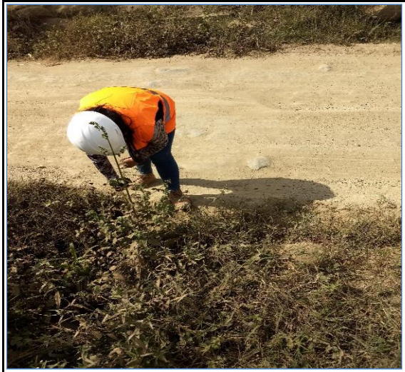
Foto N° 140 19+021 Tajea de piedra 0.40x0.40m, malo
