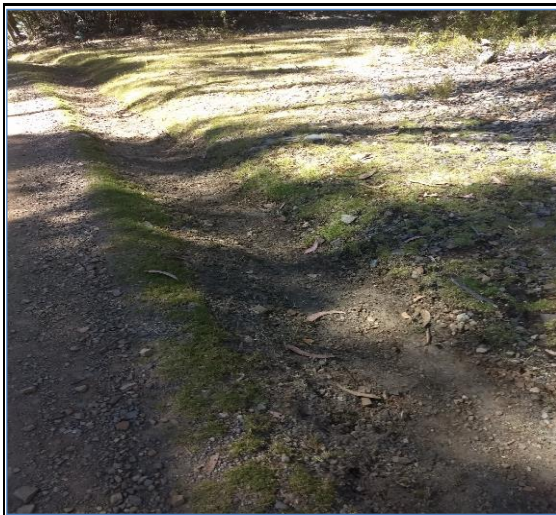
Foto N° 61 4+015 Inicio de cuneta lado izquierdo, bueno
