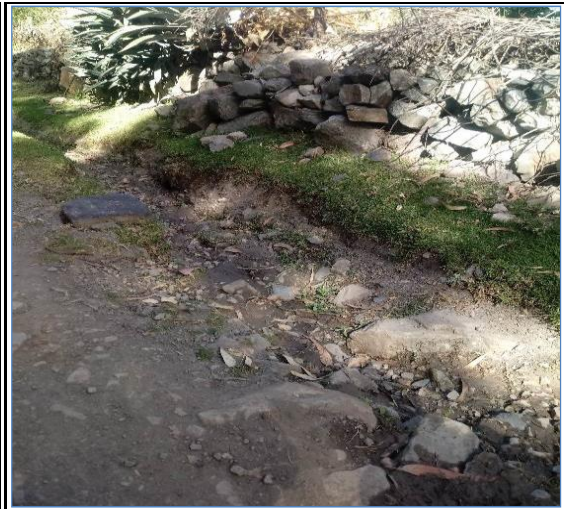
Foto N° 14 0+585 Fin de cuneta lado izquierdo, regular
