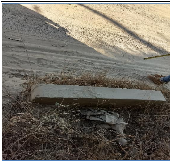
Foto N° 185 25+817 Tajea de piedra 0.40*0.30m, malo
