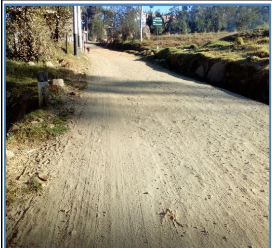
Foto N° 20 3+702 Hito Km 4+000 lado izquierdo, regular
