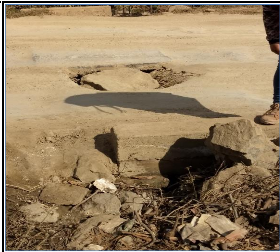
Foto N° 138 18+885 Alcantarilla de concreto armado 0.60x0.40m, malo
