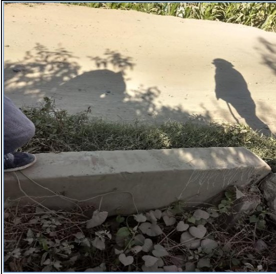
Foto N° 175 24+750 Tajera de piedra 0.40x0.30m, malo
