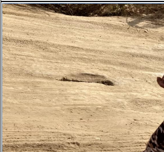
Foto N° 137 18+846 Alcantarilla de concreto armado 0.60x0.40m, malo
