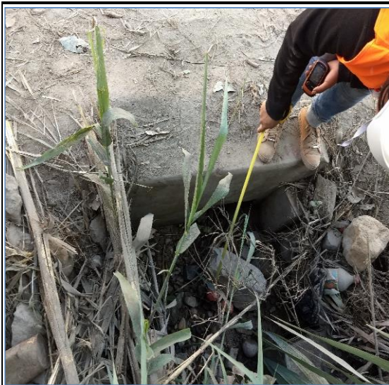
Foto N° 179 25+030 Tajera de piedra 0.40*0.30m, malo
