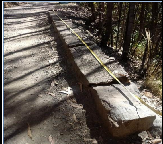
Foto N° 22 1+427 Muro seco de piedra 7.50x0.40x1.20m, bueno
