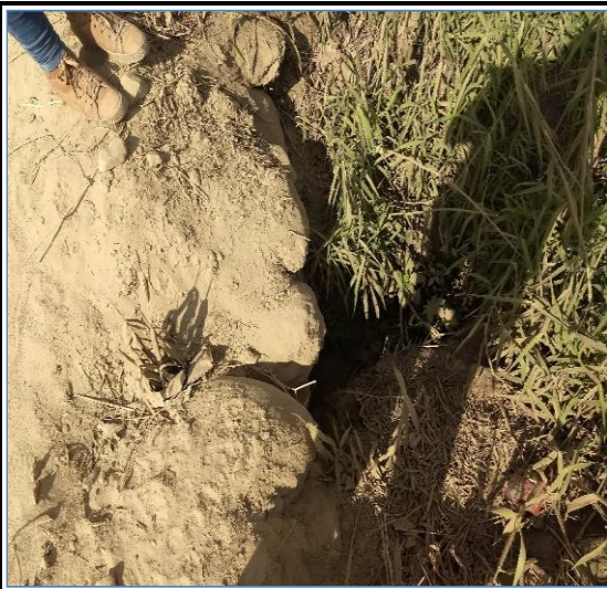
Foto N° 131 17+840 Tajea de piedra 0.40x0.40m, malo
