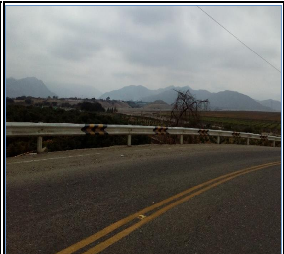
Foto N° 12 0+833 Inicio de guardavias lado izquierdo, bueno
