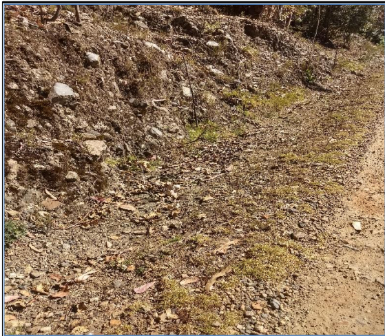
Foto N° 69 4+393 Fin de cuneta lado izquierdo, regular
