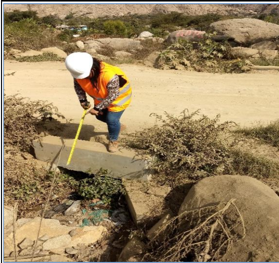
Foto N° 141 19+273 Alcantarilla de concreto armado 0.90x0.50m, malo
