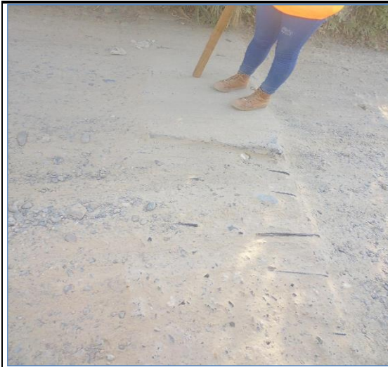
Foto N° 81 10+072 Alcantarilla concreto, malo
