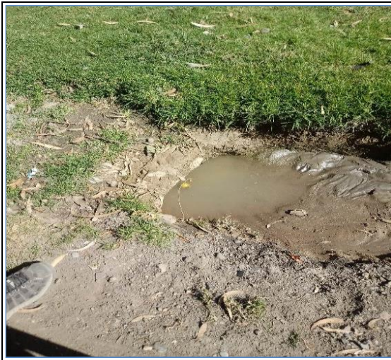
Foto N° 13 0+553 Tajea de piedra 0.40x0.30m, malo
