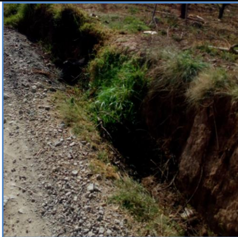
Foto N° 47 2+798 Inicio de cuneta lado izquierdo; fin de cuneta lado derecho, regular
