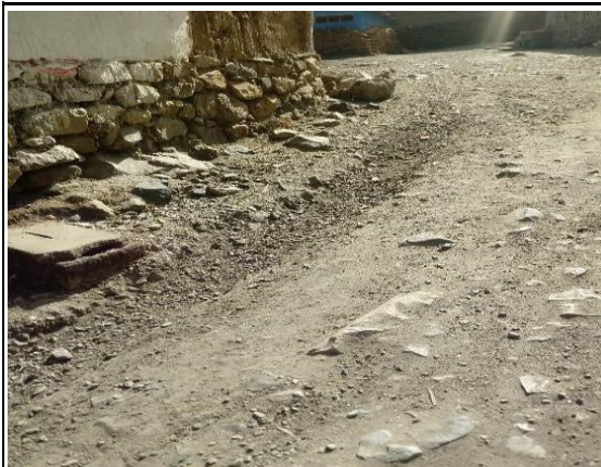
Foto N° 5 0+251 Fin de cuneta lado izquierdo, regular
