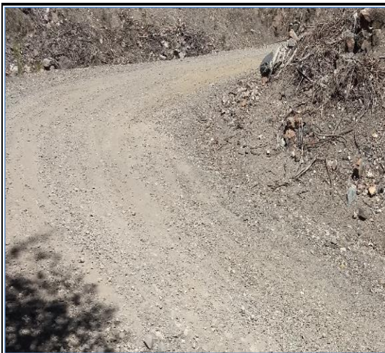
Foto N° 39 2+824 Fin de cuneta lado derecho, regular
