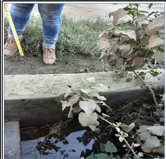
Foto N° 174 24+669 Tajea de piedra 0.40x0.40m, malo
