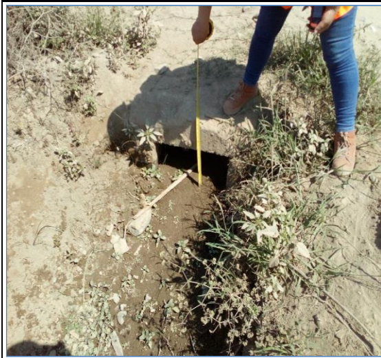
Foto N° 73 9+131 Tajea de concreto armado 0.50x0.30m, malo
