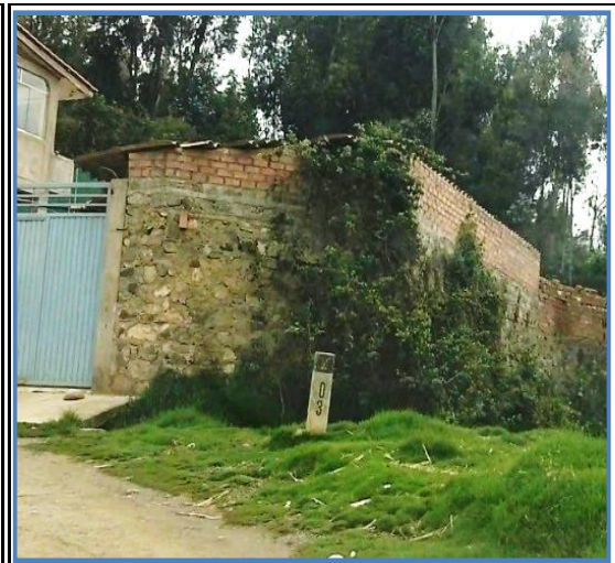
Foto N° 14 2+972 Hito Km 3+000 lado derecho, malo
