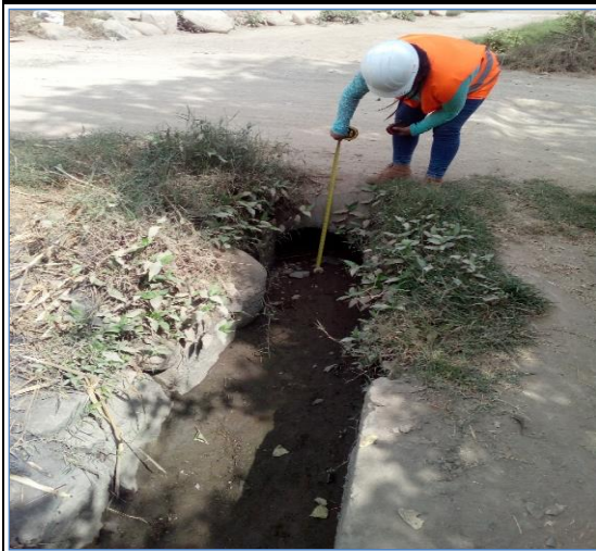
Foto N° 117 15+946 Alcantarilla de concreto armado 0.60x0.40m, malo
