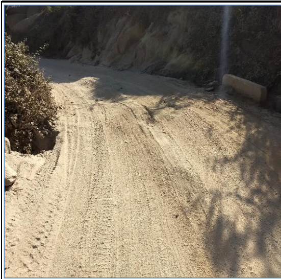
Foto N° 173 24+561 Tajea de piedra 0.40x0.30m, malo
