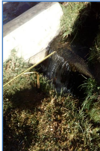
Foto N° 22 3+999 Tajea de concreto ciclópeo de 0.50mx0.60m, bueno
