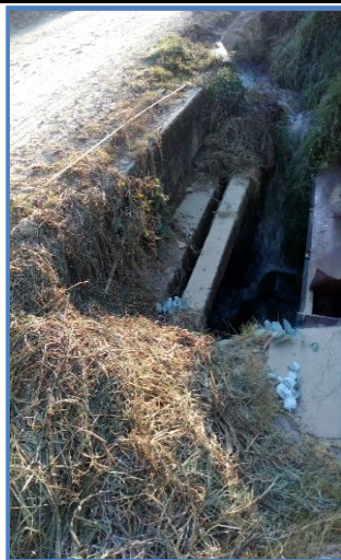
Foto N° 9 2+047 Alcantarilla de mampostería de piedra 2.70mx1.50m, regular
