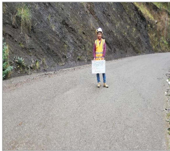
Fotografía 46: Falla: Peladuras y desprendimientos, gravedad 3 – km 1+920. Fuente: propia.
