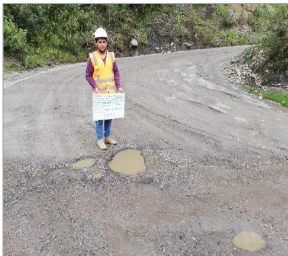
Fotografía 55: Falla: Baches (huecos), gravedad 2 – km 2+840. Fuente: propia.
