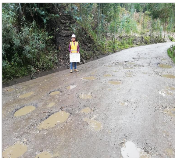
Fotografía 49: Falla: Baches (huecos), gravedad 3 – km 2+220. Fuente: propia.
