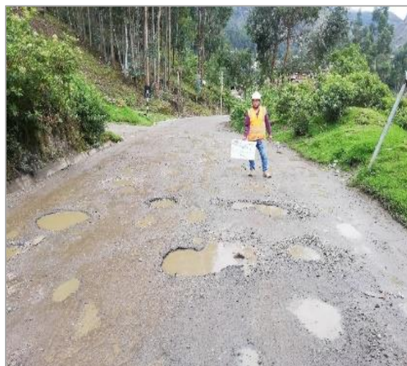
Fotografía 58: Falla: Baches (huecos), gravedad 3 – km 3+080. Fuente: propia.
