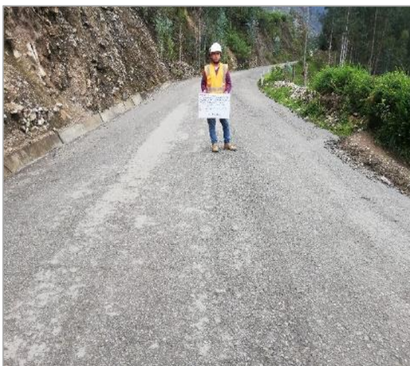
Fotografía 57: Falla: Peladuras y desprendimientos, gravedad 3 – km 2+920. Fuente: propia.
