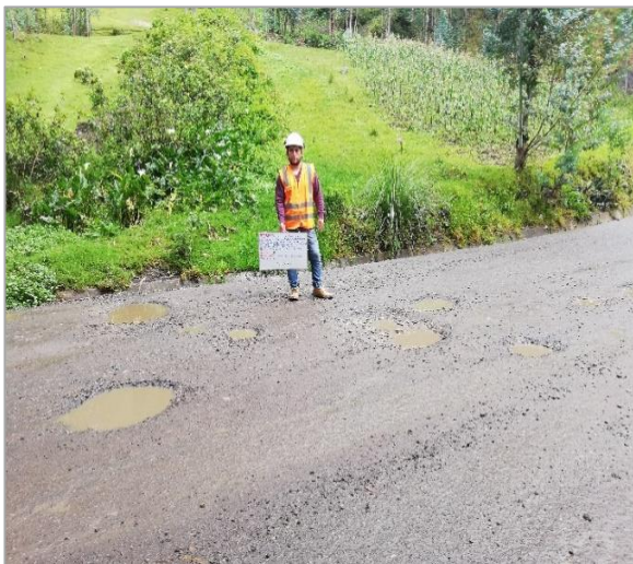
Fotografía 45: Falla: Baches (huecos), gravedad 2 – km 1+800. Fuente: propia.
