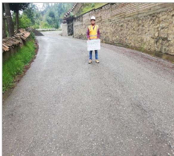
Fotografía 52: Falla: Peladuras y desprendimientos, gravedad 3 – km 2+580. Fuente: propia.
