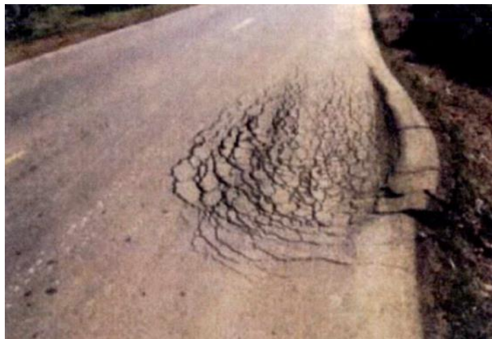
Fotografía 3: Falla encontrada para el parchado profundo en la calzada. Fuente: Manual de Carreteras: Mantenimiento o Conservación Vial (MTC 2018).
