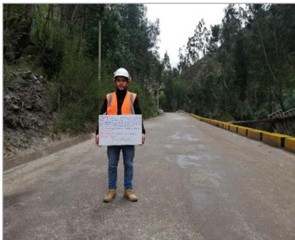
Fotografía 27: Falla: Peladuras y desprendimientos, gravedad 3 – km 0+060. Fuente: propia.
