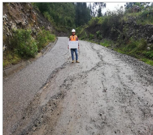
Fotografía 34: Falla: Ahuellamiento, gravedad 3 – km 0+770 Fuente: propia.
