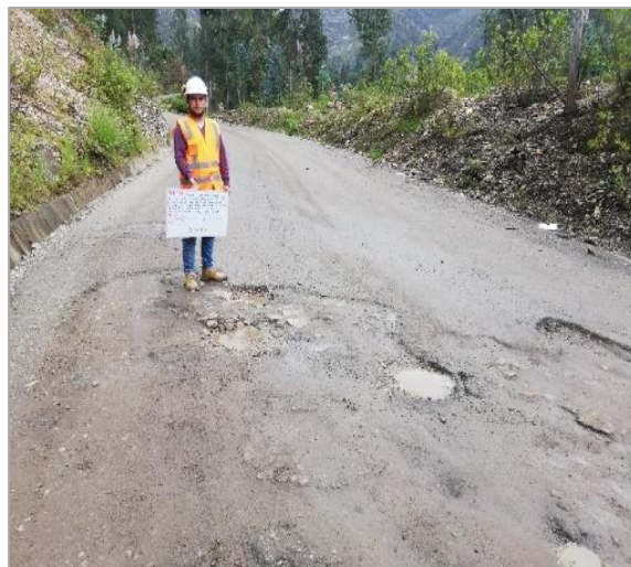
Fotografía 56: Falla: Baches (huecos), gravedad 2 – km 2+880. Fuente: propia.
