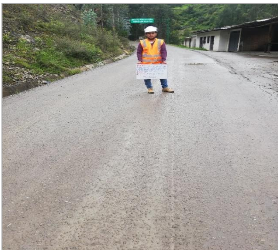
Fotografía 43: Falla: Peladuras y desprendimientos, gravedad 3 – km 1+680. Fuente: propia.
