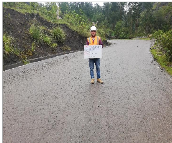
Fotografía 32: Falla: Peladuras y desprendimientos, gravedad 3 – km 0+540. Fuente: propia.
