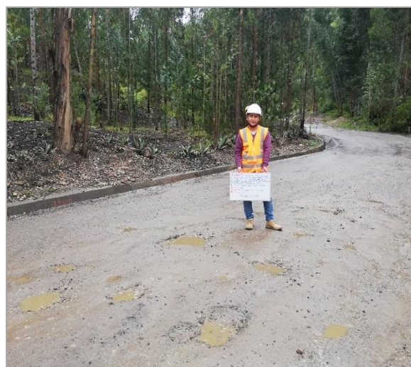
Fotografía 38: Falla: Baches (huecos), gravedad 2 – km 1+080. Fuente: propia.
