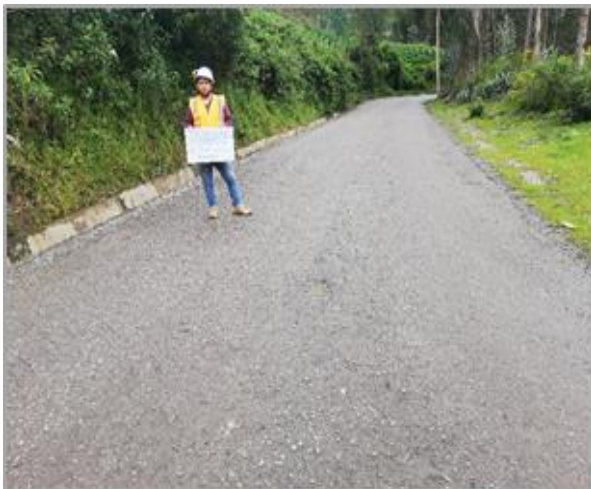
Fotografía 47: Falla: Peladuras y desprendimientos, gravedad 3 – km 2+010. Fuente: propia.
