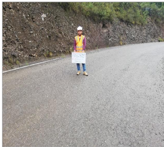
Fotografía 36: Peladuras y desprendimientos, gravedad 3 – km 0+880. Fuente: propia.
