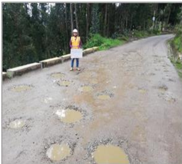
Fotografía 51: Falla: Baches (huecos), gravedad 3 – km 2+500. Fuente: propia.
