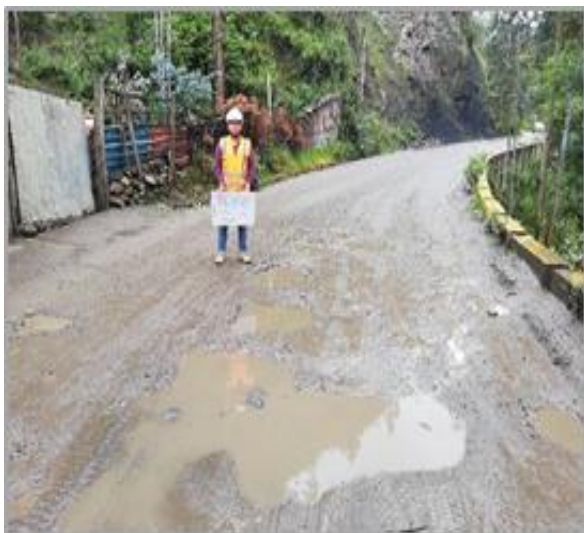
Fotografía 41: Falla: Baches (huecos), gravedad 3 – km 1+385. Fuente: propia.
