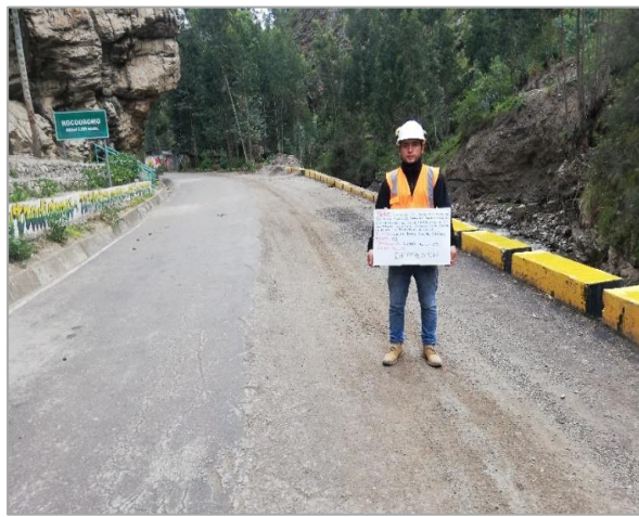
Fotografía 28: Falla: Deformación por deficiencia estructural, gravedad 3 – km 0+100. Fuente: propia.
