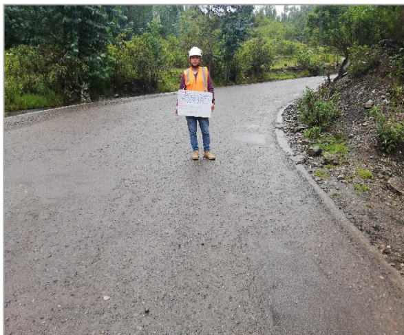
Fotografía 31: Falla: Peladuras y desprendimientos, gravedad 3 – km 0+440. Fuente: propia.
