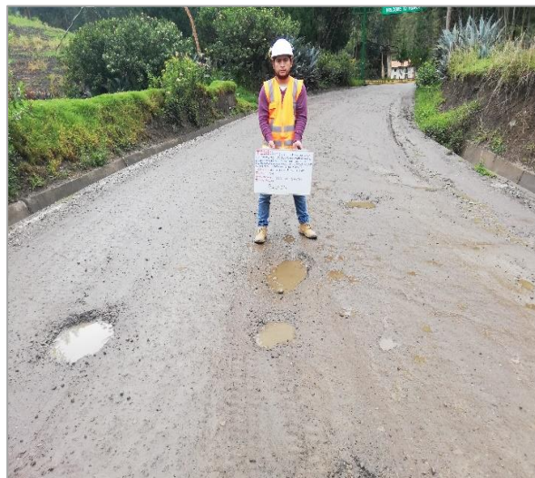
Fotografía 40: Falla: Baches (huecos), gravedad 2 – km 1+370. Fuente: propia.
