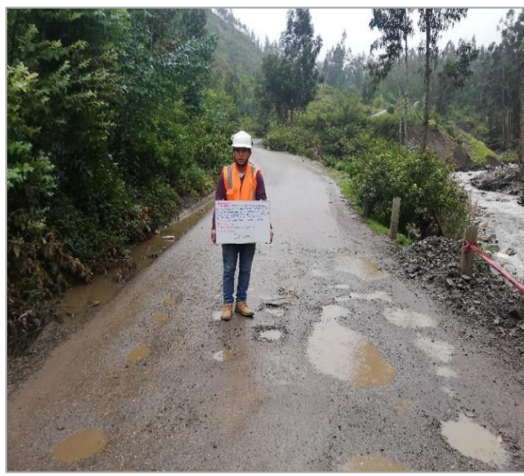
Fotografía 30: Falla: Baches (huecos), gravedad 3 – km 0+380. Fuente: propia.
