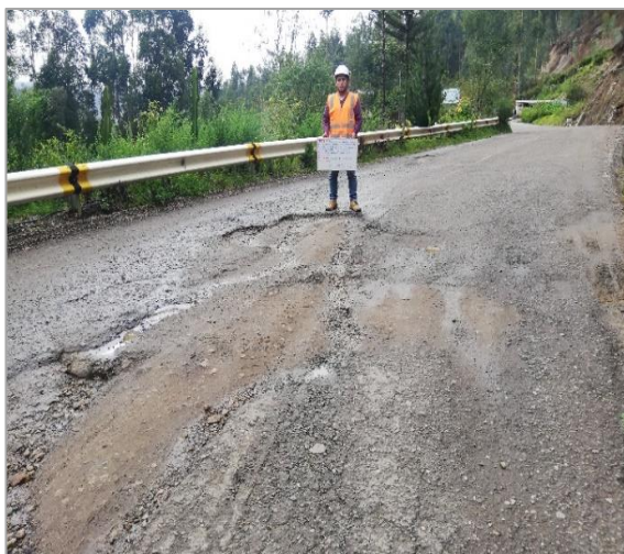
Fotografía 53: Falla: Ahuellamiento, gravedad 3 – km 2+580. Fuente: propia.
