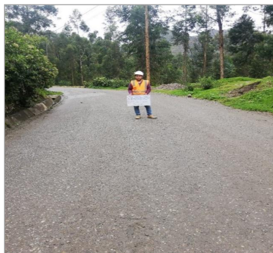
Fotografía 50: Falla: Peladuras y desprendimientos, gravedad 3 – km 2+280. Fuente: propia.
