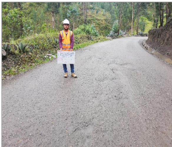
Fotografía 39: Falla: Peladuras y desprendimientos, gravedad 3 – km 1+260. Fuente: propia.
