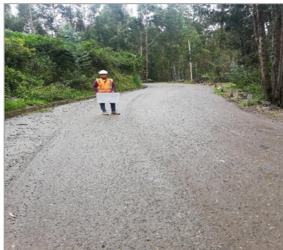
Fotografía 48: Falla: Peladuras y desprendimientos, gravedad 3 – km 2+100. Fuente: propia.
