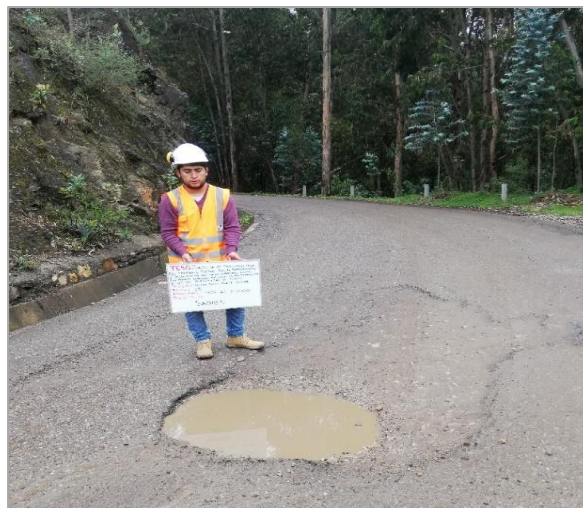
Fotografía 44: Falla: Baches (huecos), gravedad 3 – km 1+750. Fuente: propia.
