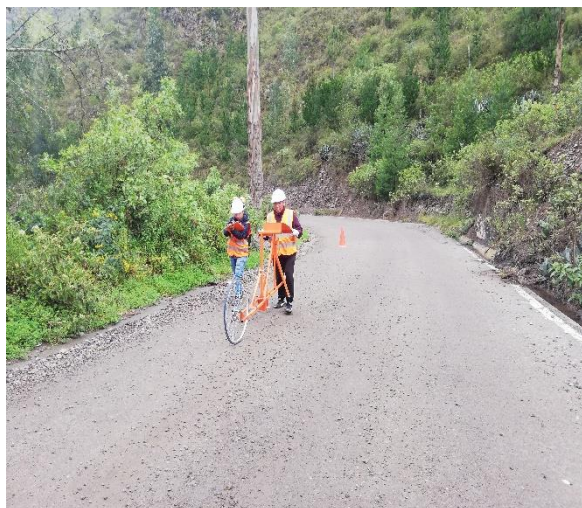
Fotografía 37: Peladura y desprendimiento, gravedad 3 – km 0+920. Fuente: propia.
