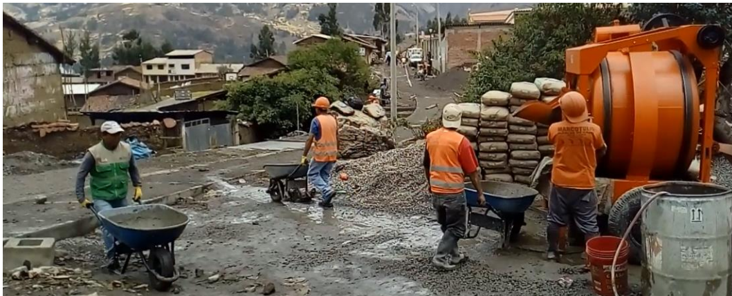
Fotografía 6: se muestra la cuadrilla de la mezcladora tolva de 18p3 de capacidad, al momento del traslado de la mezcla hacia los paños del pavimento.
