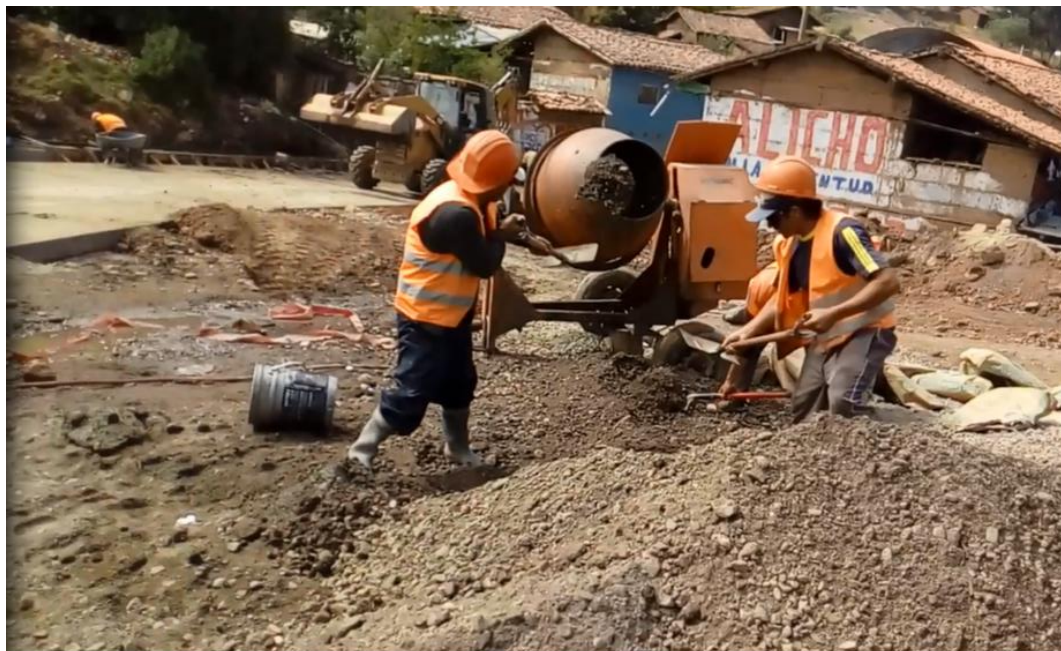
Fotografía 4: se muestra la cuadrilla de la mezcladora trompo de 11p3 de capacidad, al momento del llenado de los agregados.
