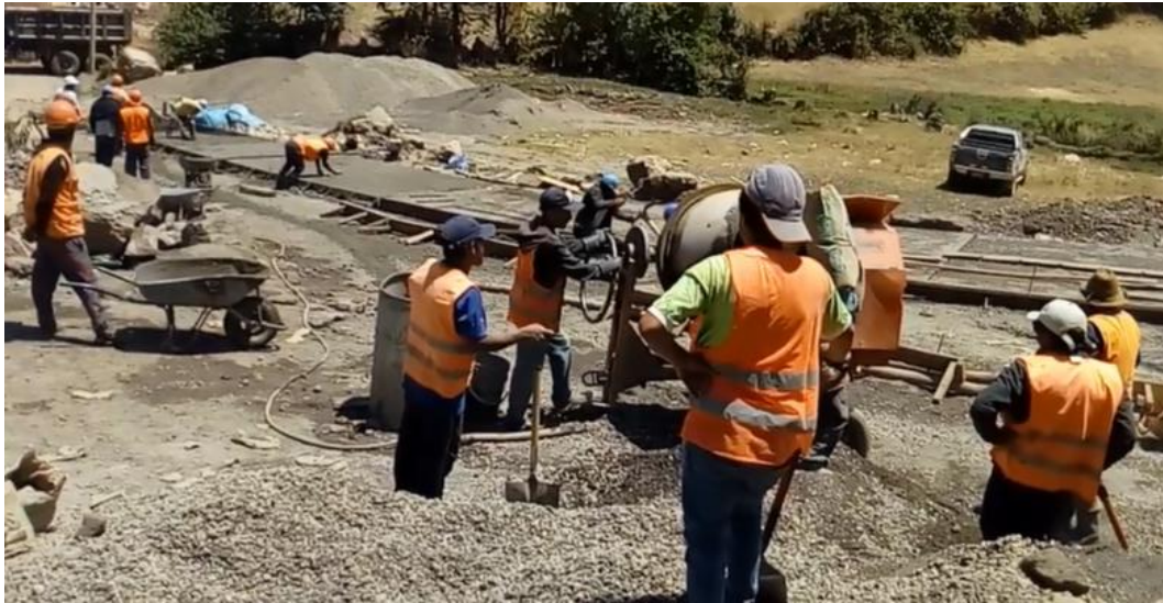
Fotografía 3: se muestra la cuadrilla de la mezcladora trompo de 11p3 de capacidad, al momento del llenado del cemento a la tuba.
