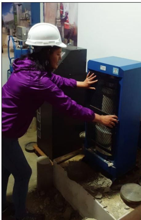
Asegurando la puerta de la maquina de compresión
