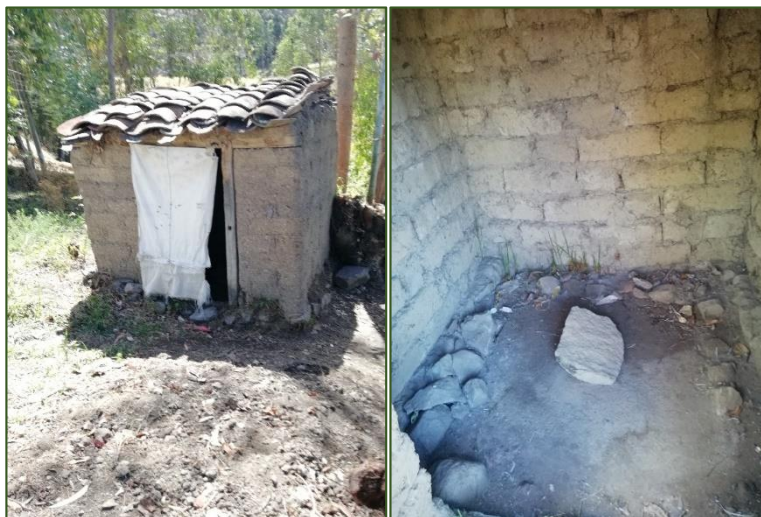
Figura 20. Pozo ciego en la vivienda N° 09 – Santa Rosa de Pacuash
