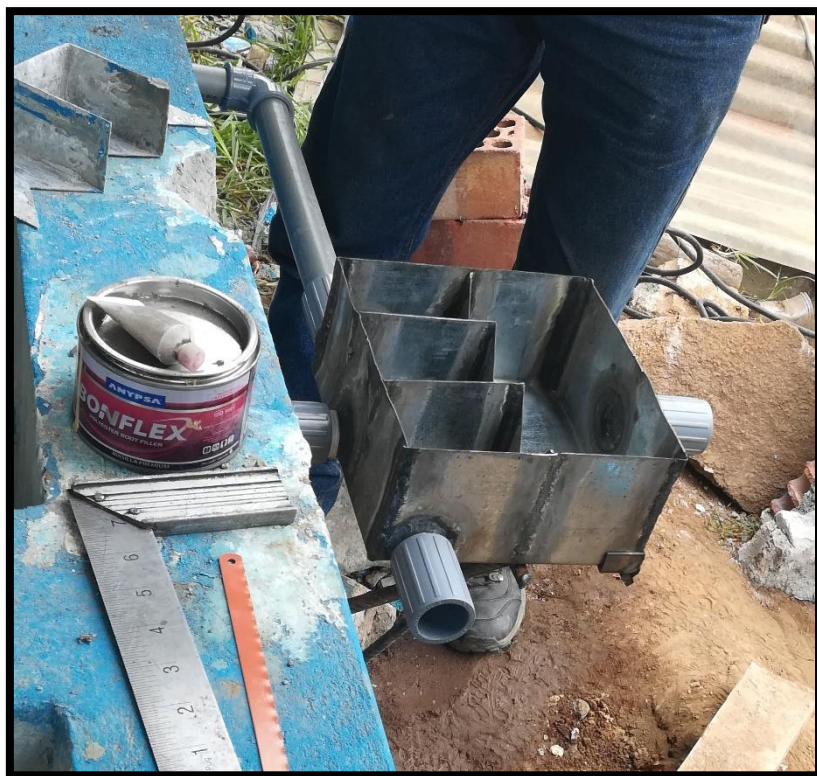
Fotografía N°9: Colocación de vertederos de plancha galvanizada en el ingreso de los filtros percoladores.
