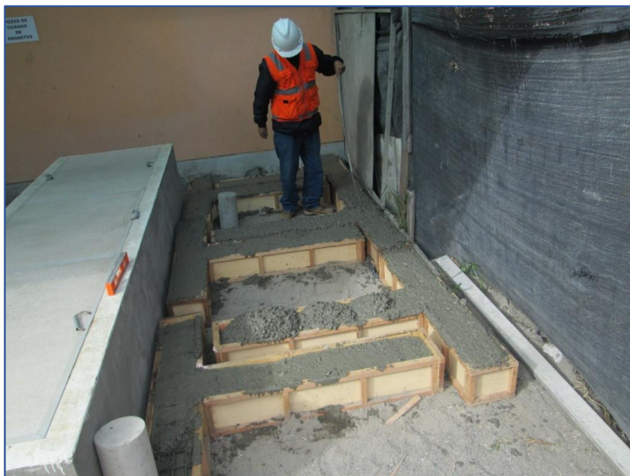
Figura 115: Vaciado y compactado (chuceo) de la última capa del concreto de los especímenes. Fuente: Elaboración propia.
