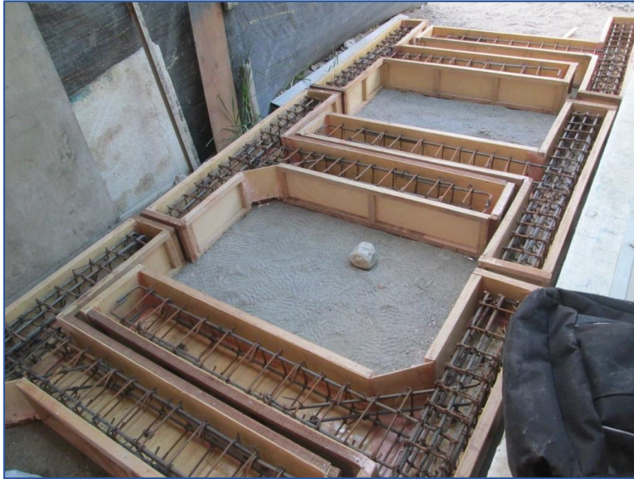
Figura 103: Distribución final de los encofrados y la armadura de los especímenes. Fuente: Elaboración propia.
