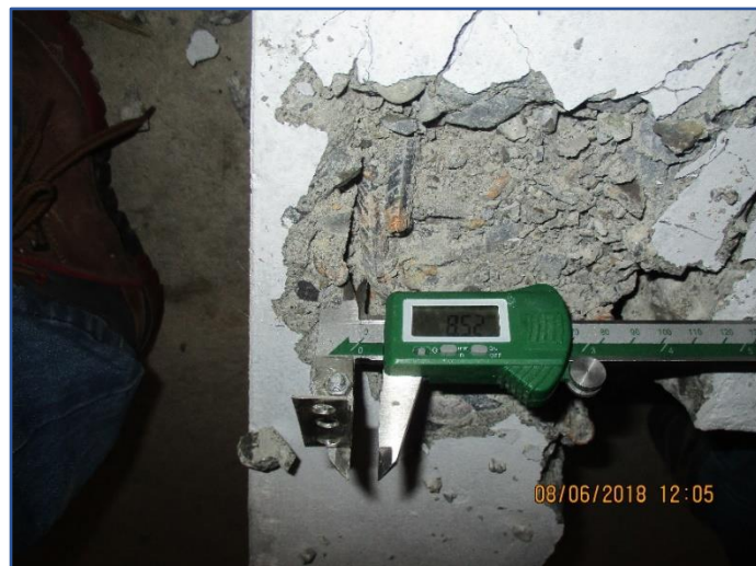
Figura 129: Registro y medición del aplastamiento del concreto interior al gancho estándar. Fuente: Elaboración propia.
