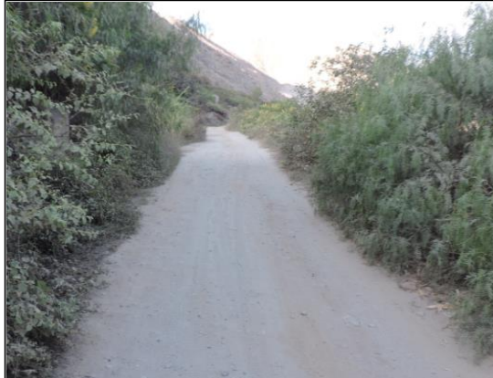
Desgaste del afirmado de la carpeta de rodadura (Progresiva: Km 8+000).
