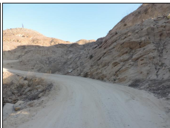
Desgaste del afirmado de la carpeta de rodadura y fin de zona crítica (Riesgo flujo de detritos y derrumbes), (Progresiva: Km 3+000).
