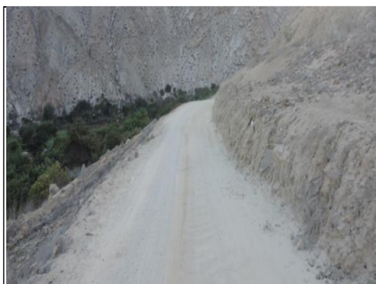
Desgaste del afirmado de la carpeta de rodadura con daños de encalaminado (L= 50m), (Progresiva: Km 3+750).
