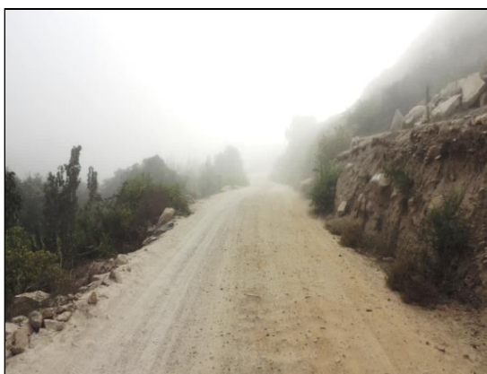
Desgaste del afirmado de la carpeta de rodadura (Progresiva: Km 1+750).
