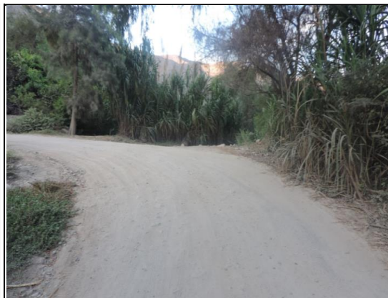
Desgaste del afirmado de la carpeta de rodadura (Progresiva: Km 7+500).
