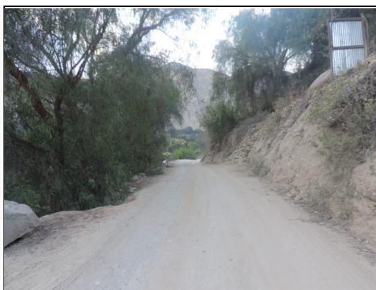
Desgaste del afirmado de la carpeta de rodadura (Progresiva: Km 7+000).
