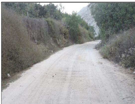
Desgaste del afirmado de la carpeta de rodadura con daños de encalaminado (L=70m), (Progresiva: Km 6+140).
