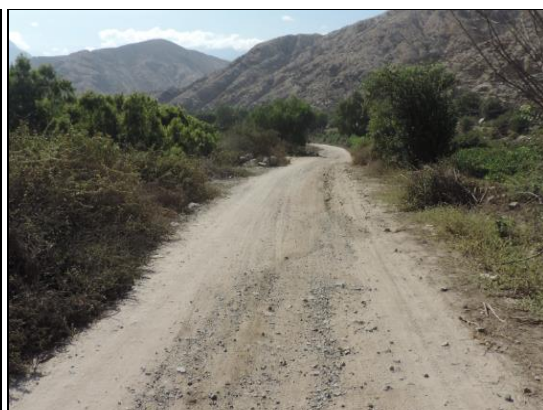
Desgaste del afirmado de la carpeta de rodadura con daños de erosión (L=150m), (Progresiva: Km 5+000).
