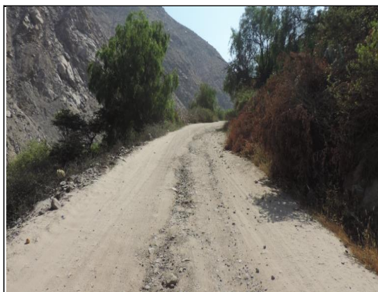
Desgaste del afirmado de la carpeta de rodadura con daños de erosión (L=200m), (Progresiva: Km 6+000).
