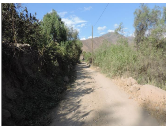
Desgaste del afirmado de la carpeta de rodadura (Progresiva: Km 10+750).
