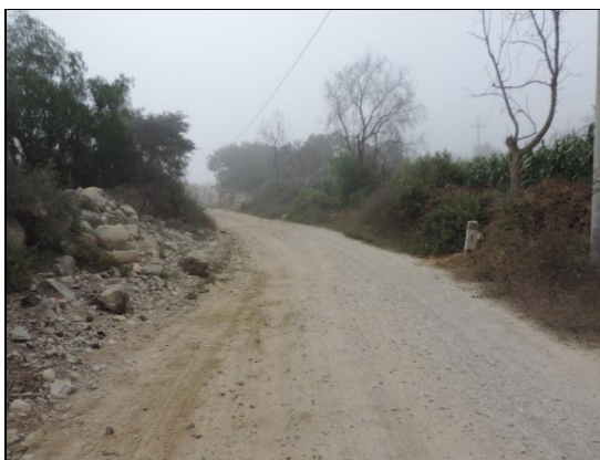
Desgaste del afirmado de la carpeta de rodadura (Progresiva: Km 1+000).
