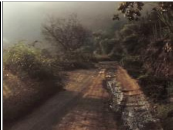
Desgaste del afirmado de la carpeta de rodadura y ésta presenta daños de erosión (L=100m), (Progresiva: Km 8+640).
