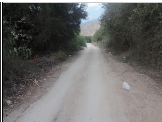
Desgaste del afirmado de la carpeta de rodadura (Progresiva: Km 4+750).
