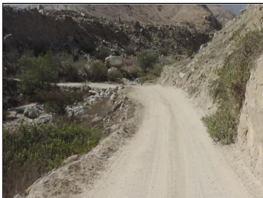
Desgaste del afirmado de la carpeta de rodadura (Progresiva: Km 4+000).
