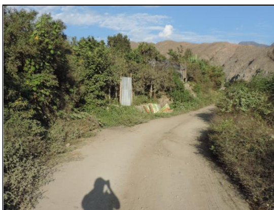
Desgaste del afirmado de la carpeta de rodadura (Progresiva: Km 9+000).
