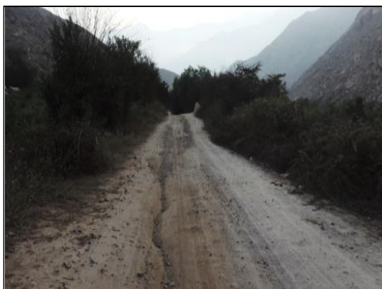
Desgaste del afirmado de la carpeta de rodadura y ésta presenta daños de erosión (Progresiva: Km 5+080).
