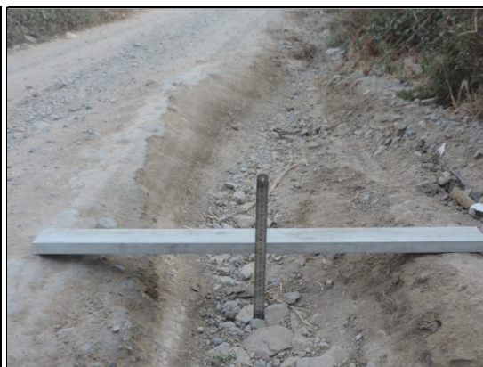
Desgaste del afirmado de la carpeta de rodadura y ésta presenta daños de erosión (L=50m), (Progresiva: Km 10+430).
