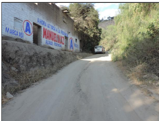
Desgaste del afirmado de la carpeta de rodadura con daños de erosión (L=150m), (Progresiva: Km 10+000).
