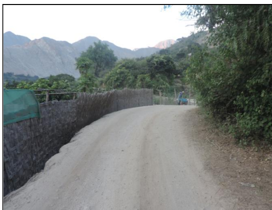
Desgaste del afirmado de la carpeta de rodadura (Progresiva: Km 6+500).
