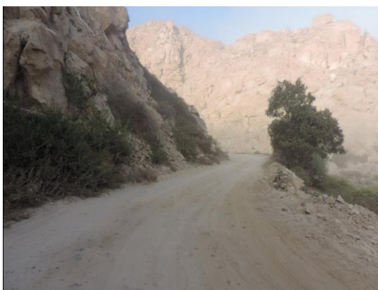
Curva pronunciada. Desgaste del afirmado de la carpeta de rodadura (Progresiva: Km 2+000).
