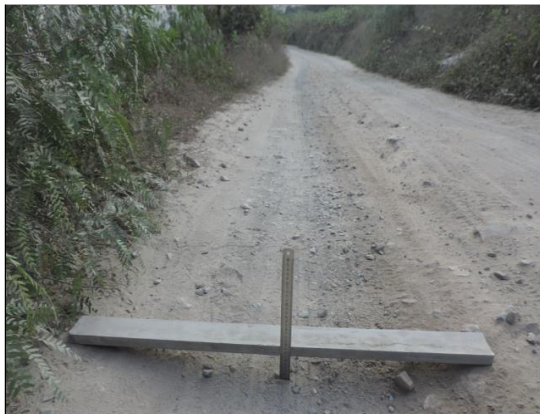
Desgaste del afirmado de la carpeta de rodadura y ésta presenta daños de ahuellamiento (L=50m), (Progresiva: Km 8+590).
