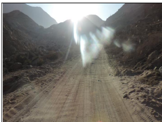
Desgaste del afirmado de la carpeta de rodadura con daños de encalaminado (L=200m), (Progresiva: Km 2+750).
