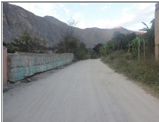
Desgaste del afirmado de la carpeta de rodadura (Progresiva: Km 7+250).
