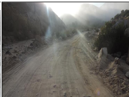
Desgaste del afirmado de la carpeta de rodadura (Progresiva: Km 2+250).
