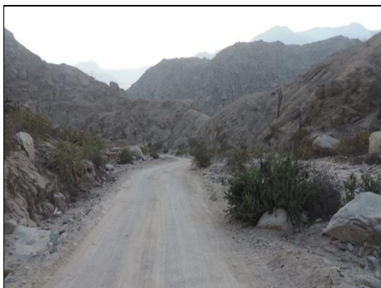
Inicio de zona crítica. Riesgo flujo de detritos y derrumbes (Progresiva: Km 2+080).
