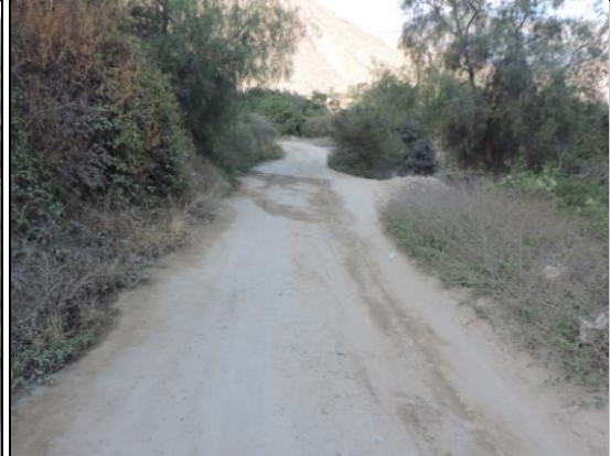
Desgaste del afirmado de la carpeta de rodadura con daños de erosión (L=100m), (Progresiva: Km 8+250).
