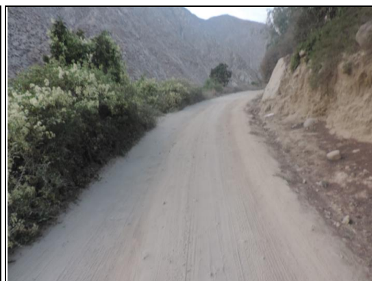
Desgaste del afirmado de la carpeta de rodadura (Progresiva: Km 5+750).
