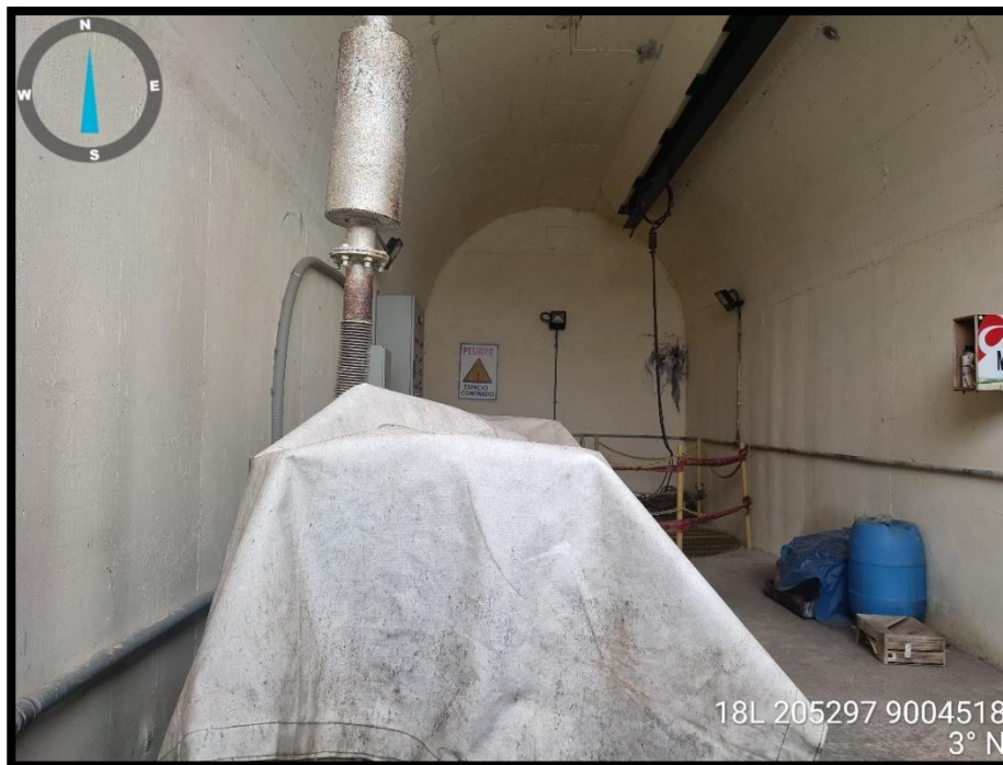
Fotografía 03: Camara de mandos del sistema de regulacion de la Laguna Parón
