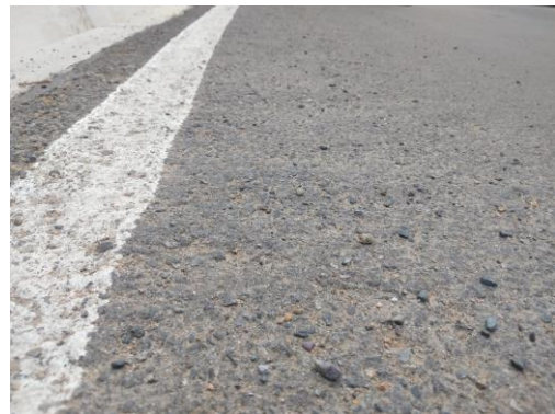
Foto 12: Fallas tipo "B" "Pérdida de agregados"
