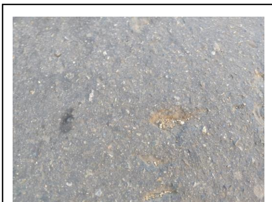
Foto 23: Fallas tipo "B" "Pérdida de agregados"
