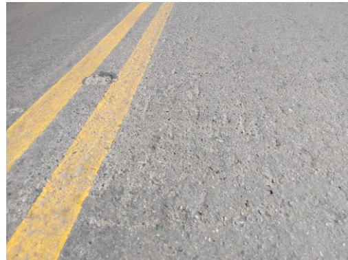
Foto 16: Fallas tipo "B" "Pérdida de agregados"
