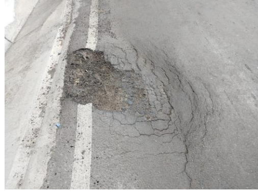
Foto 14: Depresiones o hundimientos longitudinales
