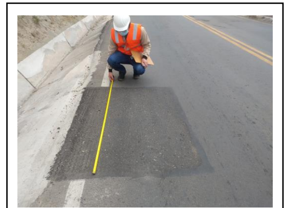
Foto 06: Fallas tipo "A" Bacheos o Parcheos
