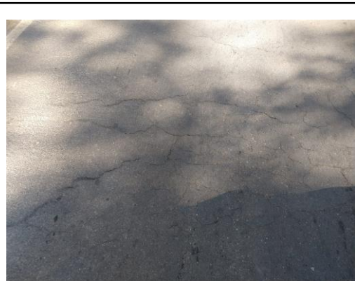
Foto 18: Fallas tipo "A" Fisuras piel de cocodrilo
