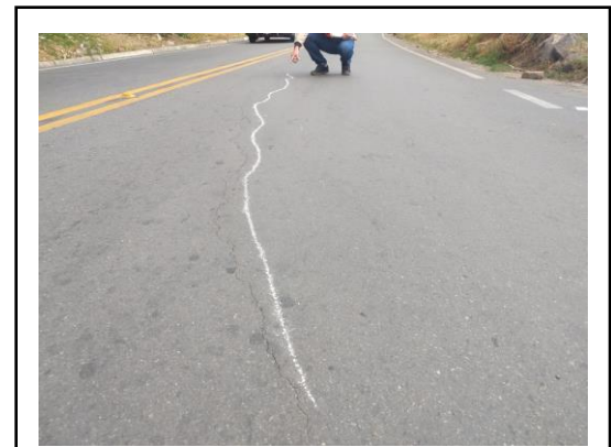
Foto 04: Fallas tipo "A" fisuras longitudinales
