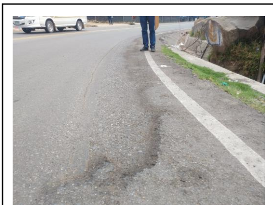
Foto 05: Fallas tipo "A" "depresiones o hundimientos transversales
