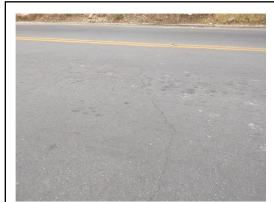
Foto 32: Fallas tipo "B" Fisuras parabólicas
