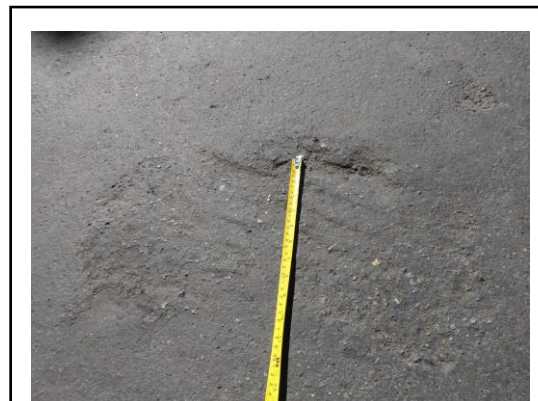
Foto 24: Fallas tipo "A" "Bacheos o Parcheos"
