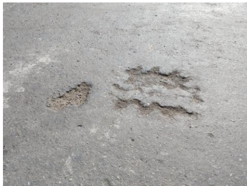
Foto 15: Fallas tipo "A" "Bacheos o Parcheos"
