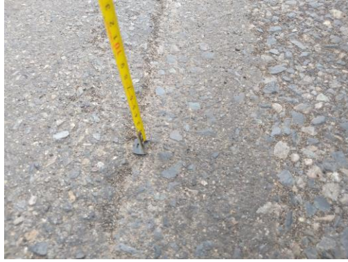
Foto 07: Fallas tipo "A" "depresiones o hundimientos transversales"
