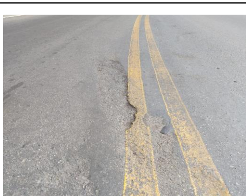
Foto 17: Fallas tipo "B" "Depresiones o hundimientos longitudinales"
