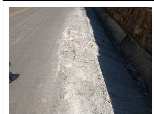
Foto 20: Fallas tipo "B" Desintegración de bordes del pavimento
