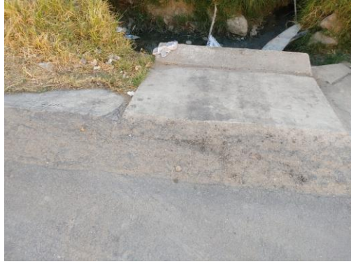
Foto 13: Fallas tipo "A" "Bacheos o Parcheos"
