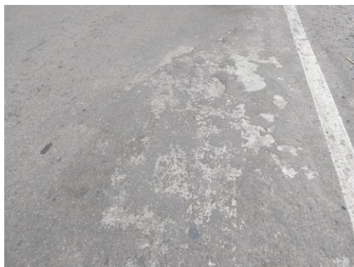
Foto 11: Fallas tipo "B" "Pérdida de la película ligante"
