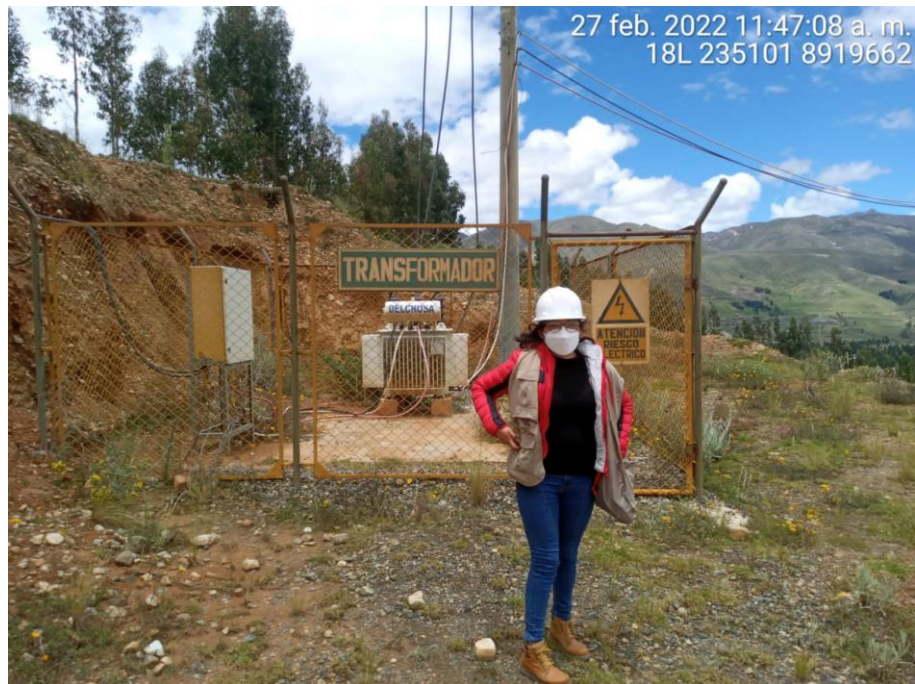
Área de generador eléctrico de la Corporación Minera Toma La Mano.
