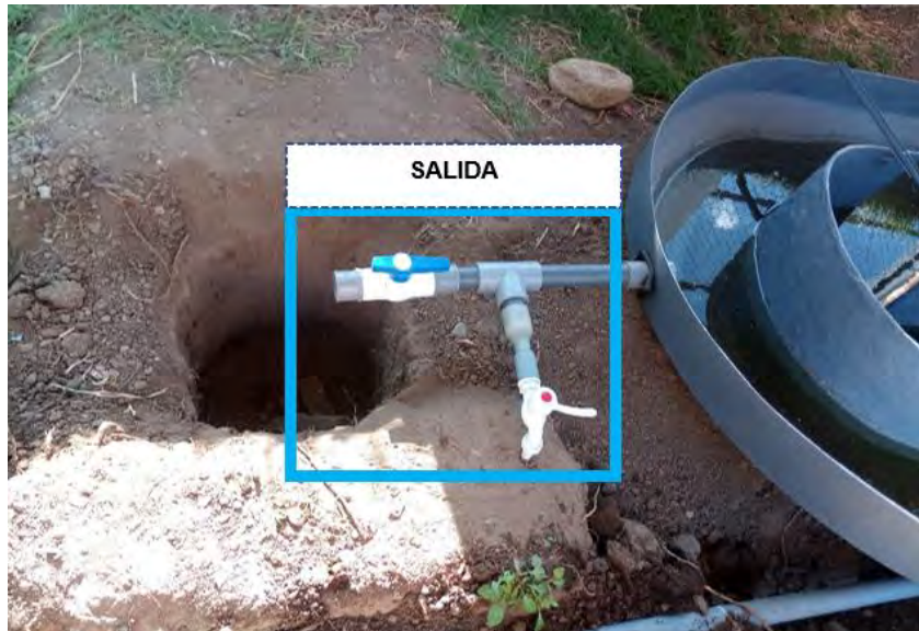
Imagen 17. Salida al reactor
