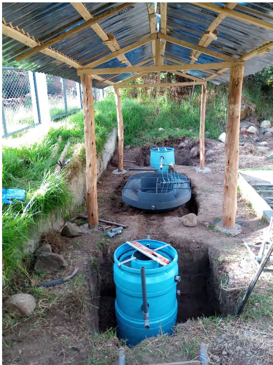
Fotografía 42. Instalación general de la PTAR ICS
