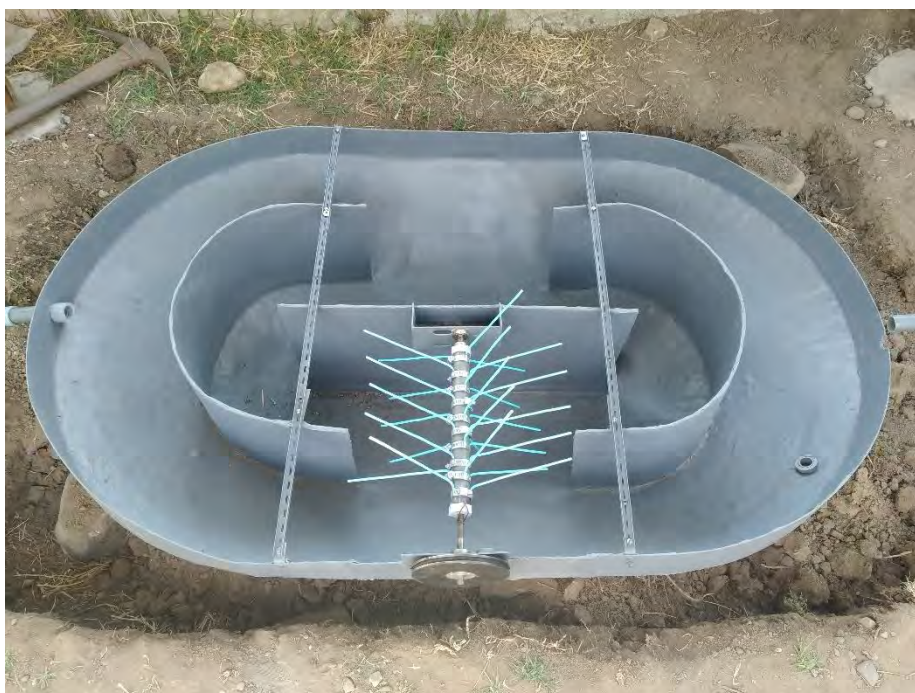
Fotografía 41. Instalación del tratamiento secundario tipo carrusel
