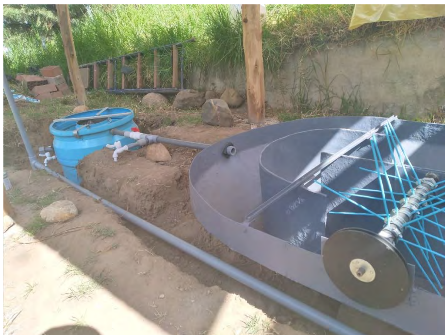
Fotografía 48. Tubería de recirculación de lodos
