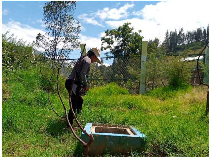
Fotografía 3. Cámara de repartición de caudal
