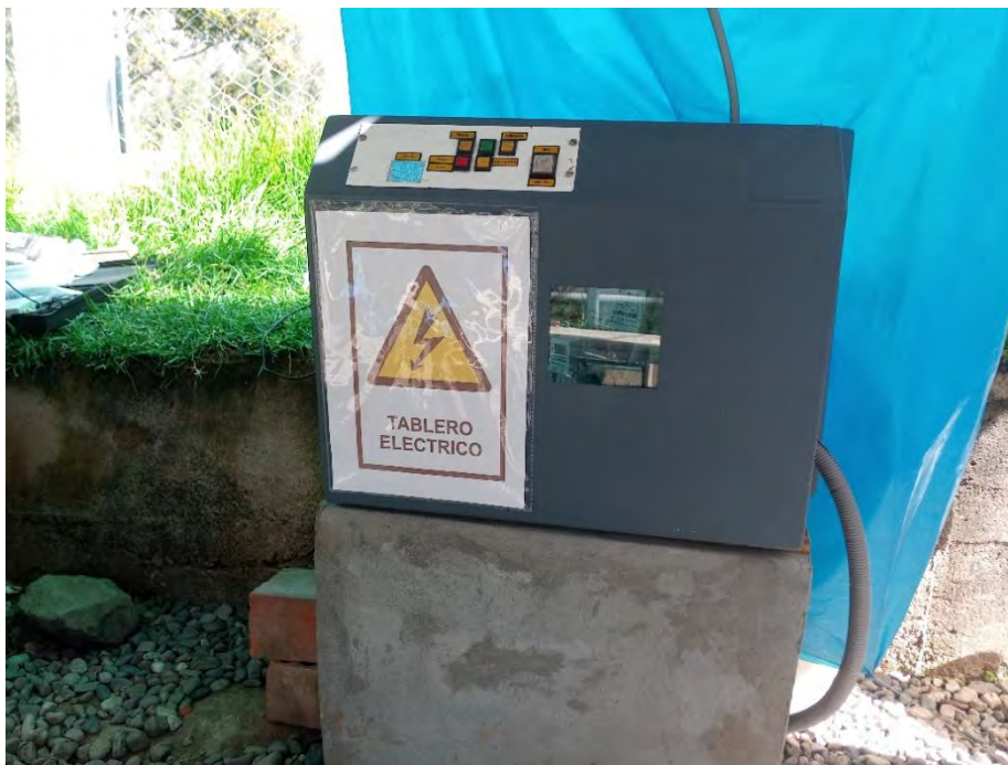
Fotografía 61. Tablero general eléctrico
