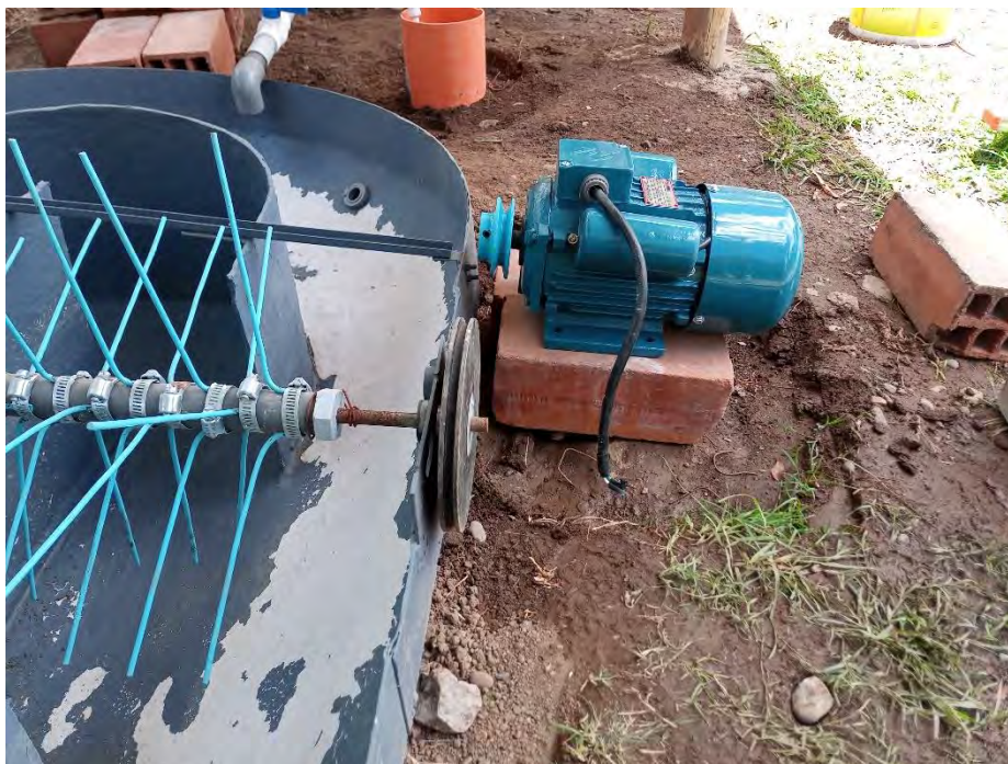
Fotografía 55. Ubicación del motor eléctrico
