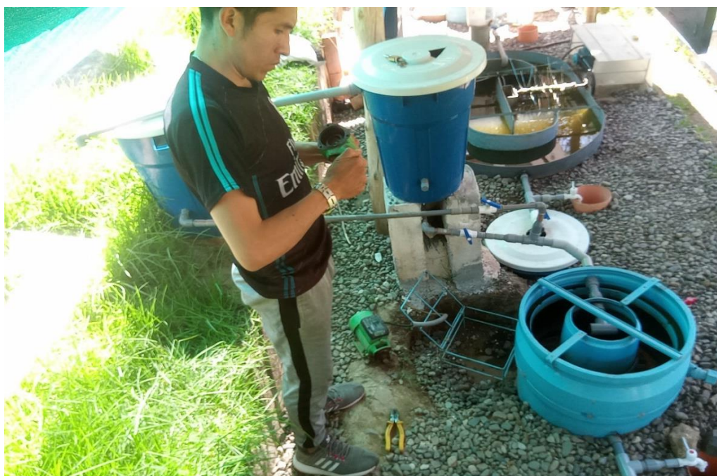
Fotografía 87. Engrasado de la motobomba para mejorar el bombeo del agua que ingresa al decantador circular tipo troncocónico doble.
