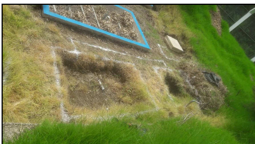
Fotografía 9. Vista de trazo y replantado para la instalación del decantador circular tipo troncocónico doble.
