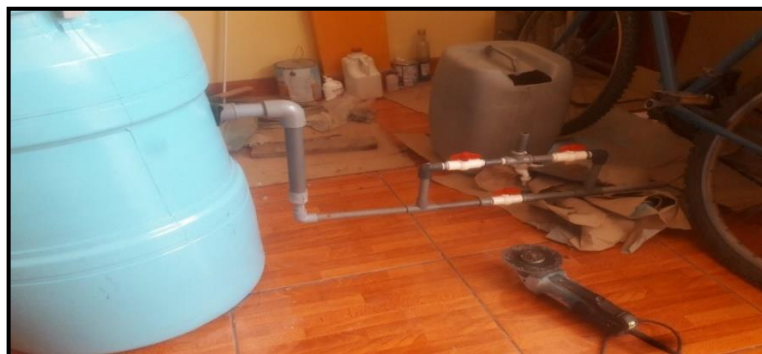
Fotografía 8. Tubería de salida del decantador circular tipo troncocónico doble al Hipoclorador tipo Venturi.
