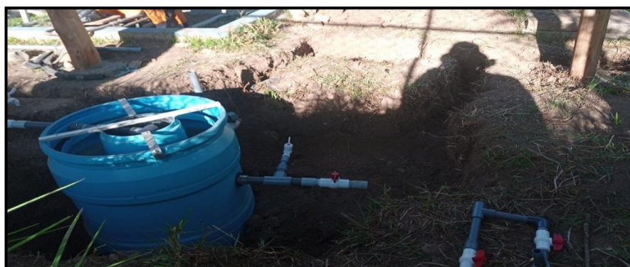
Fotografía 14. Instalación de la tubería de salida del decantador circular tipo troncocónico doble.
