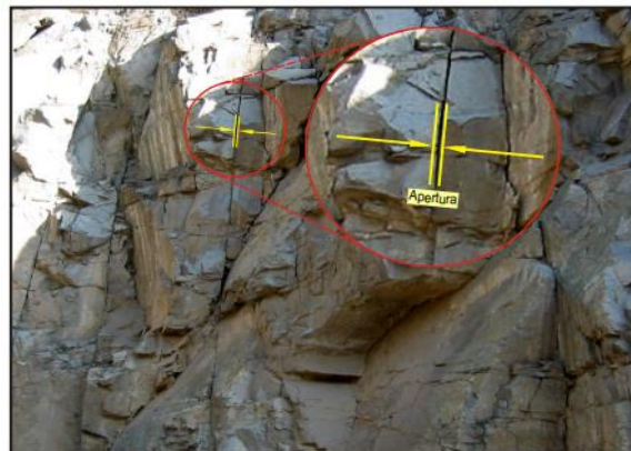
Figura N° 07: Apertura de una discontinuidad
