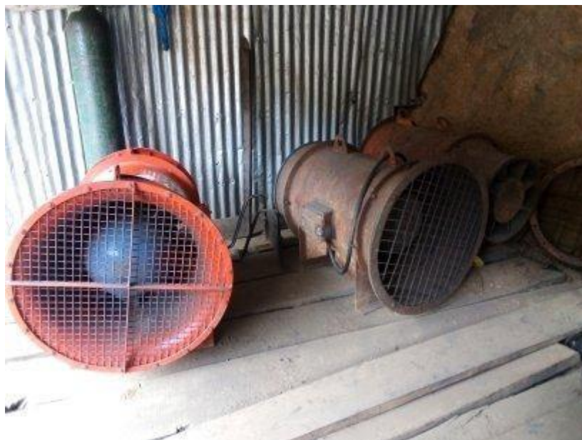
Fotografía 3. Ventiladores en mal estado de uso.
