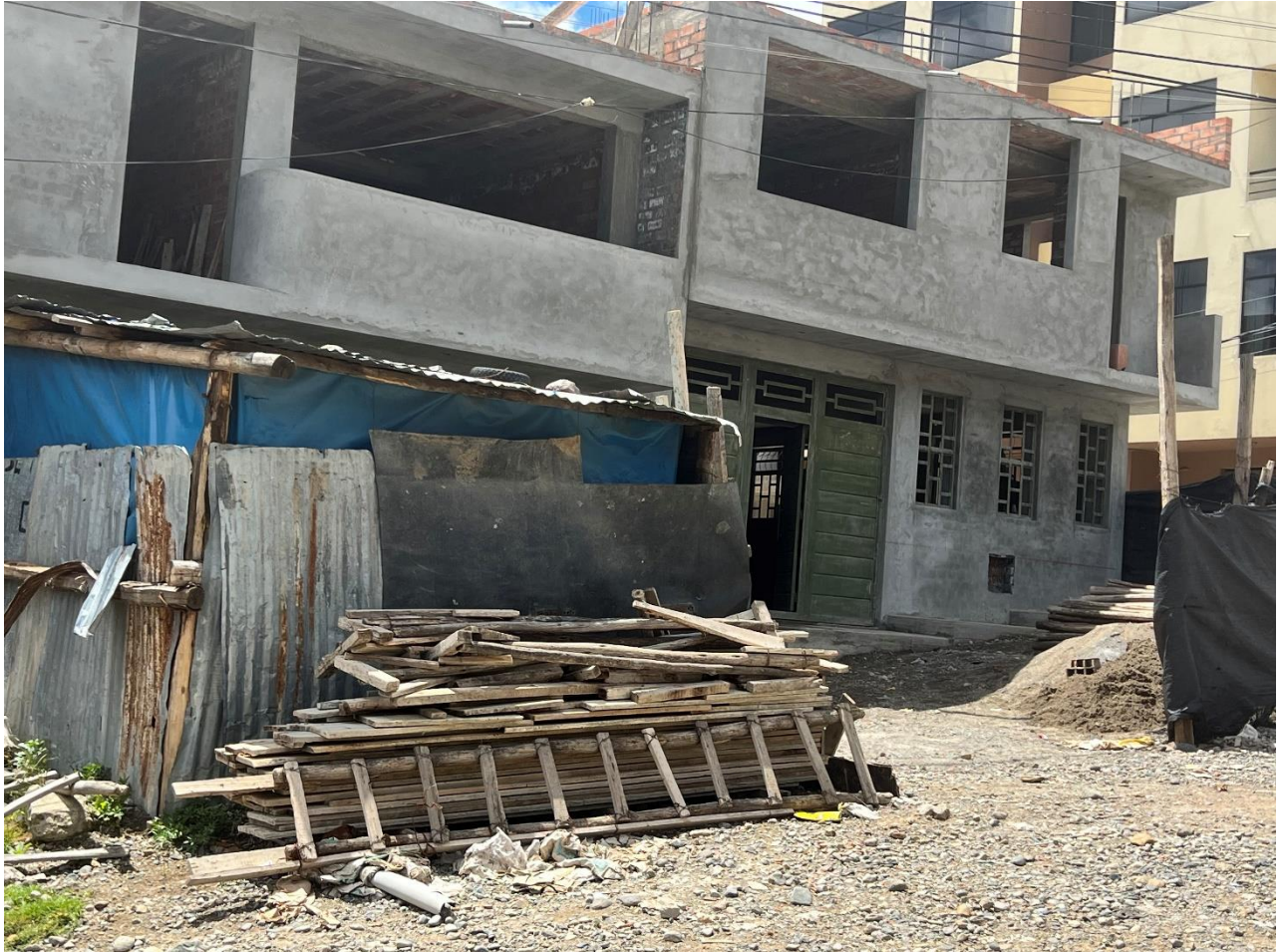
Fotografía 5 Restos de construcción abandonados en la vía pública.
