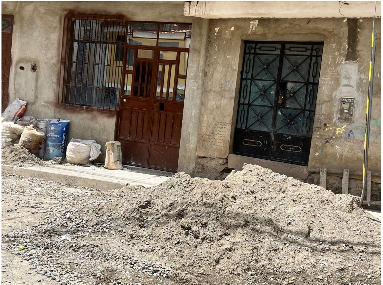
Fotografía 6 Arena abandonada sin protección en la vía pública, lo que genera alteración de la calidad del aire.
