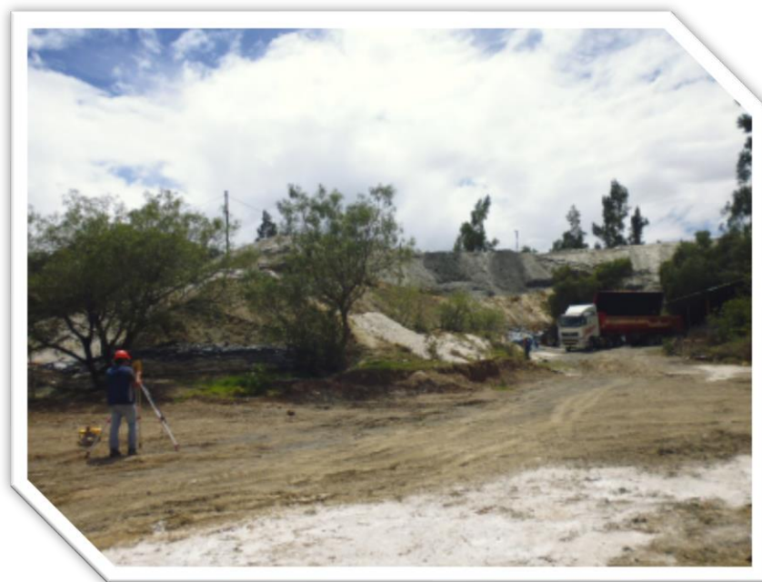
FOTO N°2: Levantamiento Topográfico de la Planta Concentradora de Minerales Santa Rosa de Jangas
