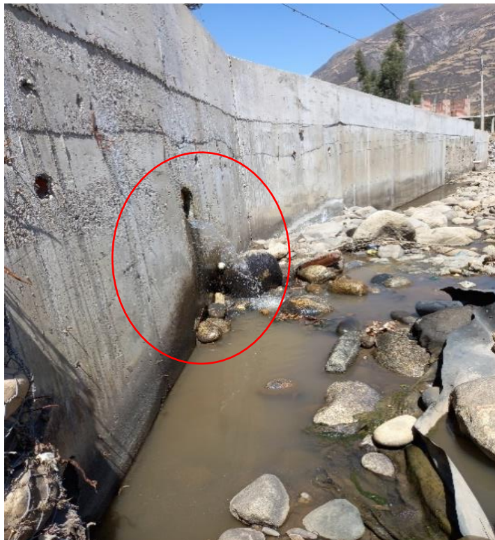
Figura 28 Descarga de Aguas Residuales Cerca al Puente Acopampa
