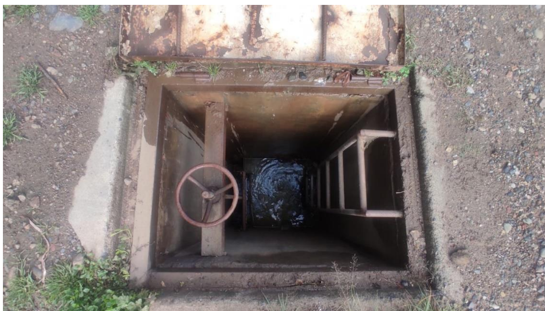
Foto 1: Cámara de Rejas Manual
