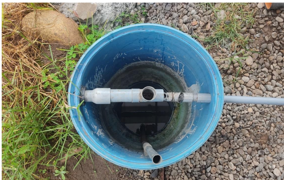
Foto 2: Sedimentador Primario Circular
