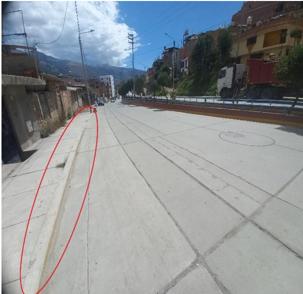
Marca plana “LINEA DE BORDE CALZADA” con desgaste de pintura – Av. Confrat. Int. Este
