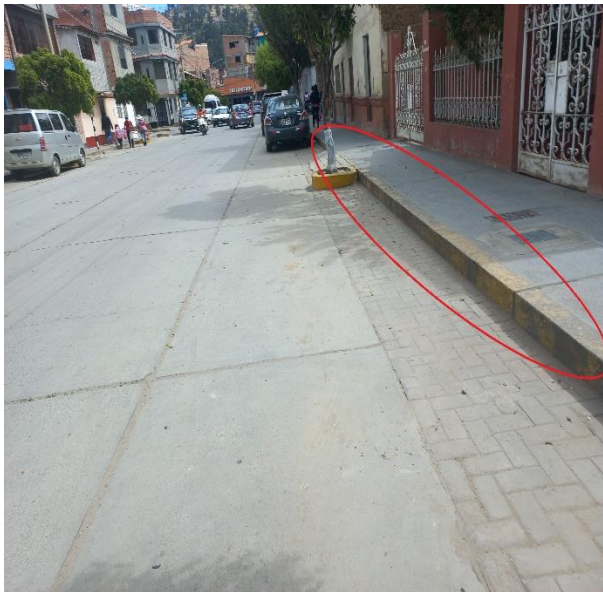
Demarcación “LINEA DE BORDE CALZADA” con desgaste de pintura – Jr. Pablo Patrón
