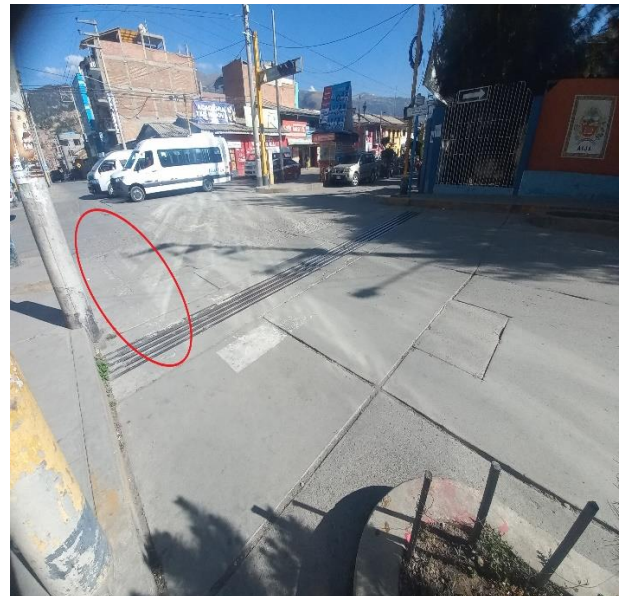
Demarcación “LINEAS DE CRUCE PEATONAL” con desgaste de pintura – Jr. Víctor Vélez
