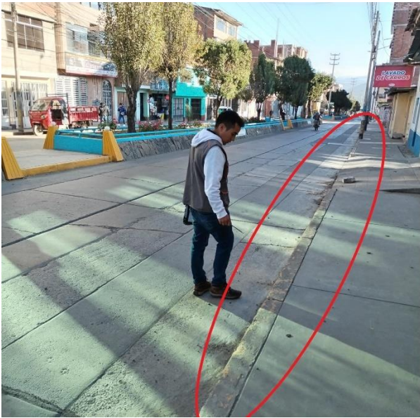
Marca plana “LINEA DE BORDE CALZADA” con desgaste de pintura – Av. Confrat. Int. Oeste
