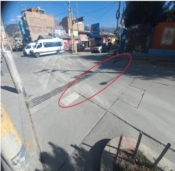
Demarcación “LINEA DE PARE” con desgaste de pintura – Jr. Víctor Vélez
