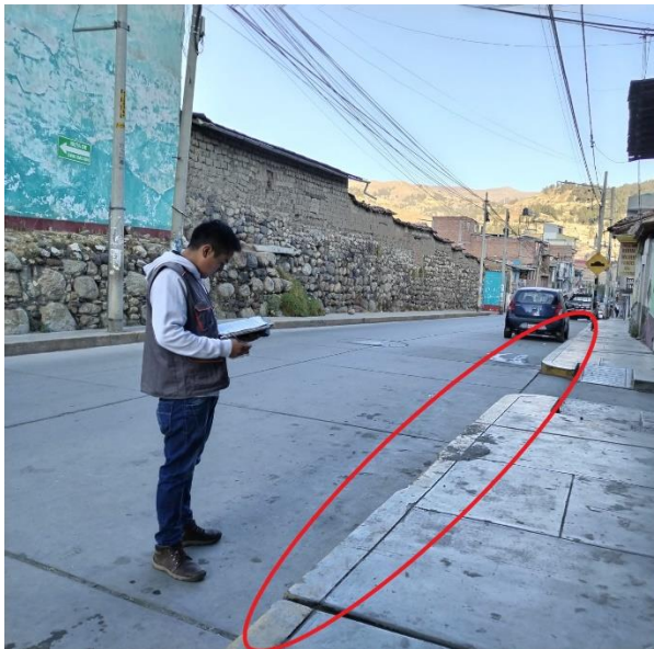
Demarcación “LINEA DE BORDE CALZADA” con desgaste de pintura – Jr. Víctor Vélez
