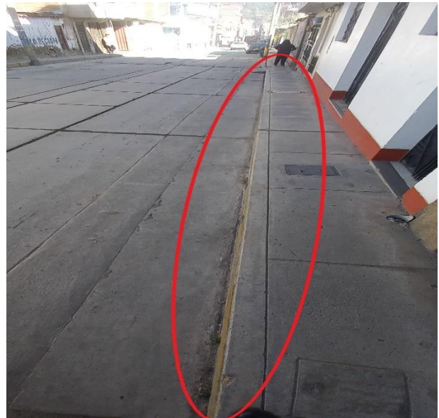
Demarcación “LINEA DE BORDE CALZADA” con desgaste de pintura – Av. Manco Cápac
