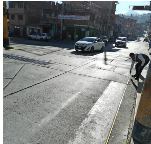
Demarcación “LINEAS DE CRUCE PEATONAL” con desgaste de pintura – Jr. Pablo Patrón
