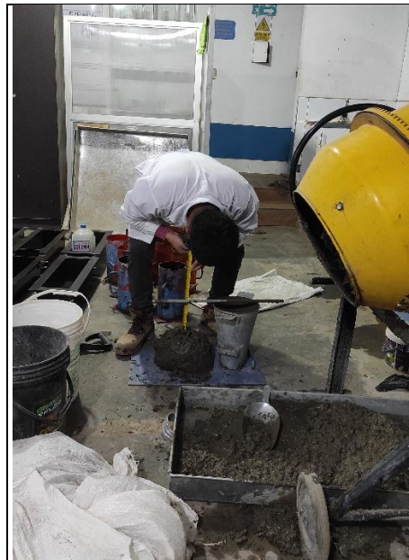
Foto 42: Medición del slump, no cumple con el diseño
