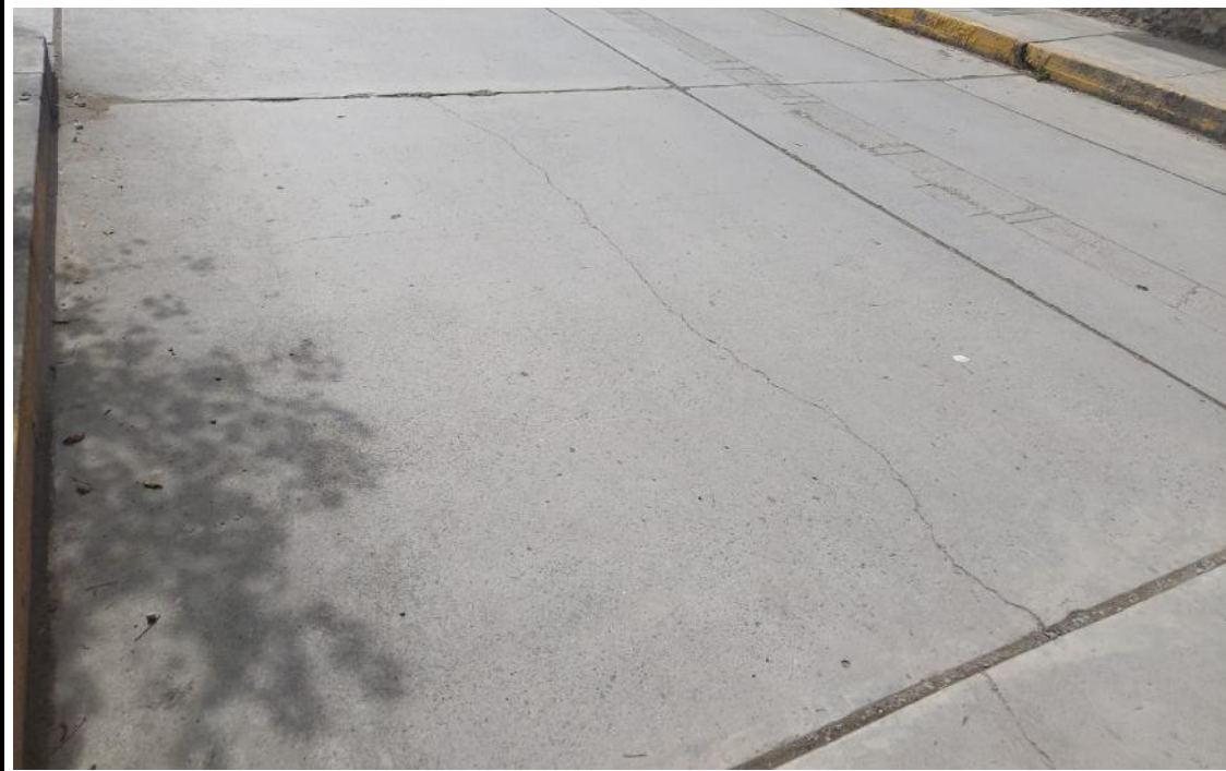
Daños: Grieta lineal, descascaramiento de esquina de severidad baja y descascaramiento de junta de severidad media (28L, 38L y 39M)
