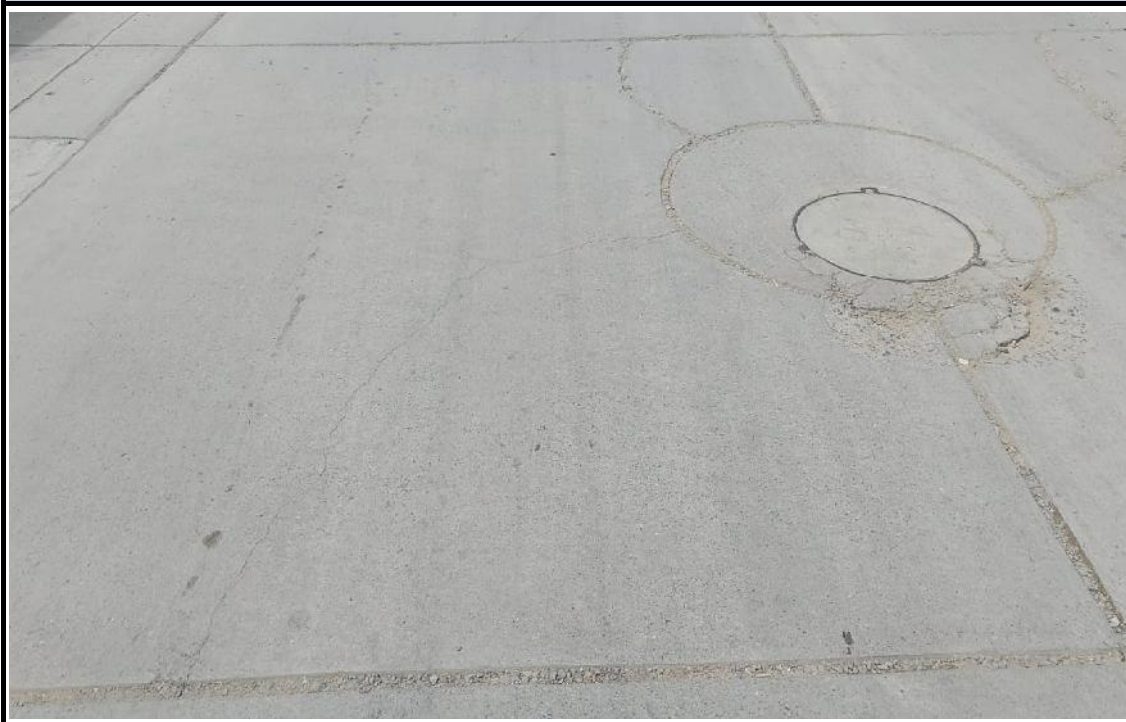
Daños: Grieta de esquina de severidad baja y alta, craquelado de severidad media (22L, 22H, 36M)
