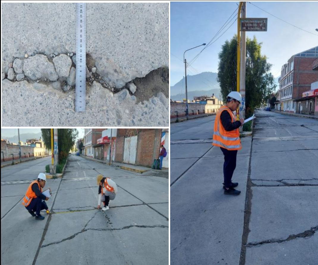
Medicion de los daños al inicio de la Av. Atusparia, interseccion con la Av. Villon
