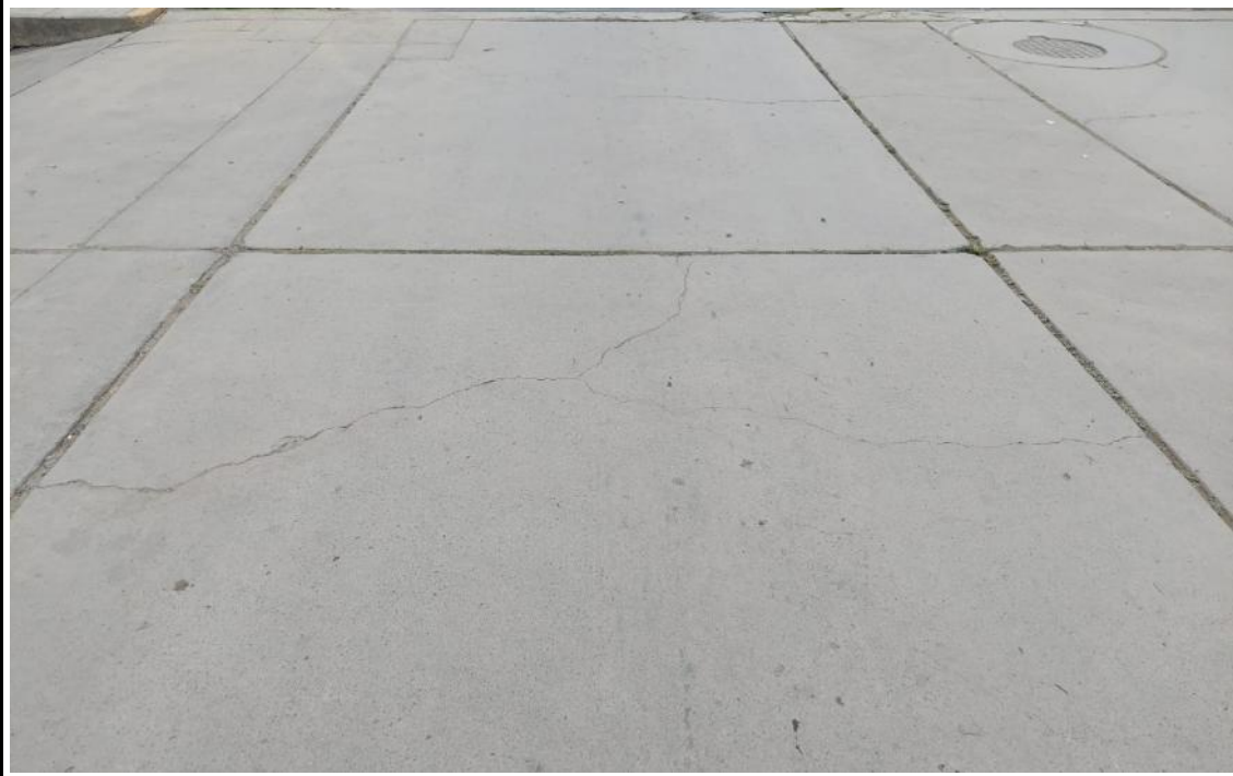
Daños: Grieta de esquina de severidad media y grieta lineal de severidad baja (22M y 28L)
