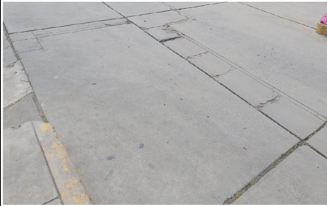
Daños: Parche grande de severidad alta (29H)
