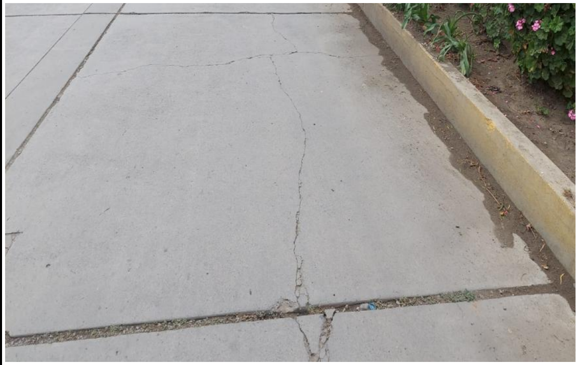
Daños: Losa dividida de baja severidad baja (23L)
