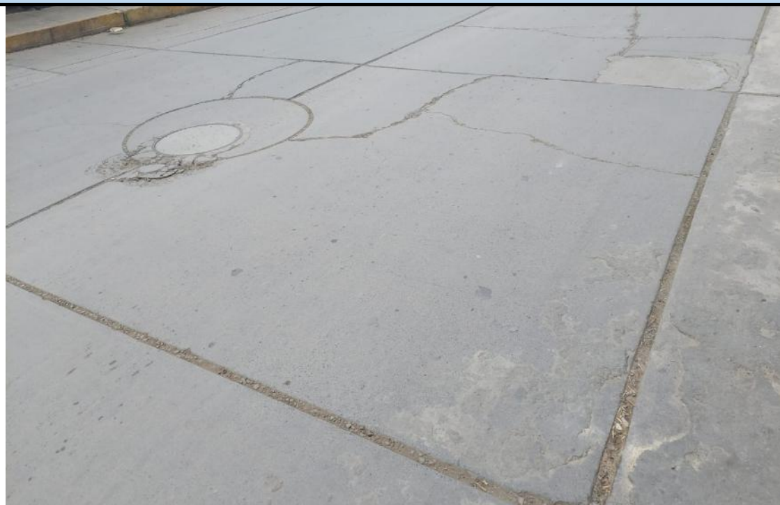
Daños: Grieta de esquina de severidad alta, grieta lineal media, craquelado de severidad media (28M, 22H, 36M)
