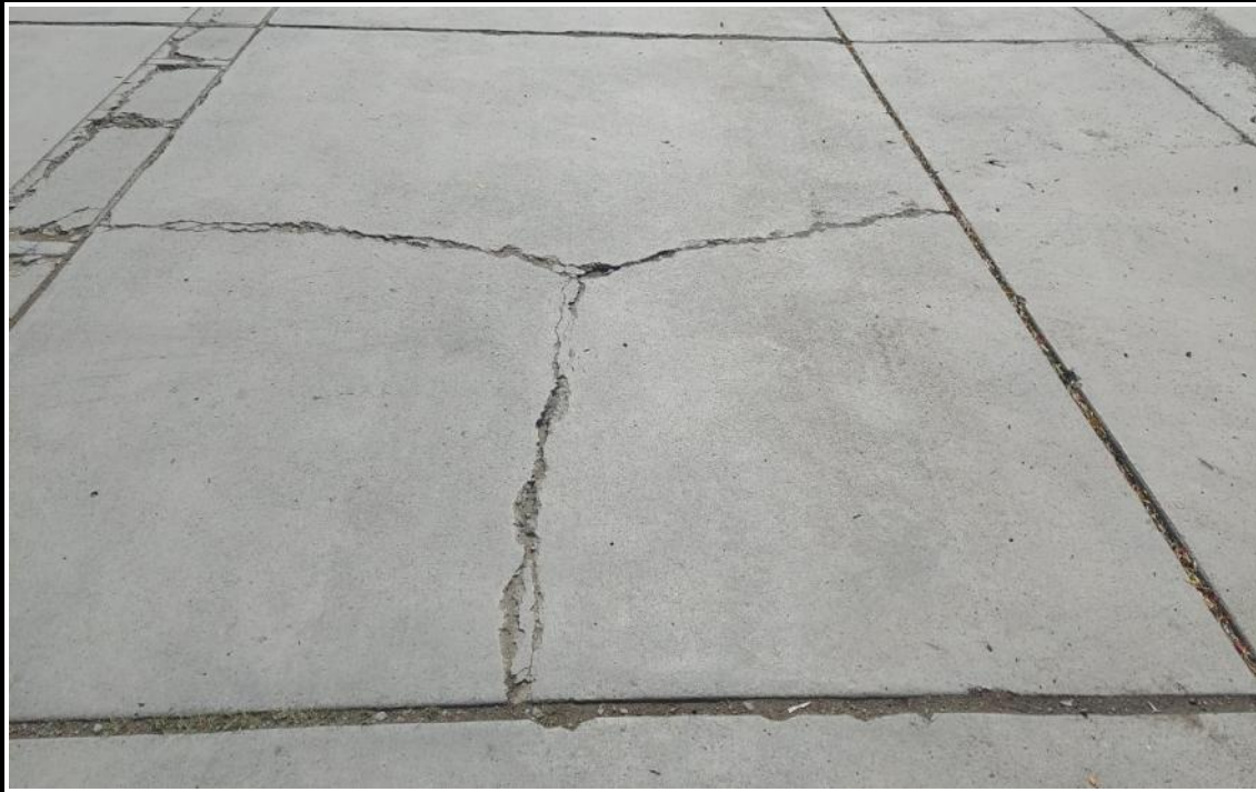
Daños: Parche grande y grieta lineal de severidad alta (29H y 28H)
