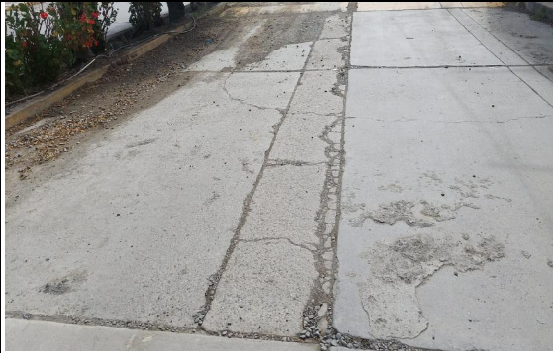
Daños: Parche grande de severidad alta y grieta de esquina de severidad media (29H y 22M)
