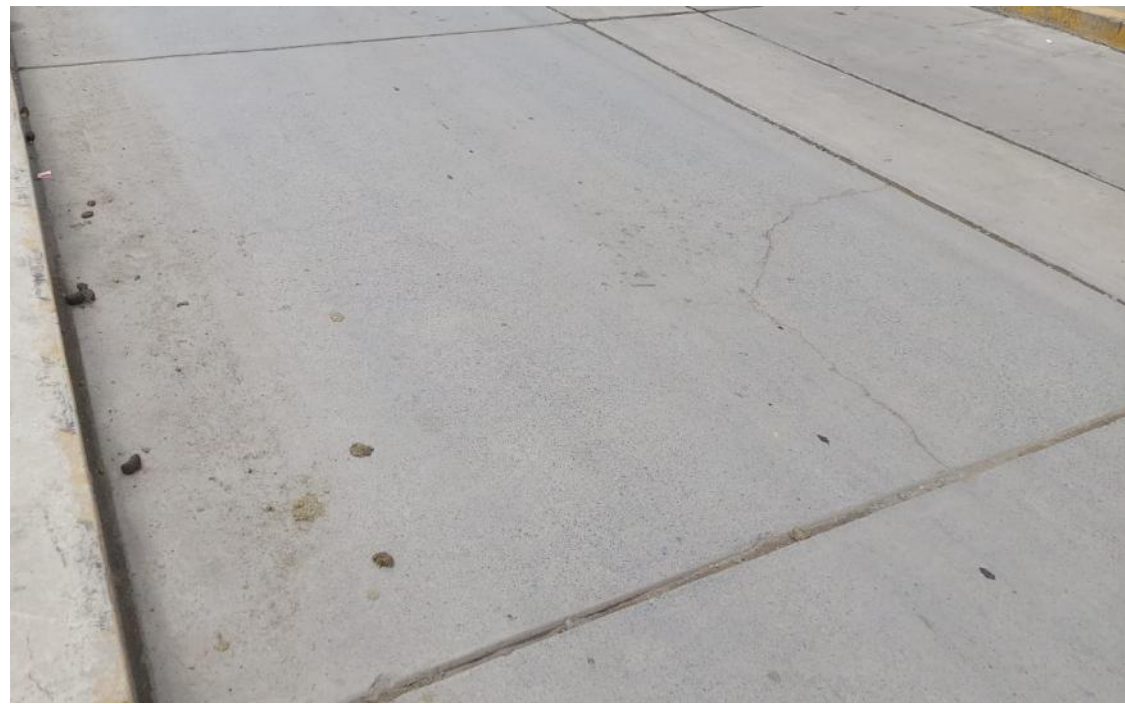
Daños: Grieta de esquina de severidad baja (22L)
