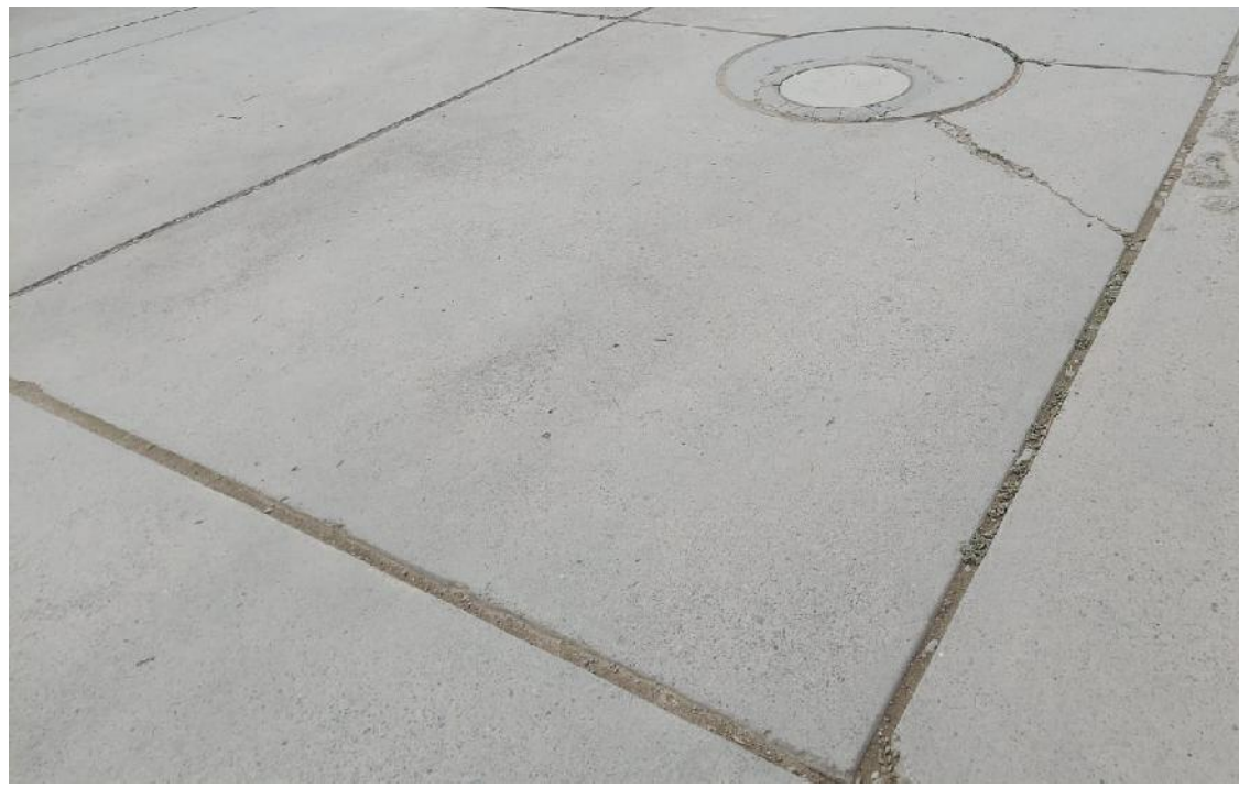
Daños: Grieta lineal de severidad alta (28H)
