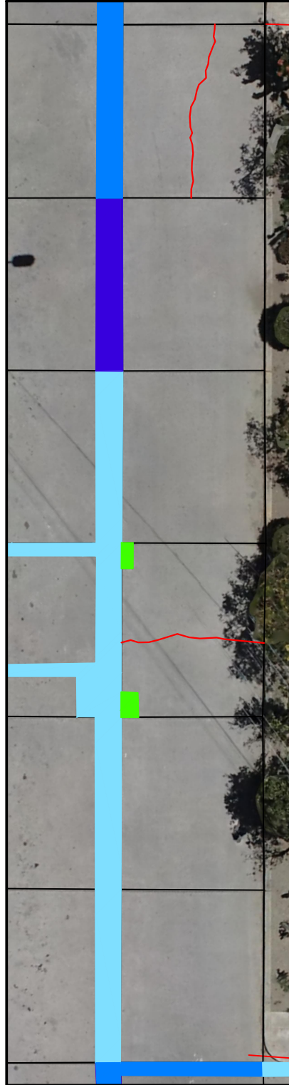
IDENTIFICACION DE DAÑOS
