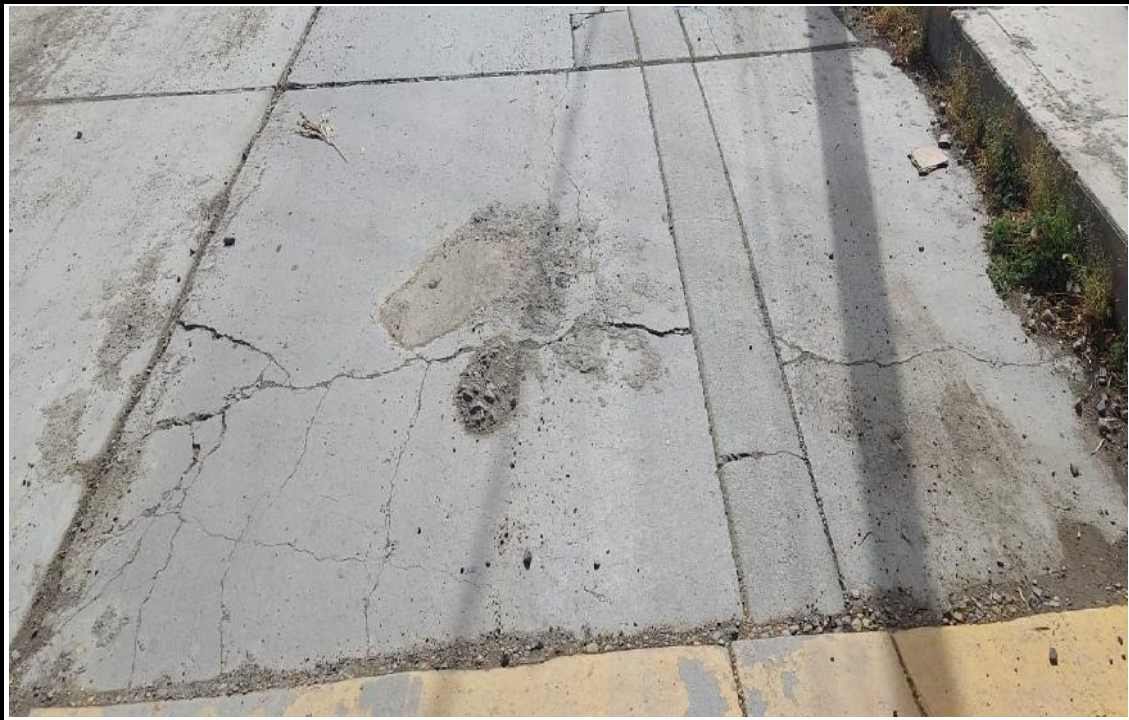
Daños: Parche grande de severidad baja y punzonamiento de severidad alta (29L y 34H)
