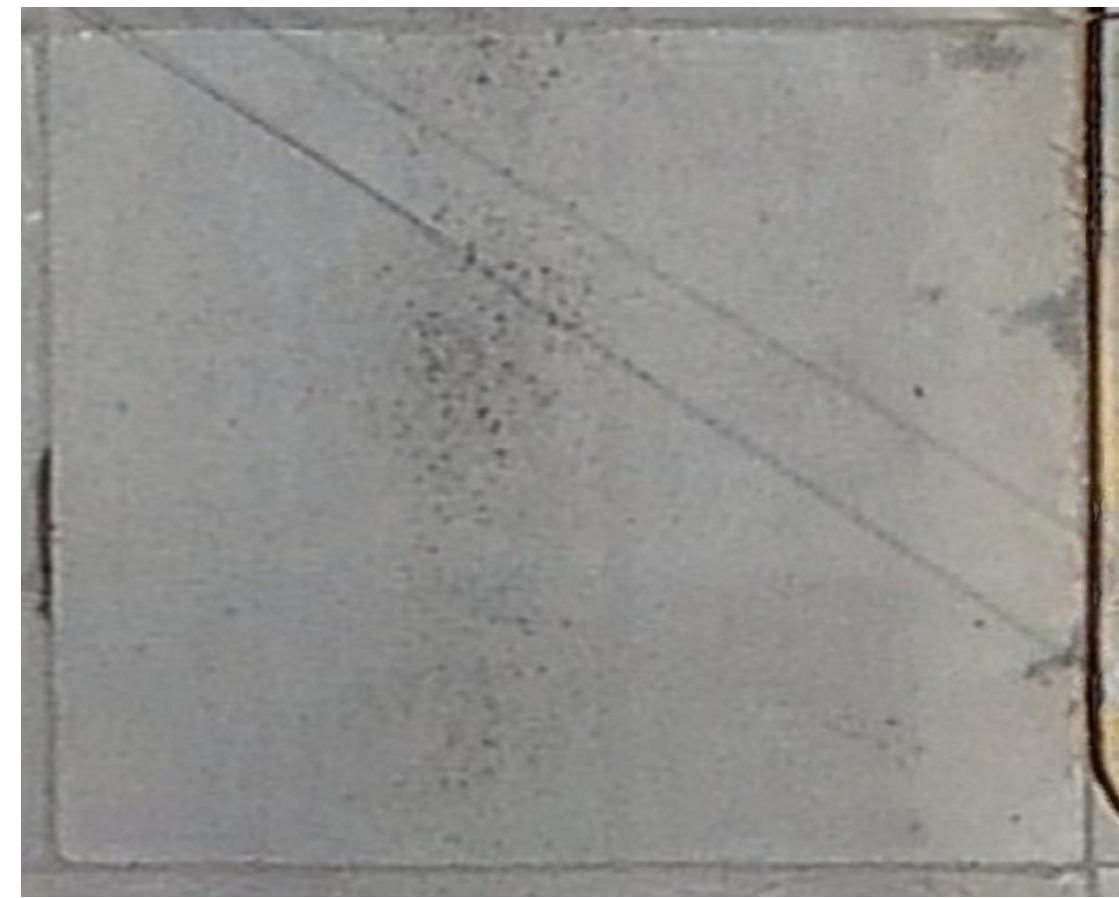
Daños: Pulimento de agregado
