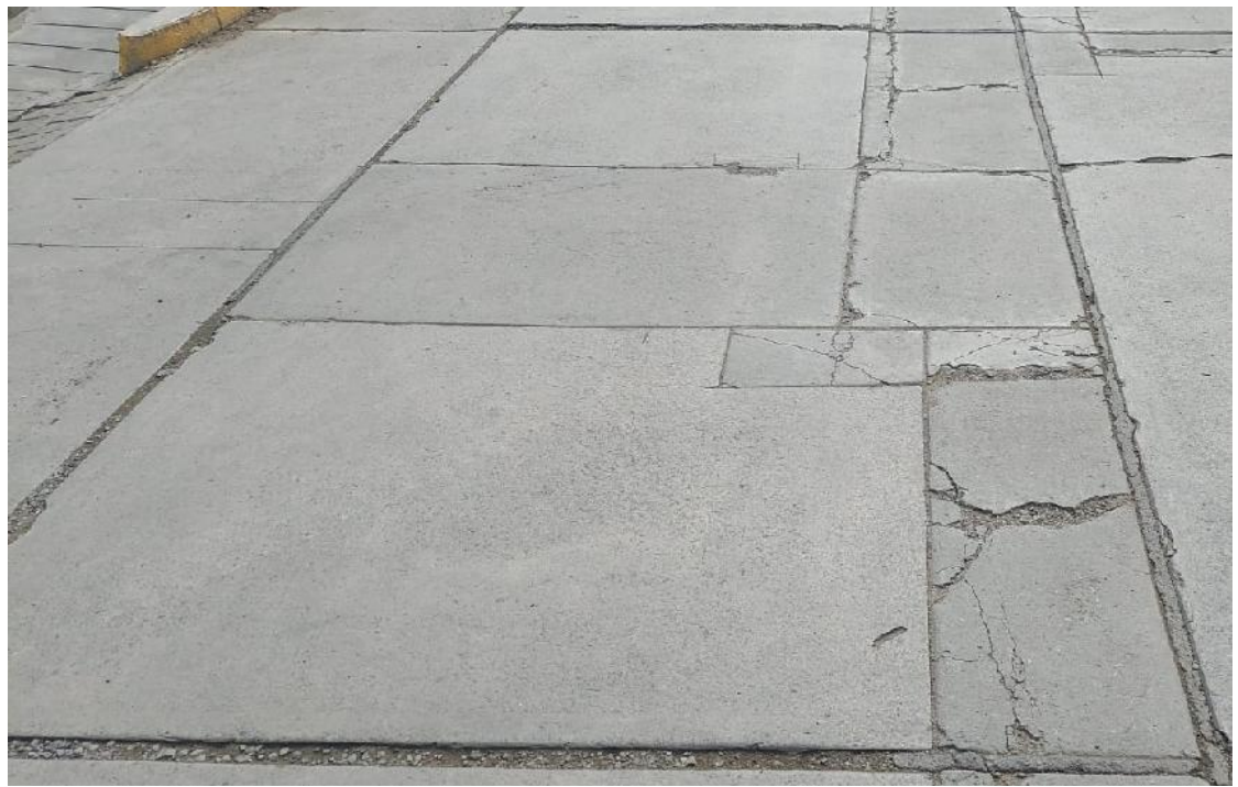
Daños: Parche grande de severidad baja y losa dividida de severidad media (29L y 23M)
