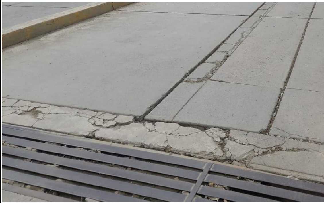
Daños: Parche grande de severidad alta (29H)
