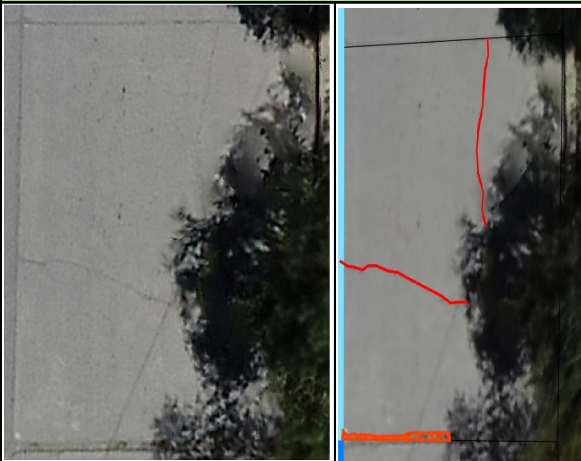
Daños: Grieta lineal y descascamiento de junta de severidad media (28M y 39M). El árbol cubre el daño
