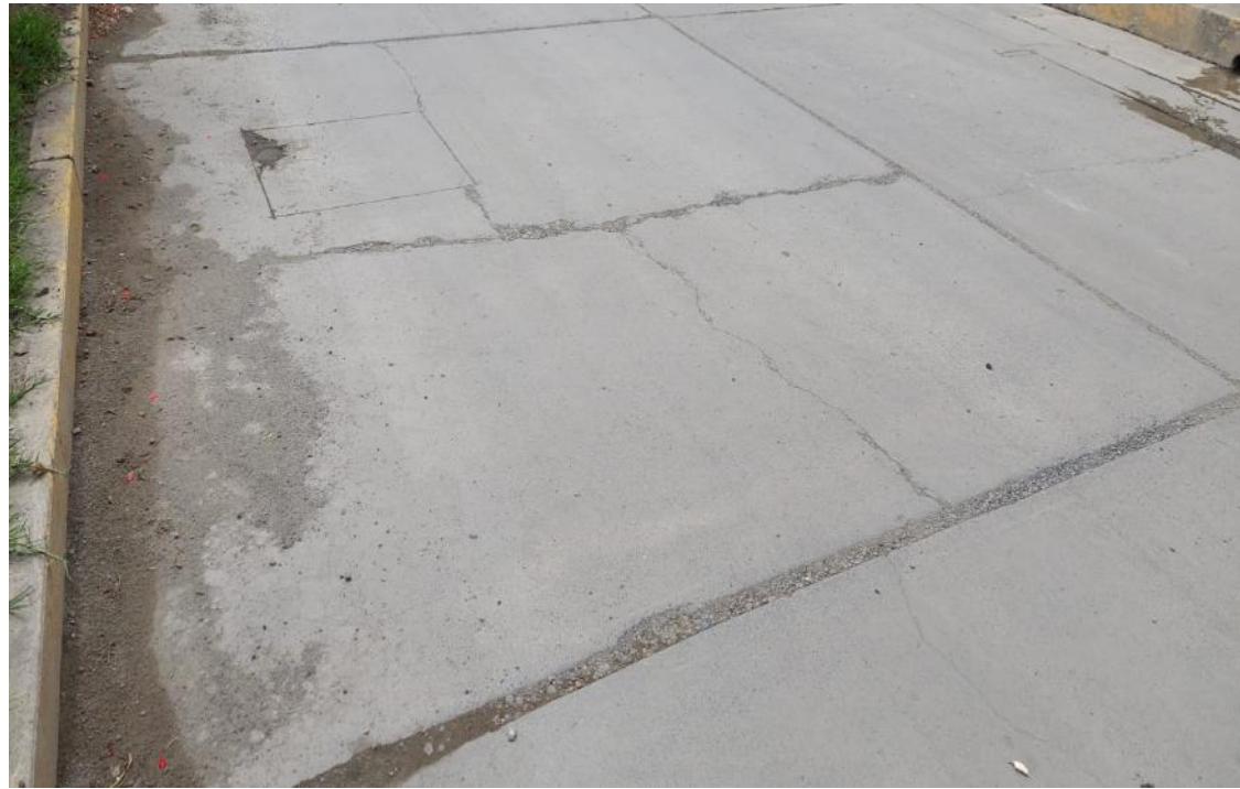
Daños: Parche grande de severidad alta y losa dividida de severidad media (29H y 23M)
