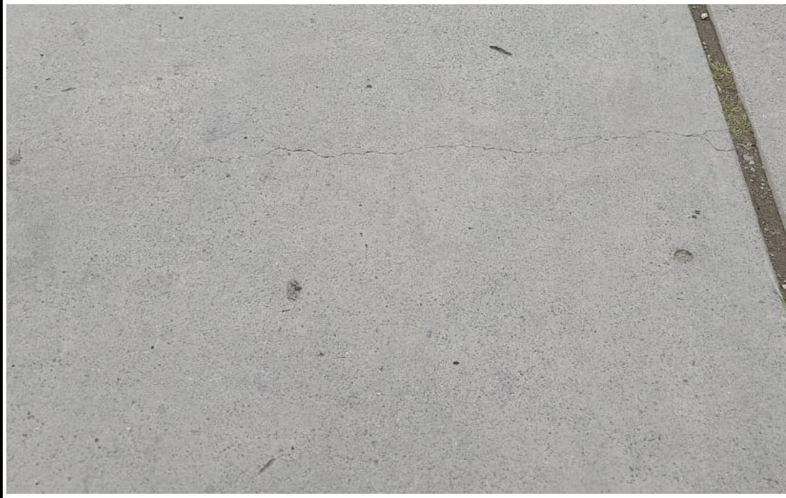
Daños: Grieta de retraccion (37)
