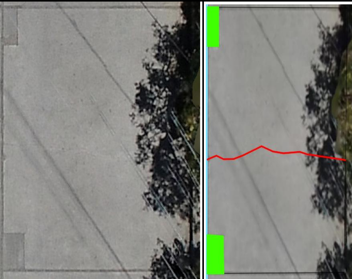
Daños: Parche pequeño de severidad baja y grieta lineal de severidad media (30L y 28M)
