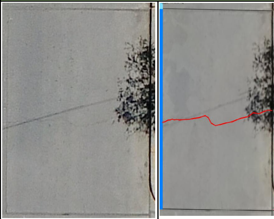
Daños: Grieta lineal de severidad media (28M)
