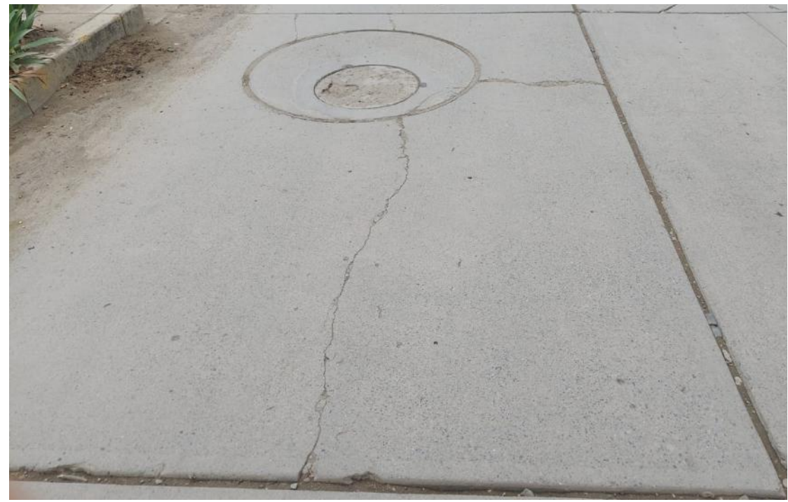
Daños: Grieta lineal de todas las severidades (28L, 28M y 28H)
