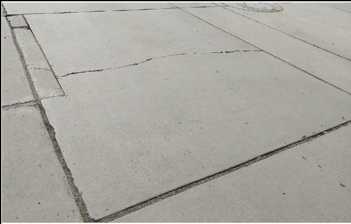
Daños: Parche grande de severidad alta y grieta lineal de severidad media (29H y 28M)
