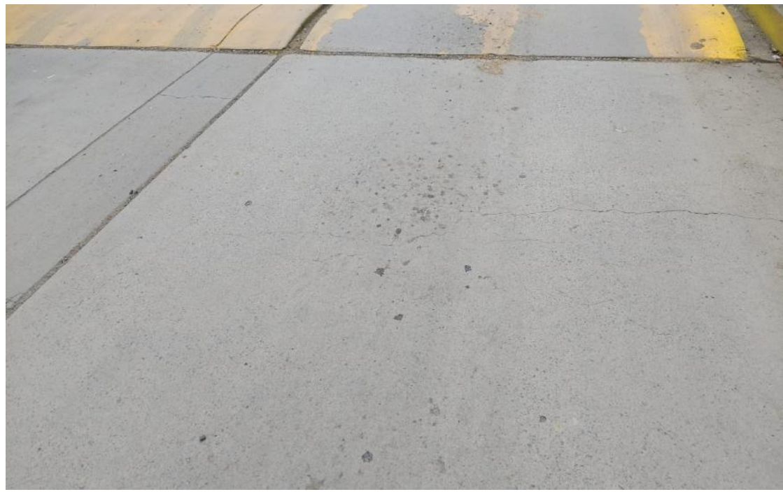
Daños: Pulimento de agregado y grietas de lineal de severidad de severidad baja (31 y 28L)
