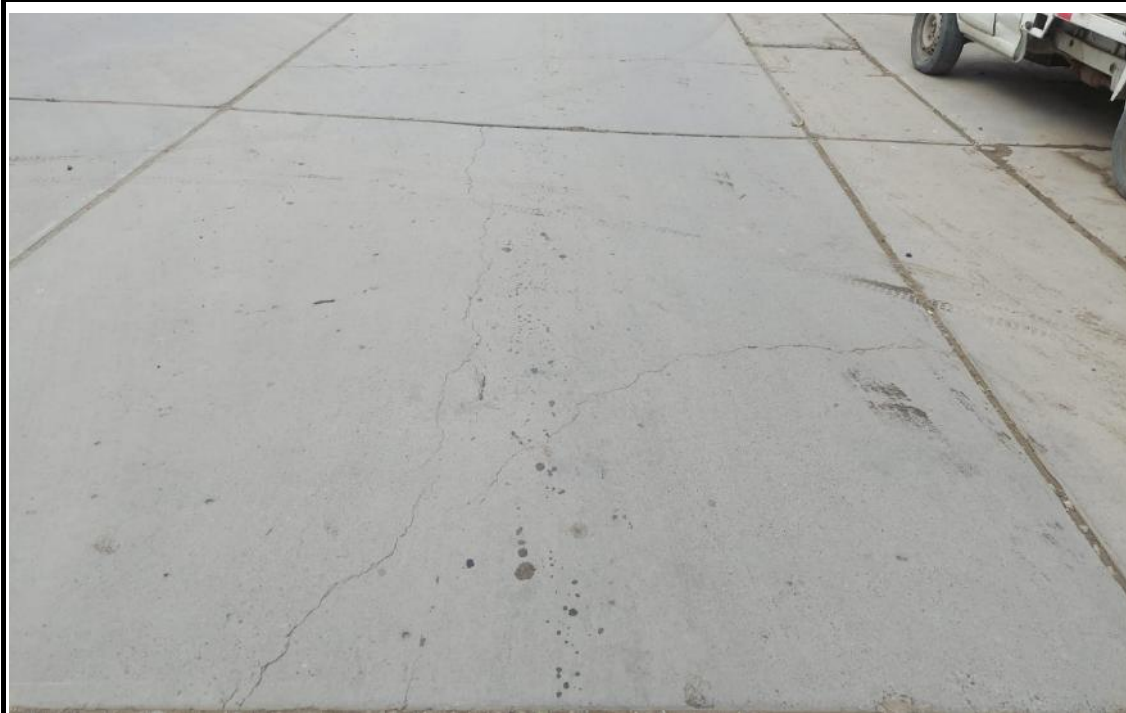
Daños: Grieta lineal y de esquina de severidad baja (22L y 28L)
