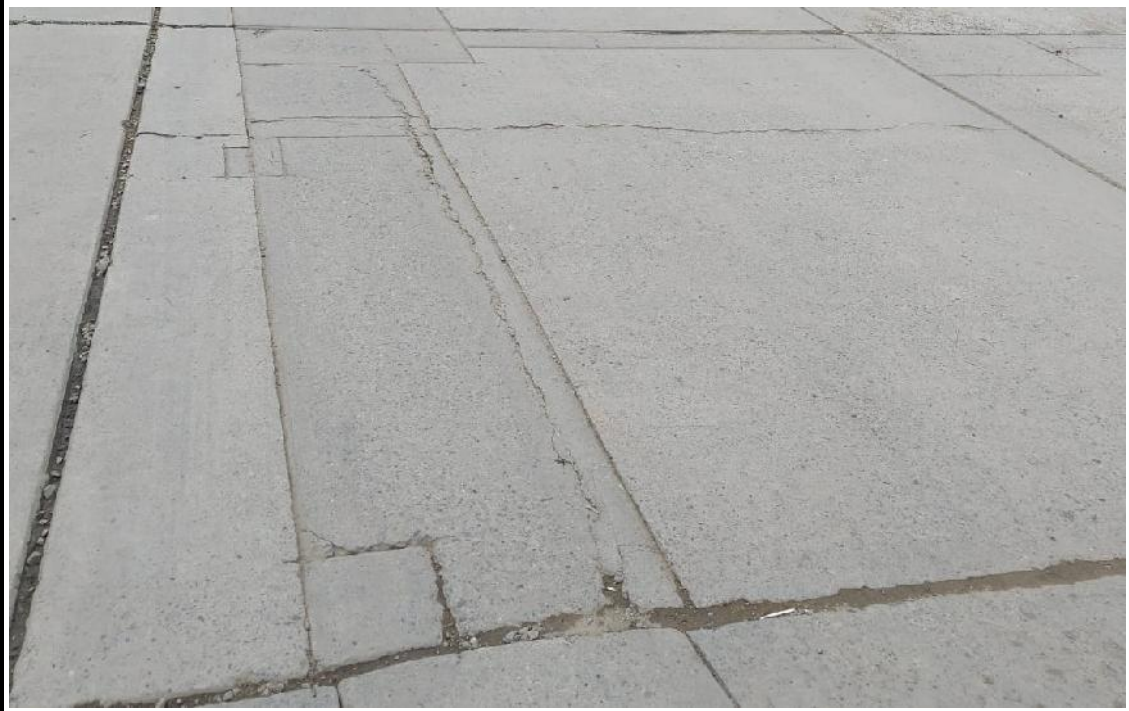
Daños: Parche grande de severidad alta y grieta lineal de severidad media (29H y 28M)
