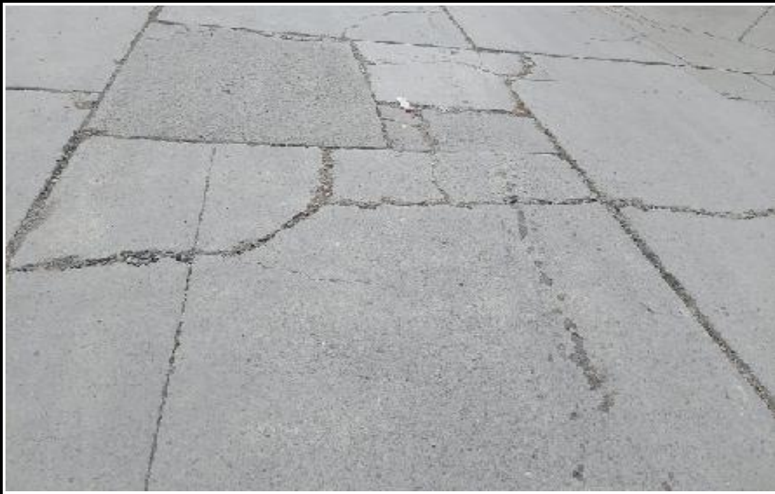
Daños: Parche grande de severida alta y punzonamiento de severida media (29H, 34M)
