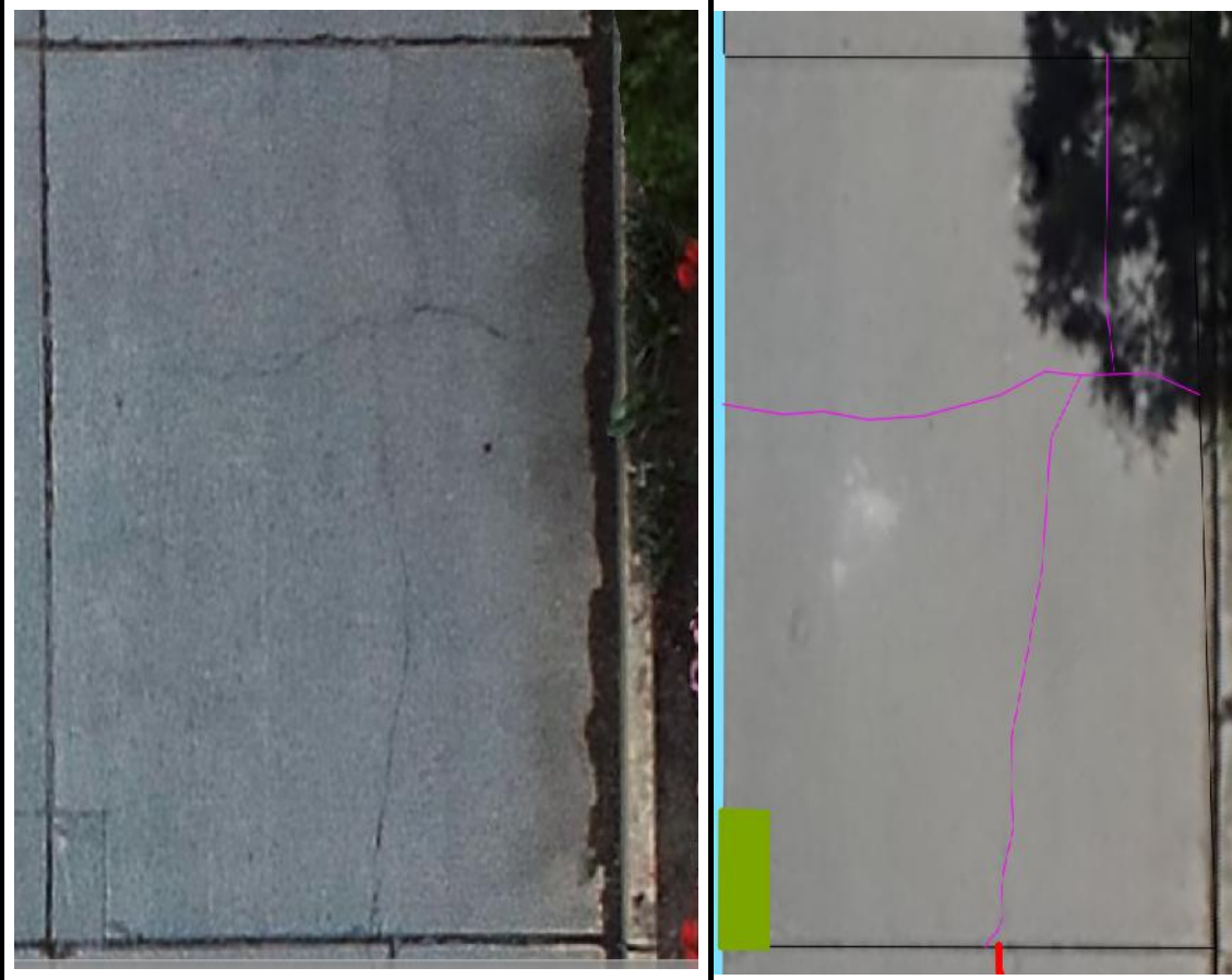
Daños: Losa dividida de baja severidad baja y parche pequeño de severidad media (23L y 30M)
