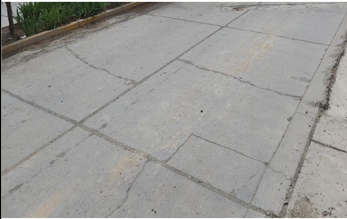
Daños: Parche grande de severida alta y grieta lineal de severidad media y alta (29H, 28M y 28H)
