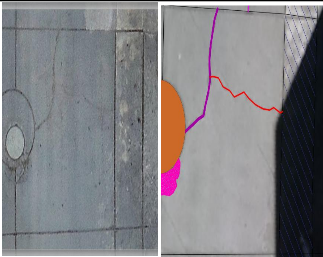
Daños: Grieta de esquina de severidad alta, grieta lineal media, craquelado de severidad media (28M, 22H, 36M)
