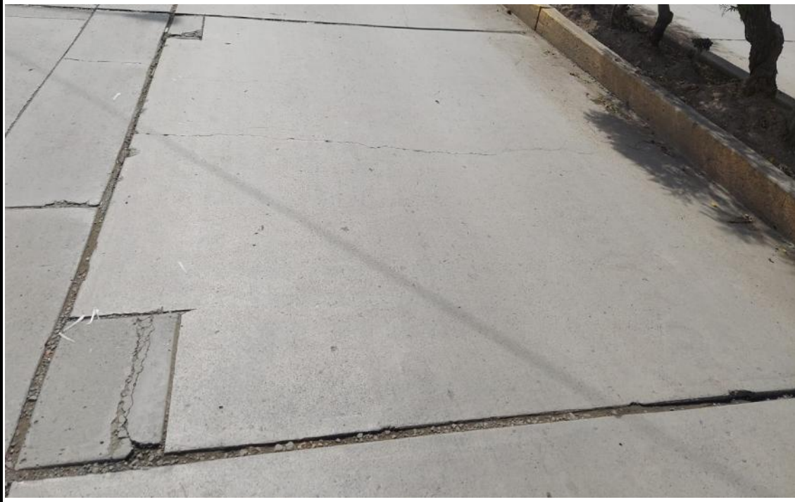
Daños: Parche pequeño de severidad alta y grieta lineal de severidad media (30H y 28M)
