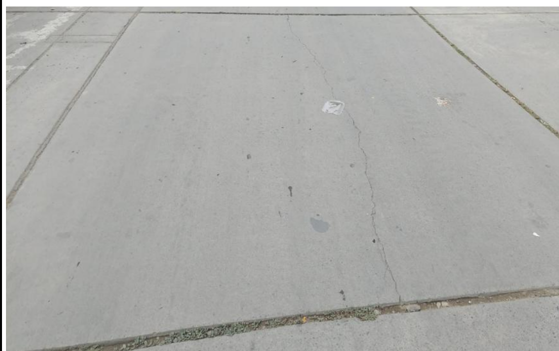
Daños: Grieta lineal de severidad media (28M)
