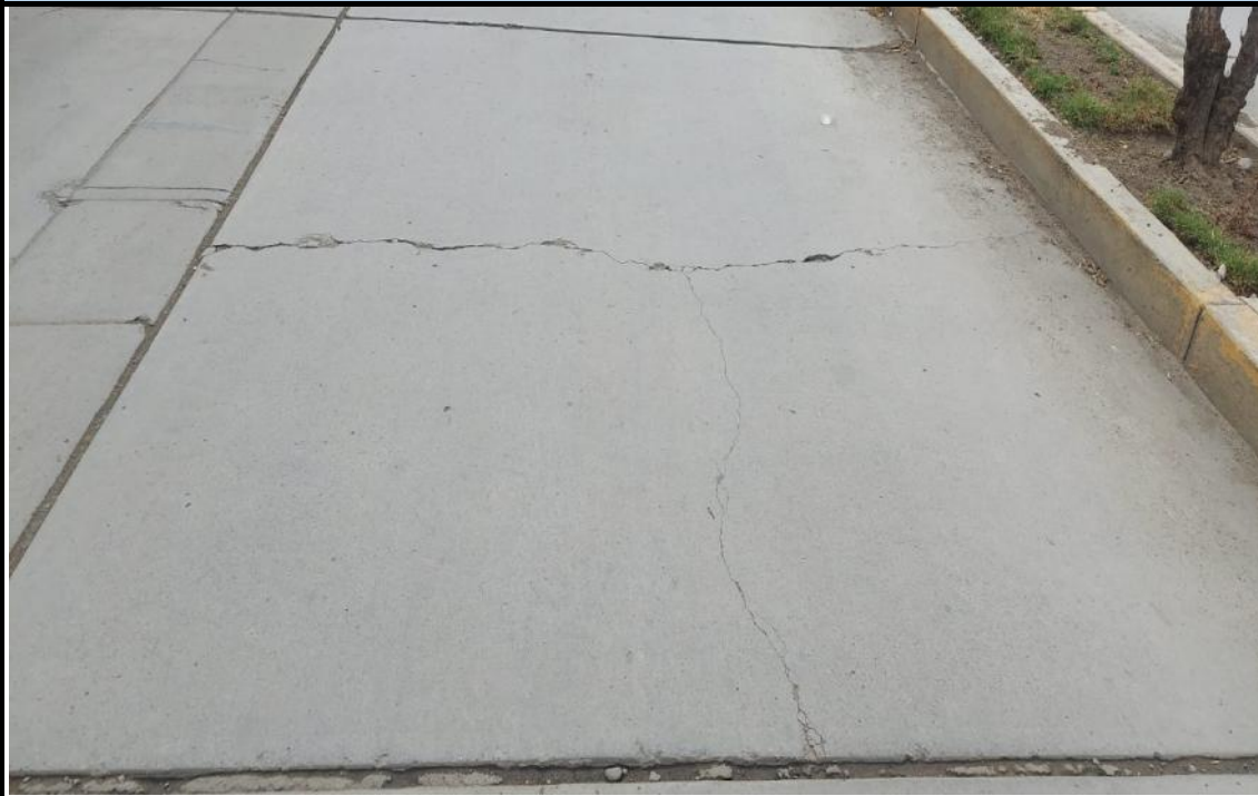
Daños: Grieta lineal de severidad media y baja (28L, 28M)
