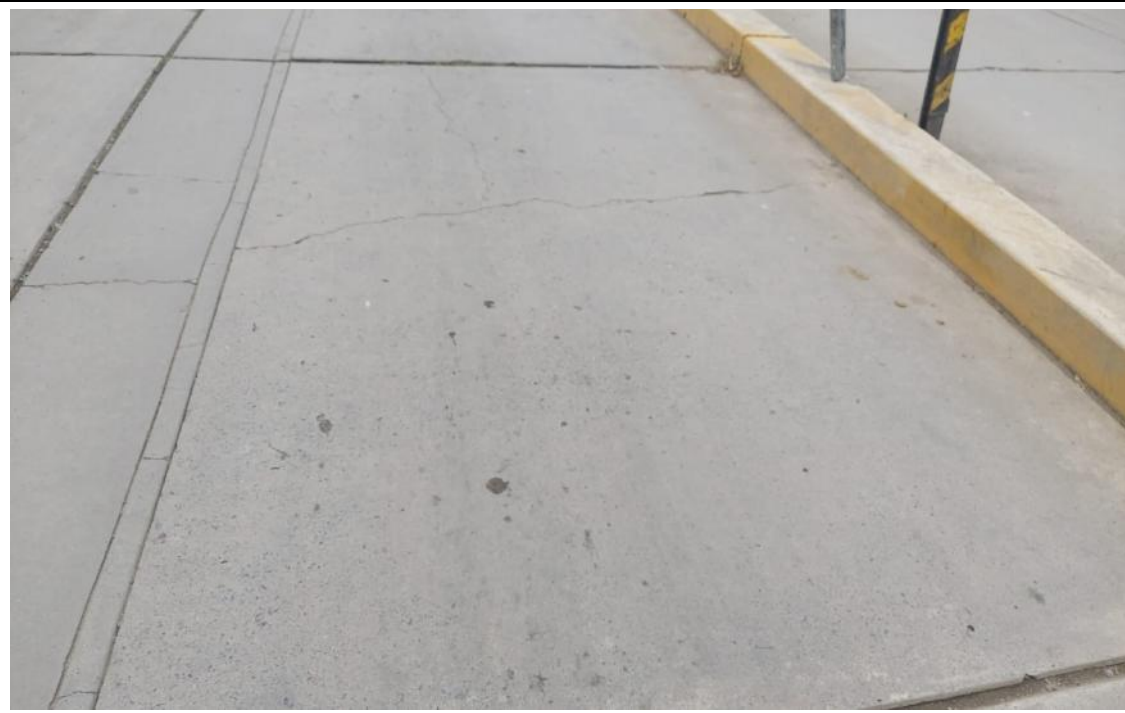
Daños: Grieta lineal de severidad media y baja, parche grande de severidad media (28L, 28M y 29M)
