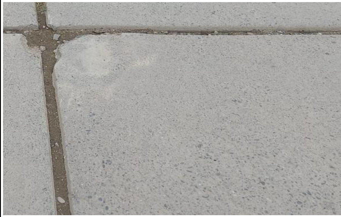
Daños: Descascaramiento de esquina de severidad baja (38L)
