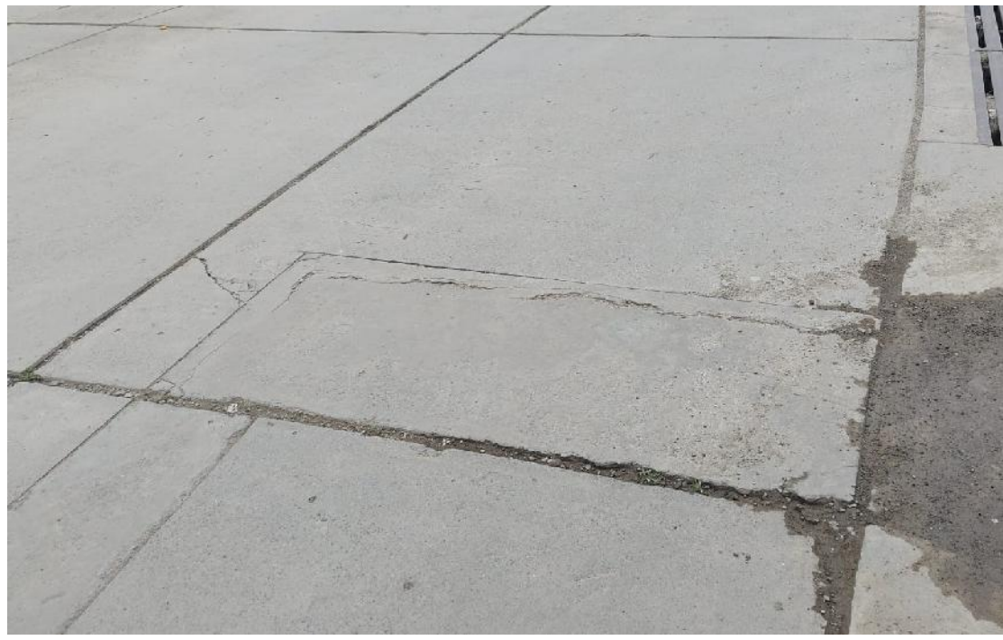
Daños: Grieta lineal y parche grande de severidad media (28M, 29M)
