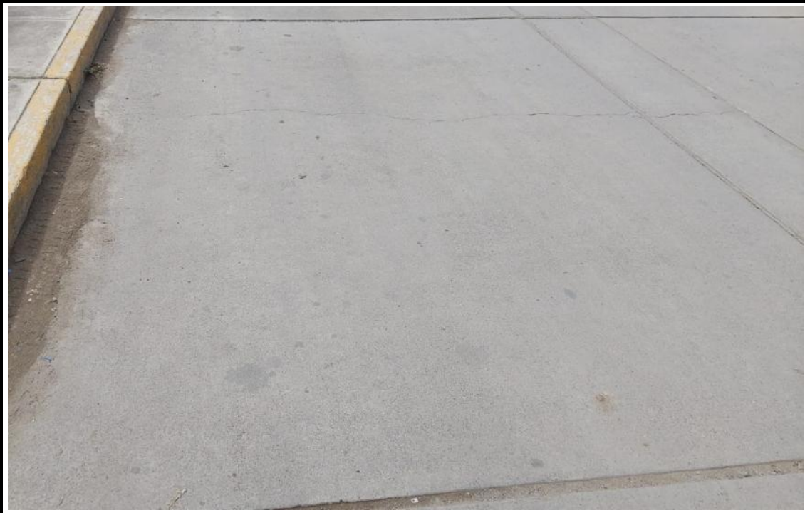
Daños: Grieta lineal de severidad baja (28L)
