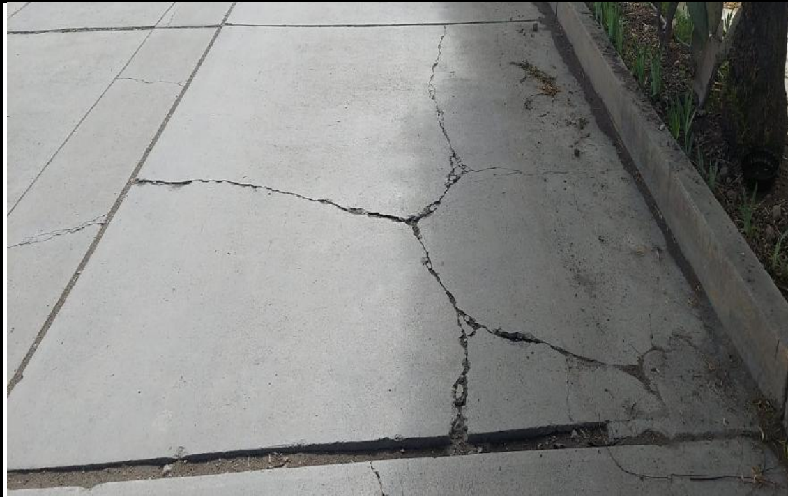
Daños: Losa dividida y descascamiento de junta de severidad media (23M y 39M)
