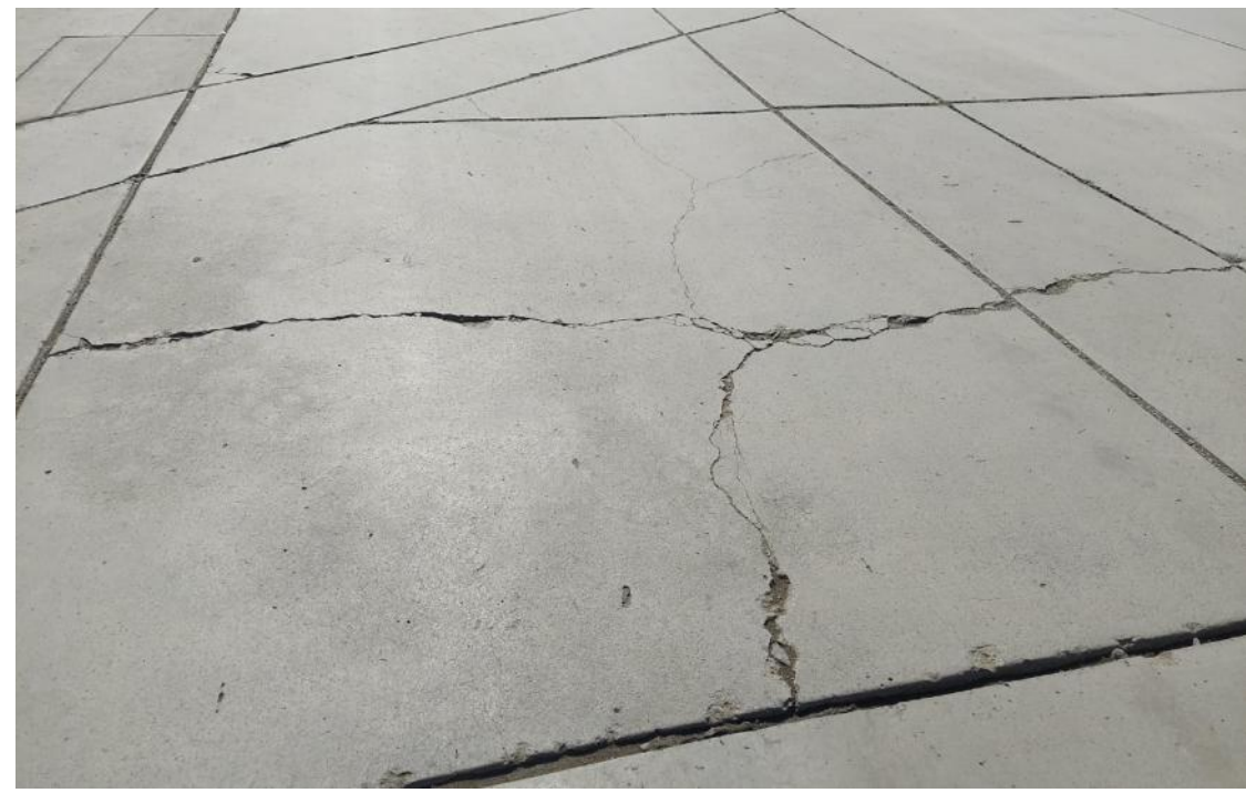
Daños: Losa dividida de severidad media y grieta lineal de severidad alta (23M y 28H)
