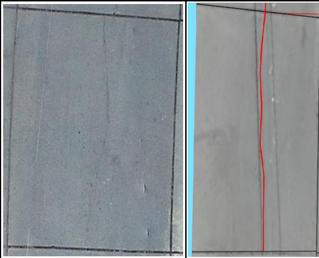
Daños: Grieta lineal de severidad media (28M)
