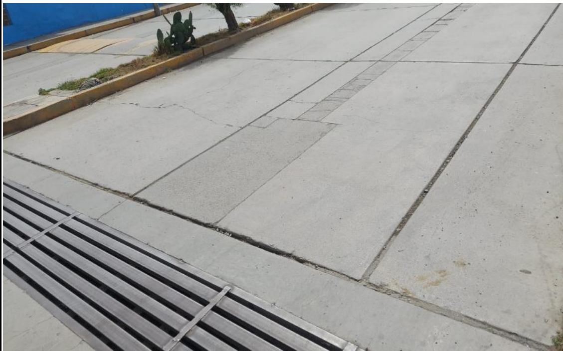
Daños: Grieta lineal de severidad media y baja, parche grande de severidad media (28L, 28M y 29M)
