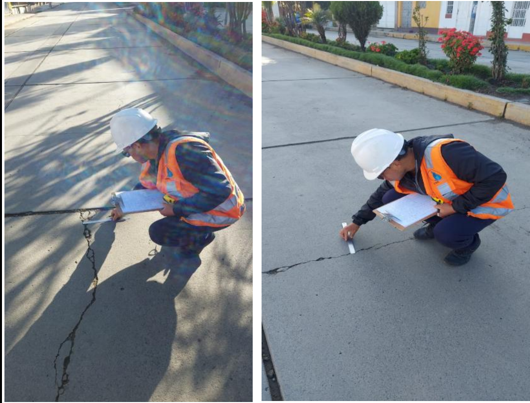
Medicion y registro de los daños de la Av. Atusparia, muestra UMI-01
