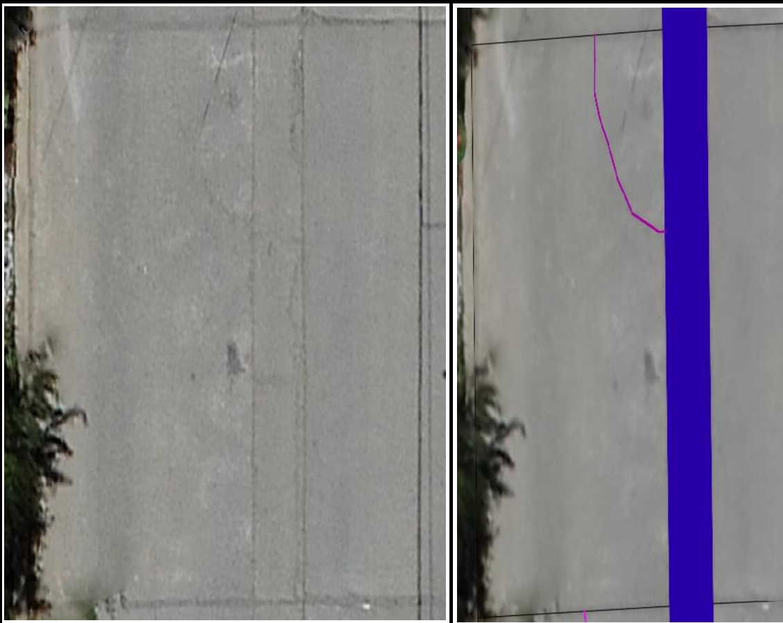
Daños: Parche grande de severidad alta y grieta de esquina de severidad media (29H y 22M)
