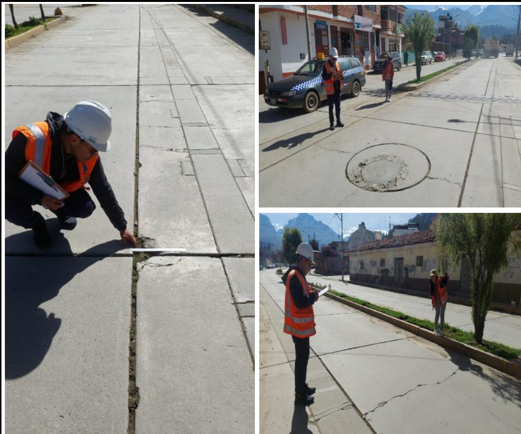
Medicion y registro de los daños de la Av. Atusparia, parte central
