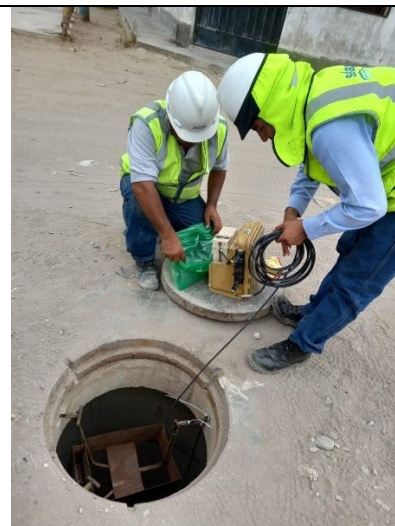
Fotografía N°06. Se tiene instalado el soporte para el caudalímetro al interior del buzón a aforar.
