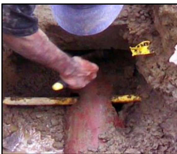
Figura 7 Ruptura de tubería por corrosión
