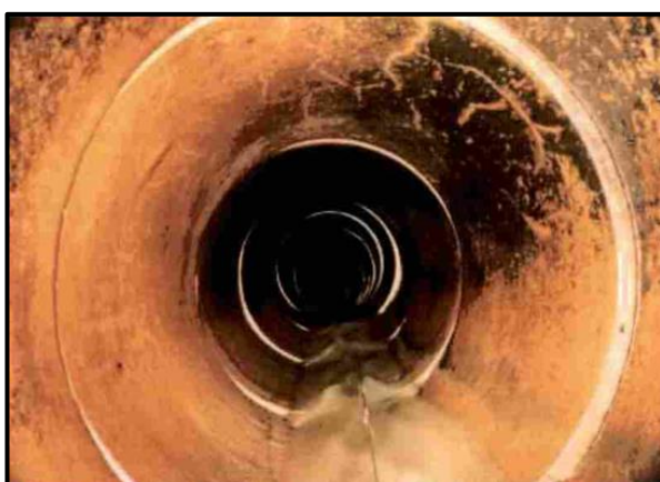
Figura 8 Grieta Múltiple en Tuberías de Alcantarillado Sanitario
