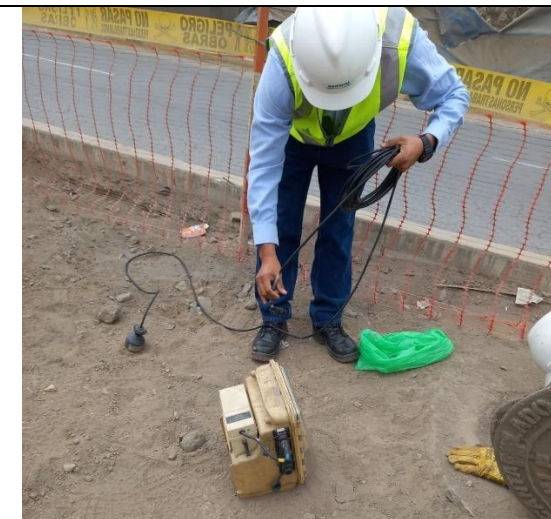
Fotografía N°05. Se observa la instalación del sensor para la lectura de las tirantes al caudalímetro Sigma.
