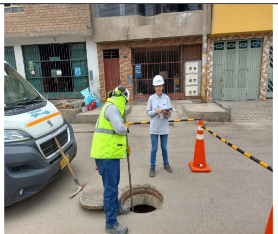
Fotografía N°10. Se observa la inspección en los tramos finales del colector "Cerro Candela".
