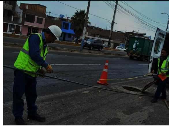
Fotografía N°03. Se observa la medición de altura y velocidades en los buzones al colector Cerro Candela.
