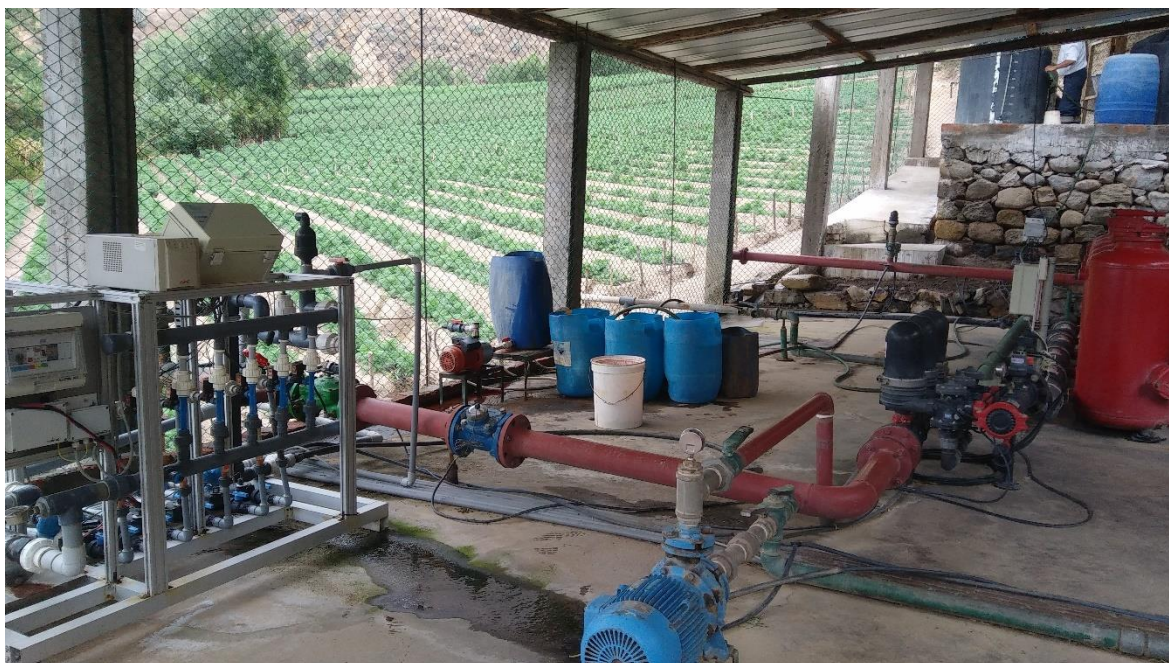
Anexo 16: Fotografía de la Estación de inyección de riego y fertilización.
