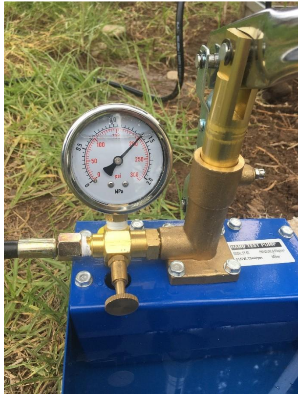
Foto N° 23: Vista del Manómetro a 200 psi (lbs/pulg2).
