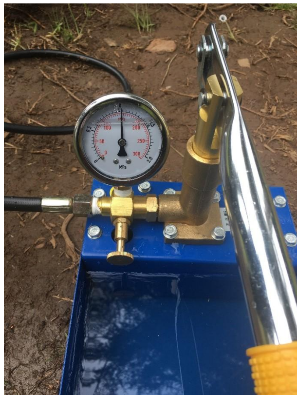
Foto N° 26: Vista del Manómetro a 150 PSI.
