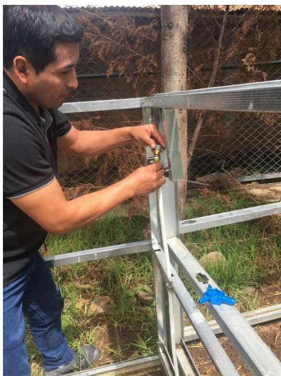
Foto N° 13: Vista de la colocación del tapón en la Tubería Reticulado PEX de ½”
