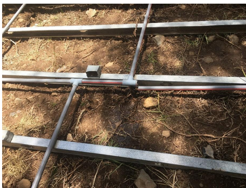
Foto N° 16: Vista de falla en la tubería PVC C-10 de 1/2" al momento de realizar la Prueba Hidráulica.
