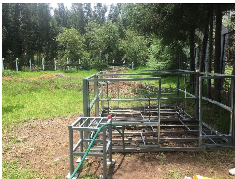
Foto N° 15: Vista de la instalación de la tubería Reticulado PEX y tubería PVC C-10 de 1/2"
