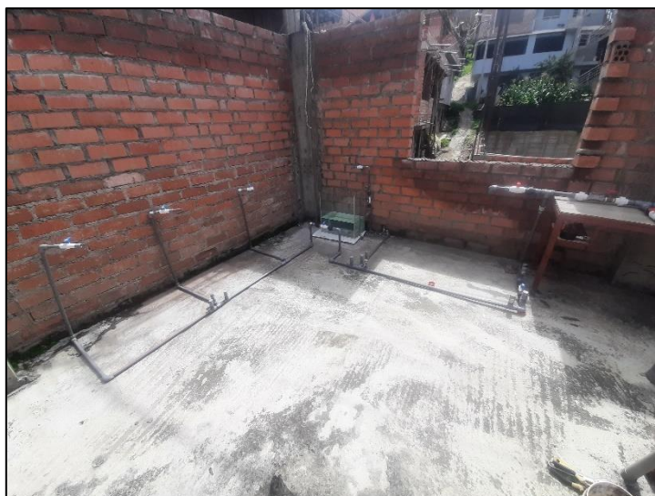
Figura 28 Vista del Circuito Hidráulico
