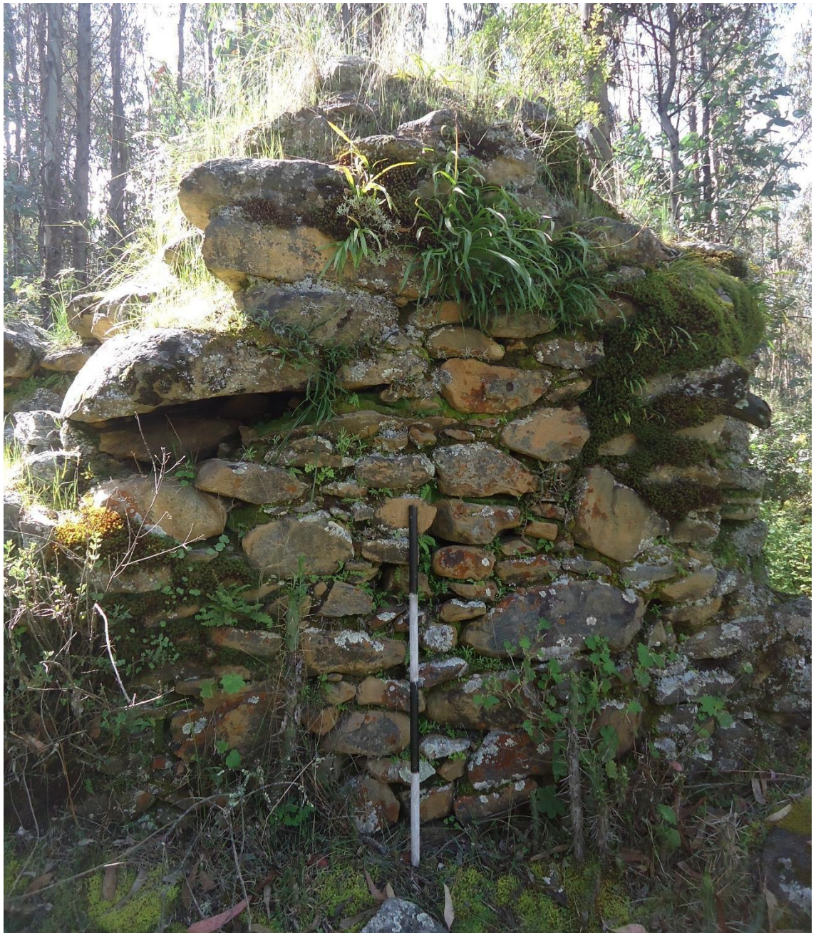
Figura 21. Muro con piedras medianas y pachillas en la Chullpa 1 del Sector B. Fotografía: Macedo Rojas Miguel, Julio 2016.
