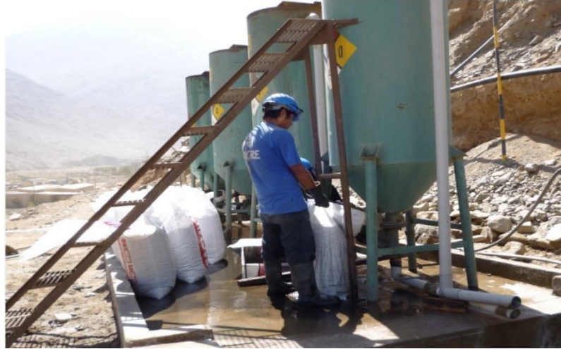
Foto N° 05: Columnas de carbón activado y cosecha de carbón adsorbido
