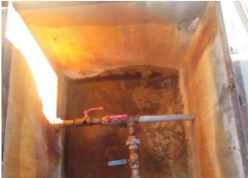
Imagen N° 01: Evidencia de la elevada acidez del agua. A: Deterioro de una moneda. B: Presencia de precipitados rojizos en los tanques de agua potable. C: Corrosión de tuberías de agua potable.
