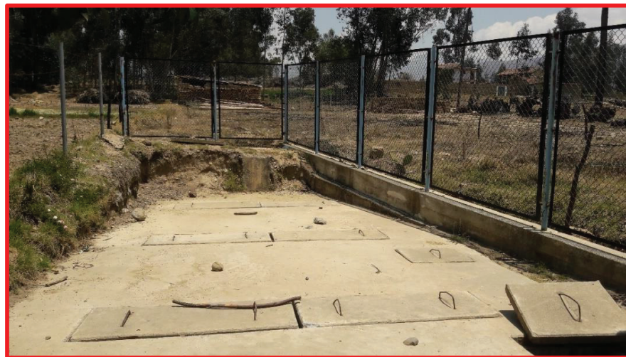
Fotografía 1: Área efectiva del tanque séptico
