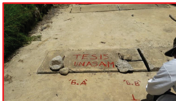
Fotografía 31: Codificando la Tesis en el Tanque Séptico del centro poblado de Marian
