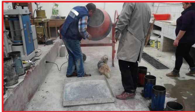
Fotografía 15: Supervisión de la preparación de los agregados en la Mezcladora de Concreto.
