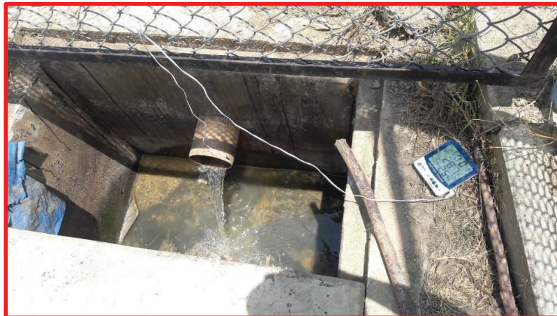
Fotografía 3: Caudal de entrada a la cámara de rejas y la toma de la humedad relativa y temperatura.
