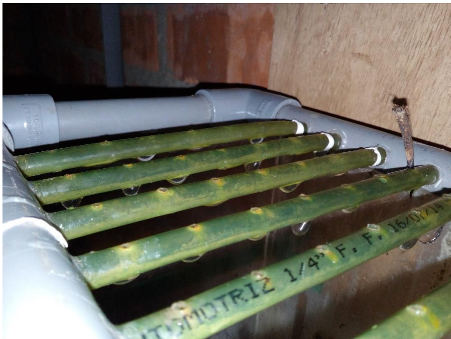
Figura 6.A: Distribuidor de caudal del reactor DHS G-6.
