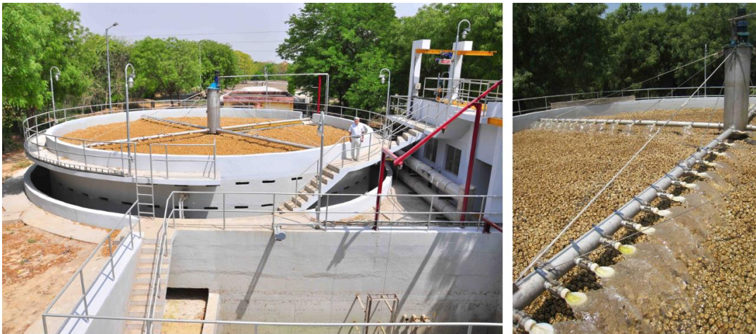
Figura 1.1.5. Vista completa del reactor DHS construido en la planta de tratamiento de aguas residuales en Agra City, a gran escala.
