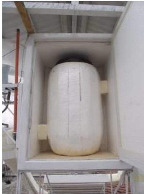
Fotografía: Caja para el tanque de almacenamiento de agua caliente
