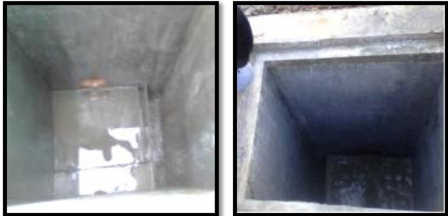
Fotografía 6: Buzón rectangular de Captación del Caudal. Fuente. Trabajo de Campo.
