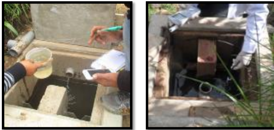
Fotografía 16: Medición de parámetros físicos en el ingreso y salida del humedal.
