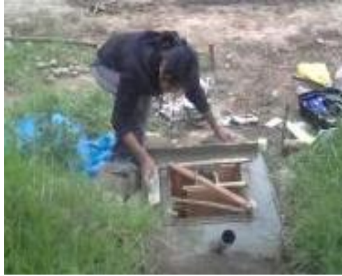
Fotografía 43: Vaciado de concreto en las paredes de la CDQ. Fuente. Trabajo de Campo.
