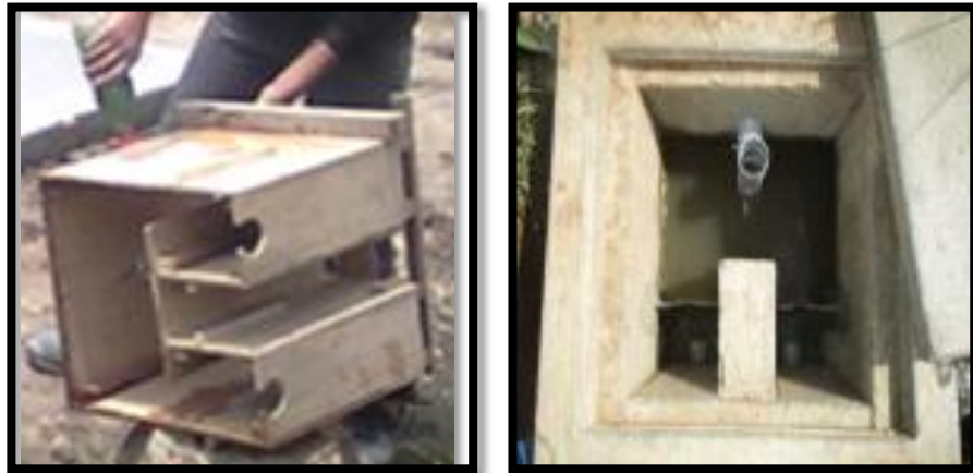
Fotografía 8: Caja de Distribución de Caudal. Fuente. Trabajo de Campo.
