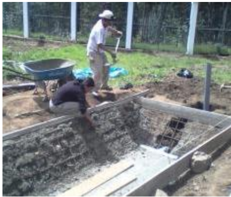
Fotografía 36: Vaciado de concreto por capas a las paredes del humedal y su respectiva chuseada. Fuente. Trabajo de Campo.
