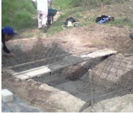
Fotografía 32. Vaciado de concreto en el piso del humedal. Fuente. Trabajo de Campo.
