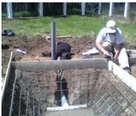
Fotografía 34: Instalación de la tubería recolectora del efluente tratado del humedal. Fuente. Trabajo de Campo.
