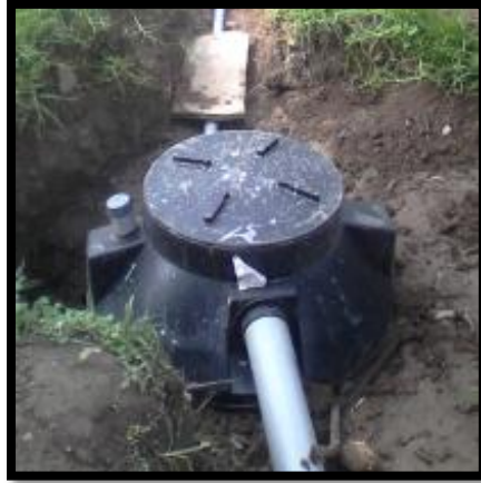
Fotografía 7: Biodigestor. Fuente. Trabajo de Campo.
