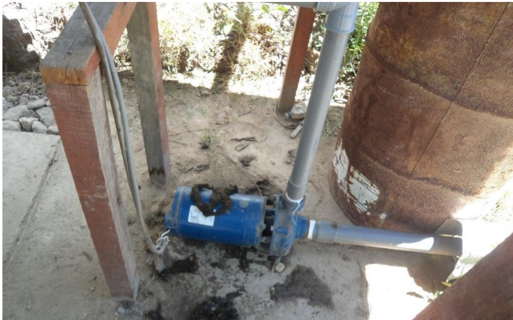
Figura D 4. Motobomba de succión desde el reservorio
