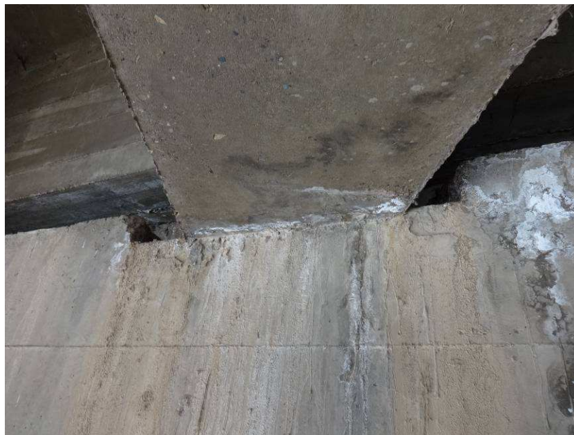
Foto CE-10 : Apoyo de viga principal sobre estribo, no cuenta con elemento de amortiguación.
