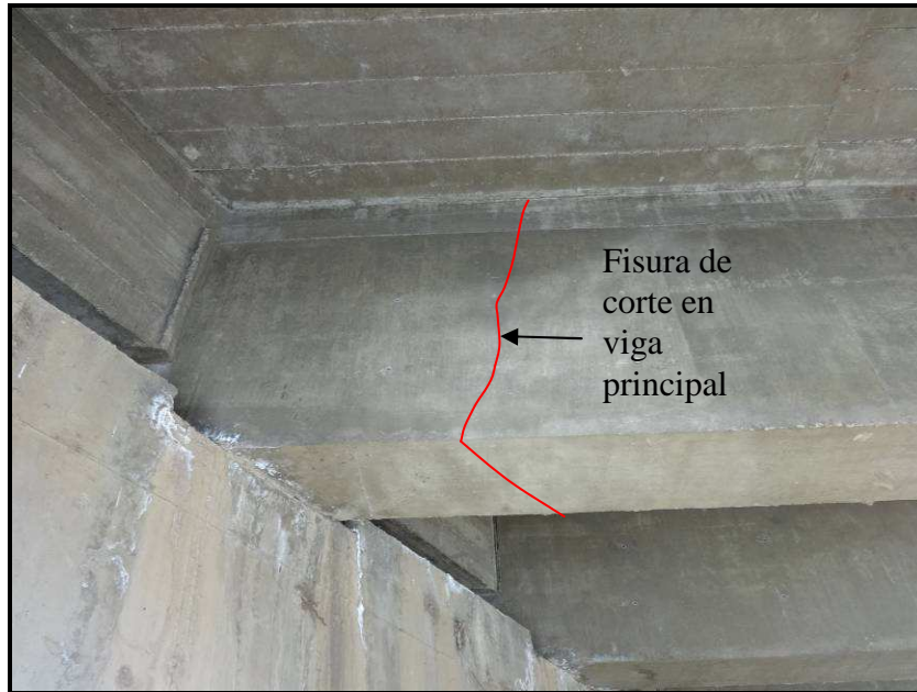
Foto CE-07 : Viga principal con presencia de fisuras en todo el contorno de su sección.
