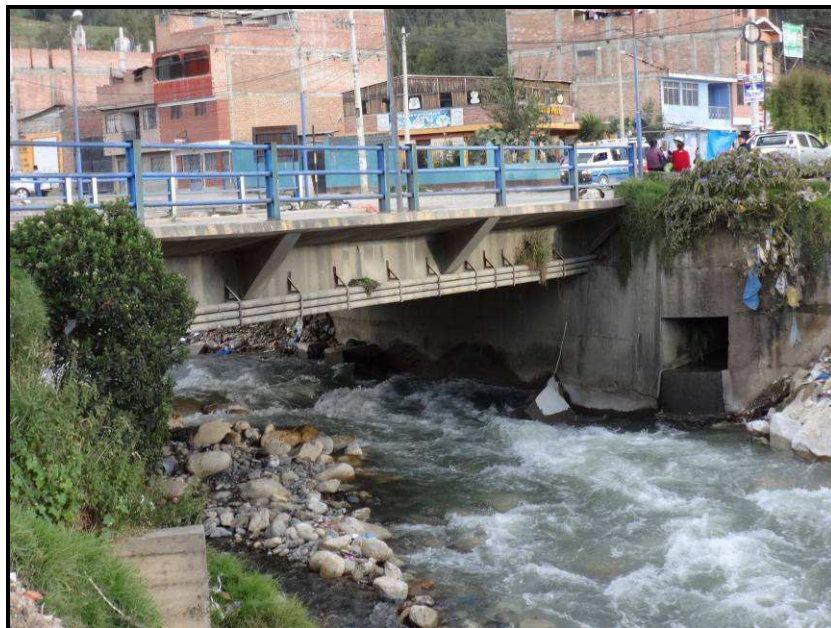
Foto CE-04 : Socavación de la base de los estribos, se observa la falla de los dados de protección.
