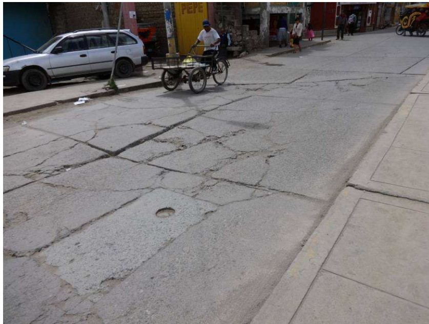
Foto B-14 : Colapso de pavimento rígido que permite el acceso al puente.
