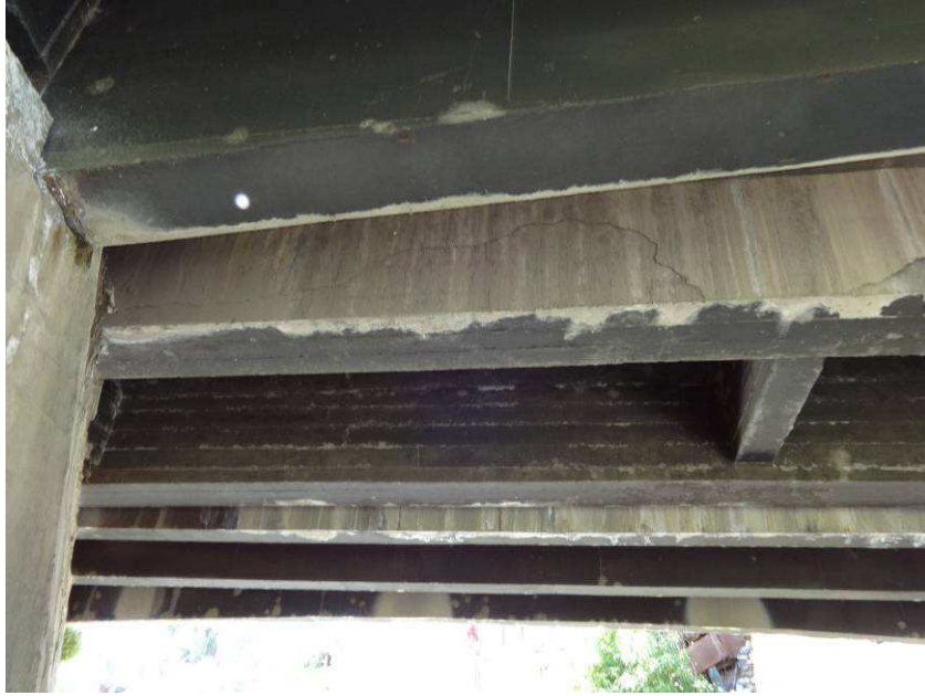
Foto B-09 : Desmoronamiento del concreto en viga principal del puente central.
