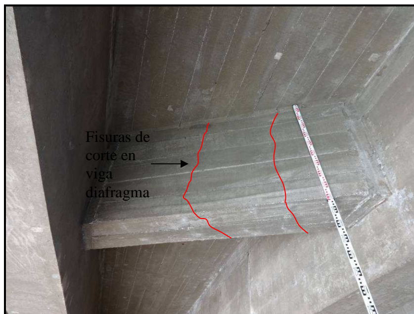
Foto CE-08 : Viga diafragma con presencia de fisuras en todo el contorno de su sección.
