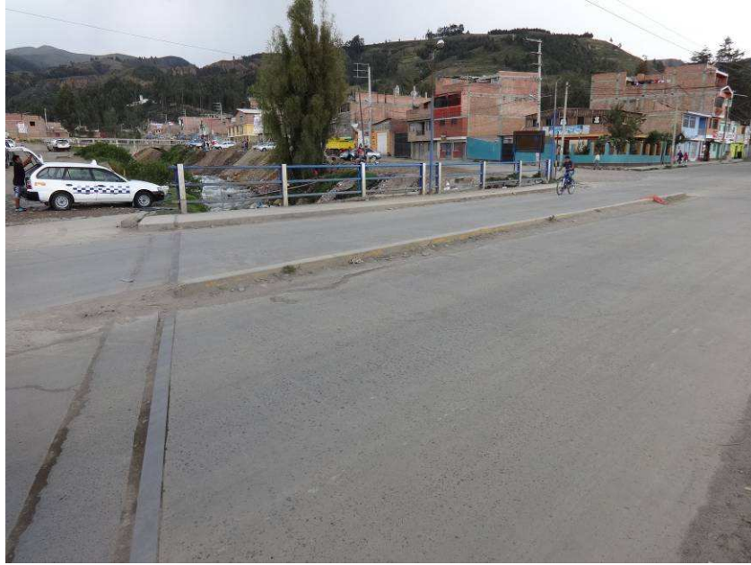
Foto CE-11 : Deterioro de la superficie de rodadura.
