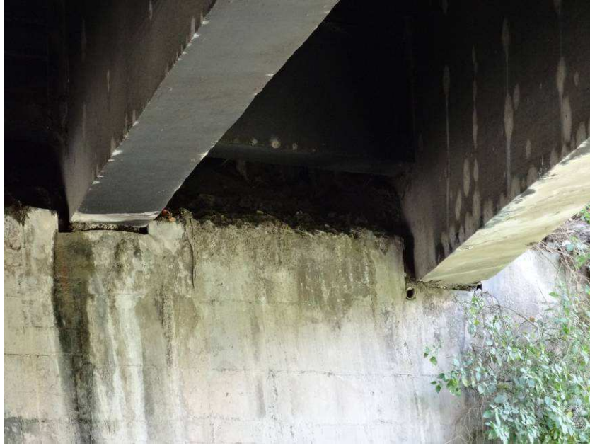
Foto B-07 : Todos los apoyos de viga principal sobre estribo, no cuenta con elemento de amortiguación.
