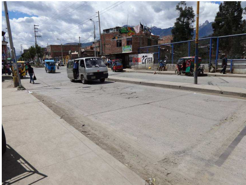
Foto B-12 : Deterioro acelerado de la superestructura.
