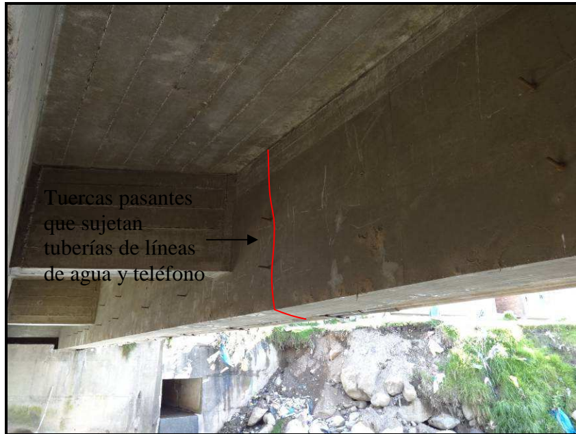
Foto CE-09 : Fisuras de contorno en viga principal, causado por perno pasante de sujeción de tuberías.
