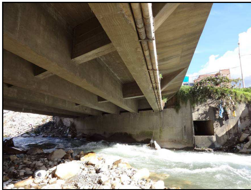
Foto CE-06 : Vigas principales perforados en volado de vereda, se observa el anclaje de tuberías de teléfono a través de pernos pasantes.
