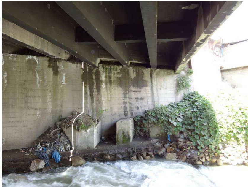
Foto B-04 : Socavación de la base de los estribos, se observa la falla de los dados de protección, margen izquierdo.
