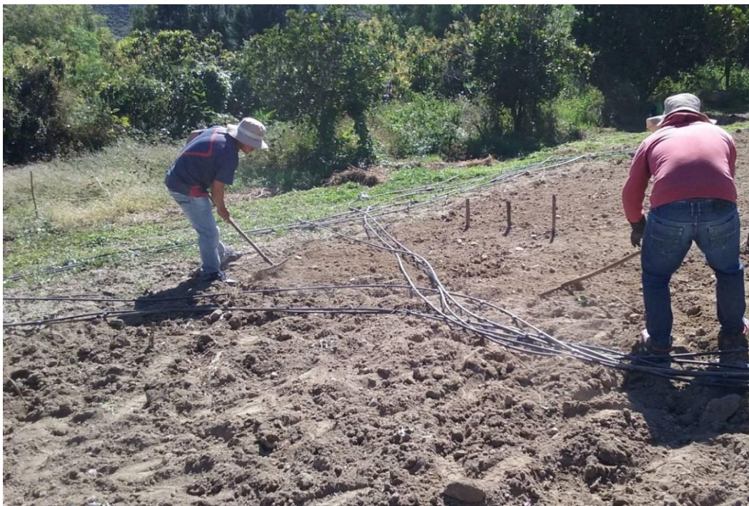
Imagen 1. Instalación de riego por goteo para el cultivo de fresa Fuente: Elaboración propia
