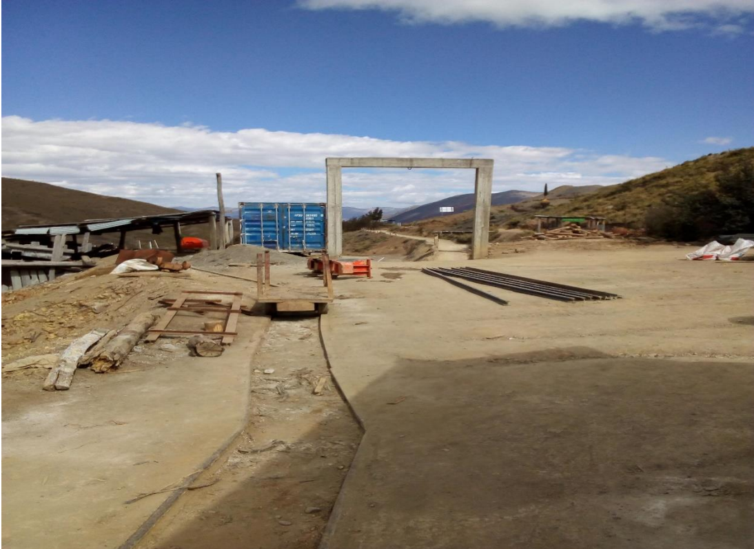
Fotografía N° 03: Falta orden en el área de almacén
