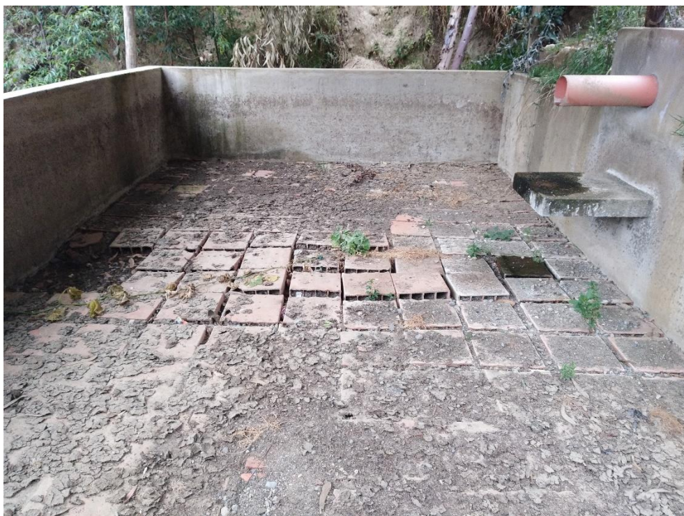
Fotografía N° 16: Lecho de secado de lodos – PTAR C.P. Marián
