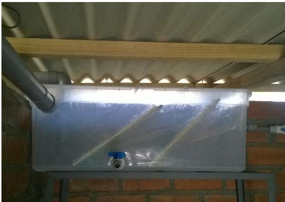
Fotografía N° 5: Sedimentador primario piloto
