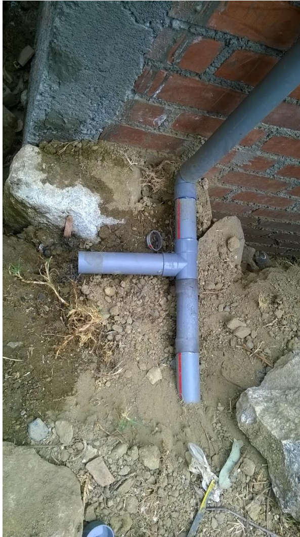
Fotografía N° 3: Tubería de purga al ingreso de la caseta
