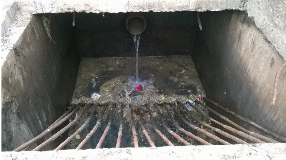
Fotografía N° 14: Cámara de rejas – PTAR C.P. Marián
