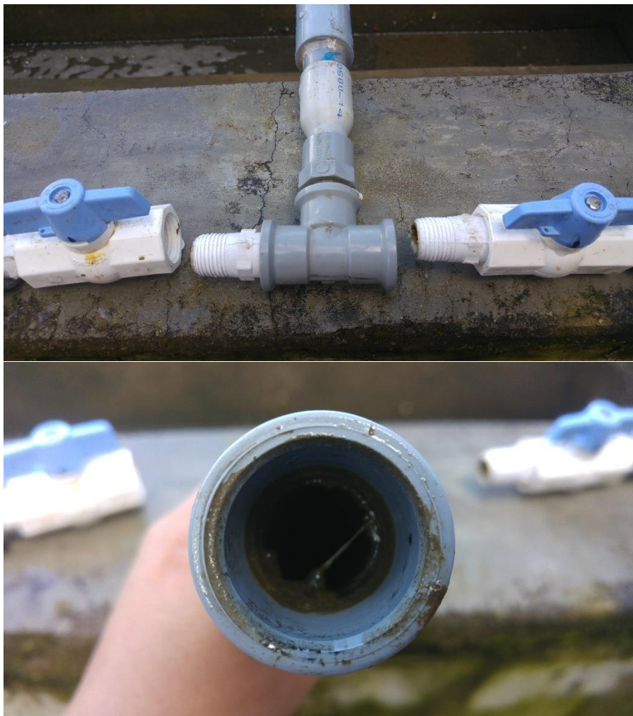
Fotografía N° 13: Problemas de obstrucción en el sistema de distribución del caudal
