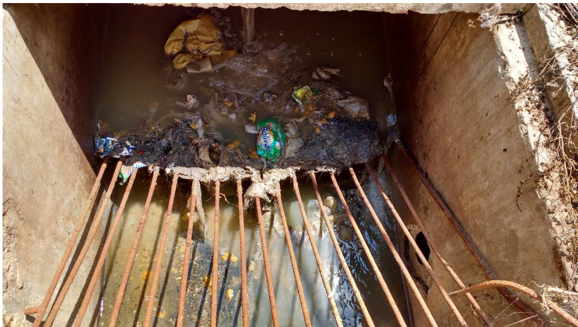
Fotografía N° 22: Condiciones actuales de la cámara de rejas. PTAR C.P. Marián
