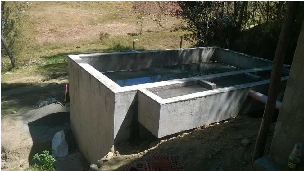
Fotografía N° 17: Filtro anaerobio de flujo ascendente – PTAR C.P. Marián
