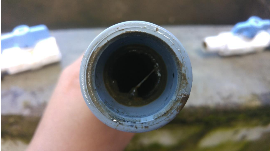
Fotografía N° 42: Formación de biopelícula al interior de las tuberías.
