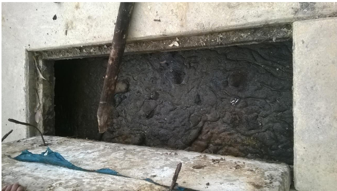
Fotografía N° 23: Condiciones de operación del tanque séptico. PTAR C.P. Marián
