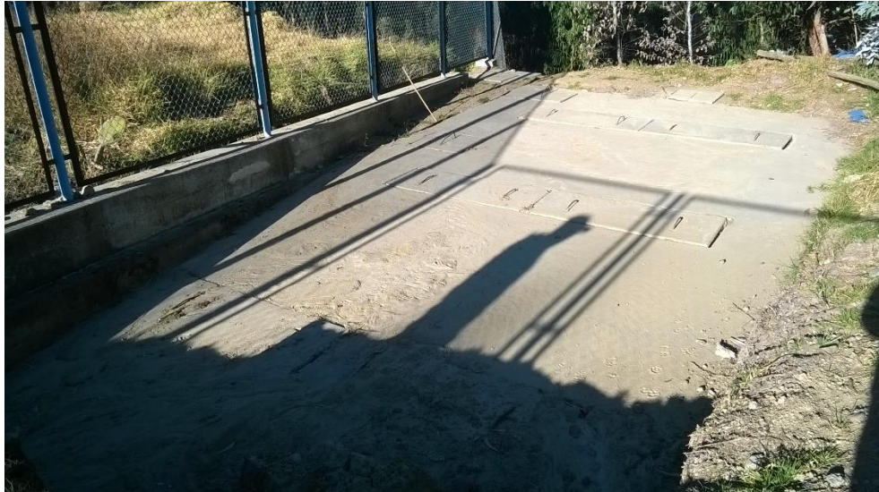
Fotografía N° 15: Tanque séptico – PTAR C.P. Marián
