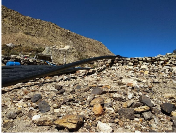
Imagen 69 Tuberías en el dique
