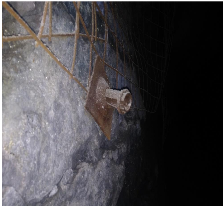
Fotografía N°17, Oxidación del elemento de sostenimiento.
