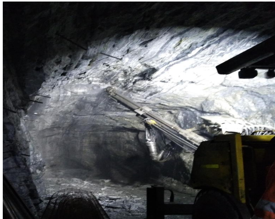
Fotografía N° 04: Sobre dimensionamiento del sostenimiento en terrenos de calidad regular-malo tipo IIIB
