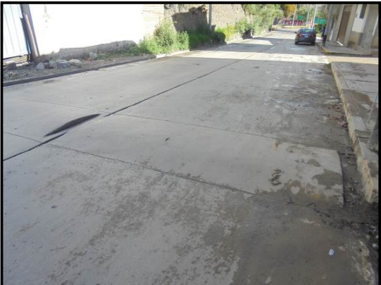
Fotografía 51. En el Km 74+030, presencia de giba al ingreso al distrito de San Marcos (sin existir señalización alguna que advierta la presencia de esta giba).
