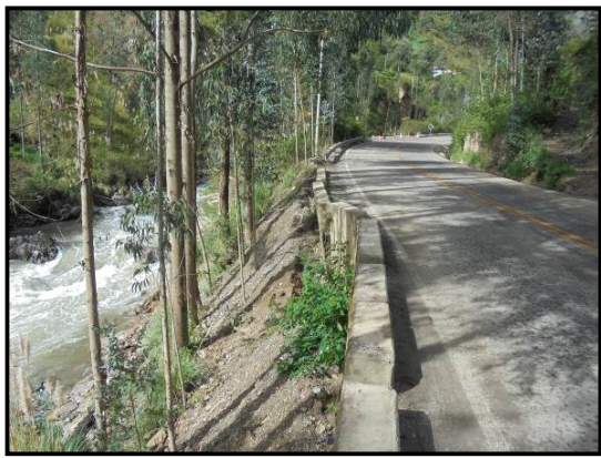
Fotografía 23. En el Km 61+630, fractura del muro de contención del terraplén, que genera inconvenientes con el alineamiento de la calzada.
