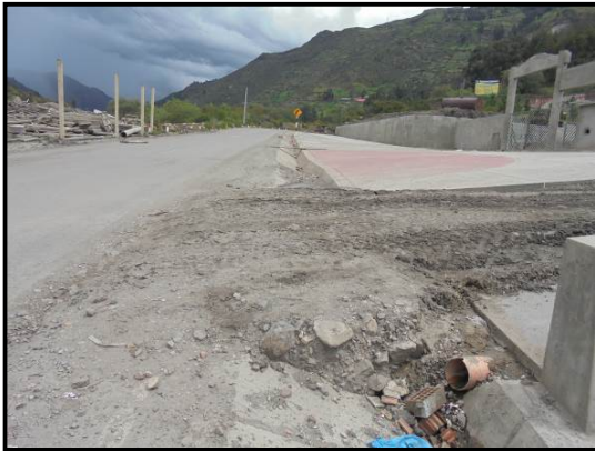
Fotografía 12. En el Km 70+420, la ausencia de un adecuado ingreso a la obra del estadio de Chavín, genera la acumulación de material sobre la calzada impidiendo la clara definición de ella.
