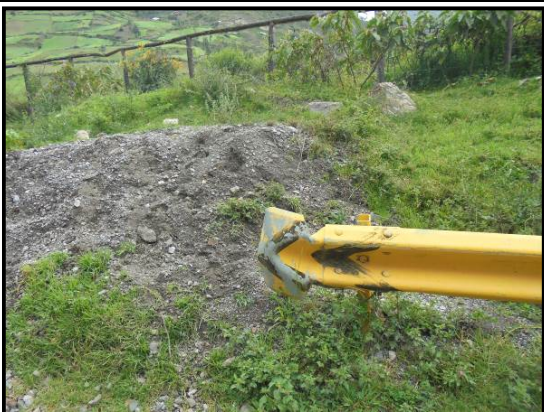
Fotografía 63. En el Km 66+370, terminación incorrecta (tipo cola de pez) que genera riesgo para los vehículos que hacen uso de la vía.
