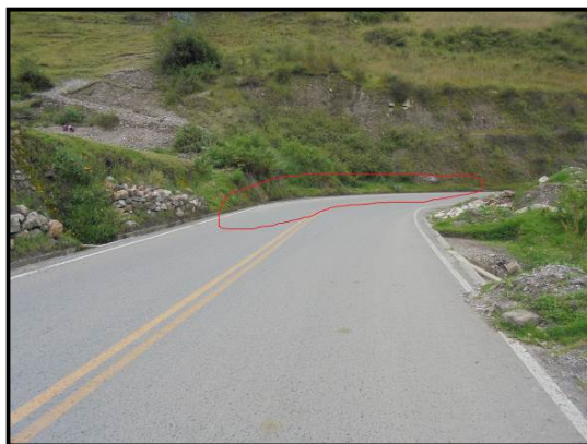
Fotografía 58. En el Km 66+500, falta la instalación de delineadores verticales para así definir claramente la curva de la vía (la calzada está definida por las líneas de borde y línea central) o la instalación de una barrera de contención.
