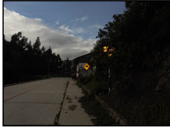
Fotografía 42. En el Km 59+930, señal vertical cubierta por la vegetación que no es legible en horas de la tarde (aprox. 6:30pm).
