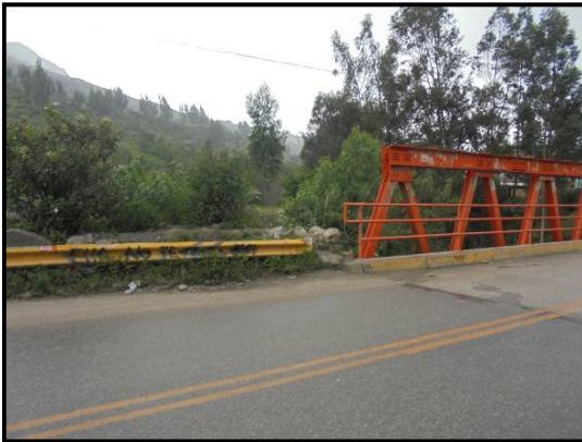
Fotografía 61. En el Km 73+890, no existes continuidad entre la barrera del puente “San Marcos” y la barrera de contención de la vía.
