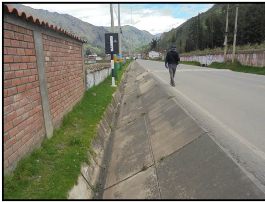
Fotografía 35. En el Km 67+660, la pendiente de la cuneta es demasiado pronunciada (57.6%), siendo insuperable por un vehículo.
