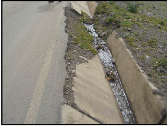
Fotografía 65. En el Km 61+220, fractura de cuneta, desprendimiento de material granular de la carpeta asfáltica.
