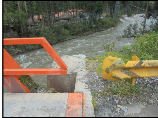
Fotografía 60. En el Km 65+760, no existe continuidad entre la barrera del puente “Uchucurhga” y la barrera de contención de la vía.
