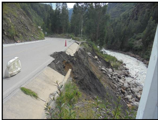
Fotografía 73. En el Km 60+730, fractura de la cuneta del lado del terraplén, por el deslizamiento del terraplén.
