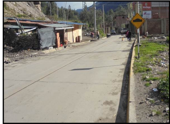
Fotografía 54. Entre el Km 73+890 al Km 74+100, la línea de borde inexistente (y muy tenue en algunos casos).
