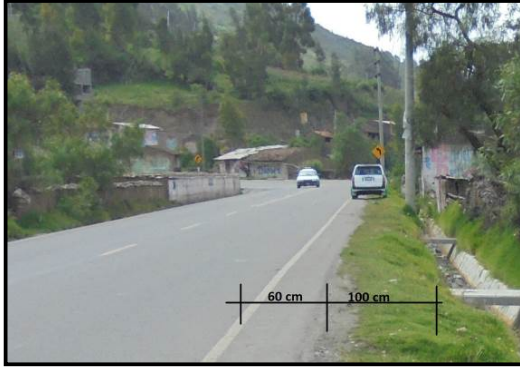
Fotografía 07. En el Km 69+150, berma de 60cm y espacio utilizable antes de la cuneta un metro, en caso de maniobra de adelantamiento podría ser inseguro.
