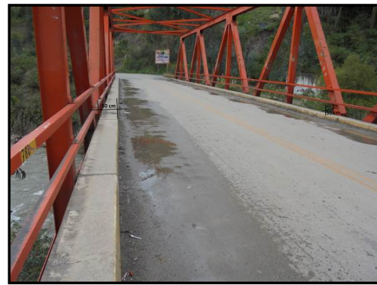
Fotografía 26. En el Km 65+760 se ubica el puente “Uchucurhga”, de 50m de longitud, compatible con el ancho de la vía, veredas de 50cm de ancho (75cm ancho mínimo), además de acumulación de agua, no se define claramente la calzada.
