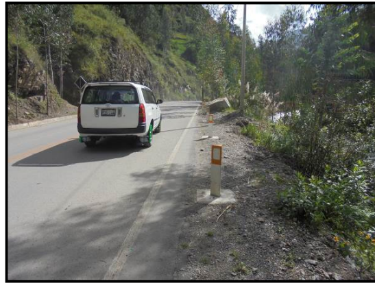
Fotografía 24. En el Km 61+660, delineadores verticales no están correctamente alineados con la calzada.
