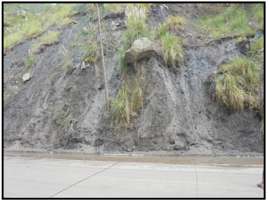
Fotografía 34. En el Km 62+570, caída inminente de un bloque de roca del talud contiguo a la calzada.
