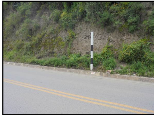
Fotografía 44. En el Km 73+480, presencia solo de soporte vertical (carente de señal).
