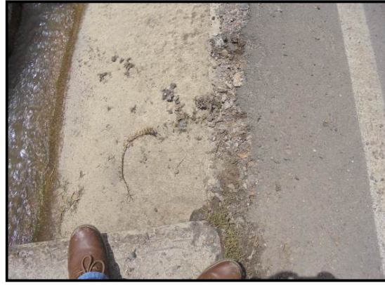
Fotografía 66. En el Km 69+820, mala terminación de la calzada, desprendimiento de material granular.
