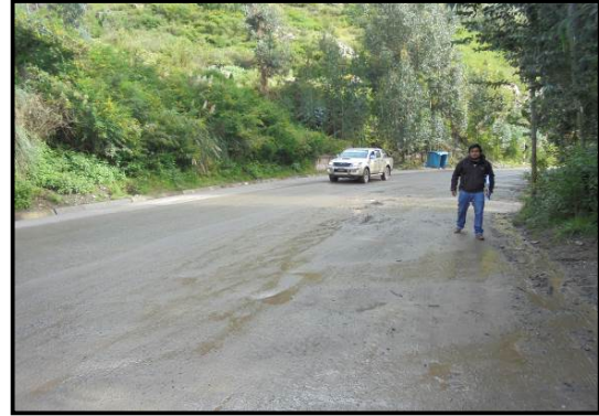
Fotografía 08. En el Km 60+800, acumulación de lodo en la vía, impidiendo la clara definición de está.
