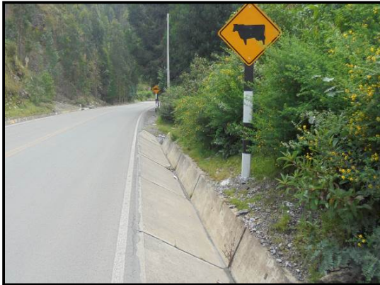
Fotografía 37. En el Km 60+970, mala ubicación de fin de cuneta, a escasos metros (20m) existiendo una alcantarilla.
