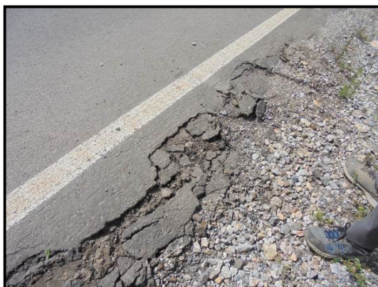
Fotografía 68. En el Km 71+590, fractura por mala terminación del pavimento de la calzada.
