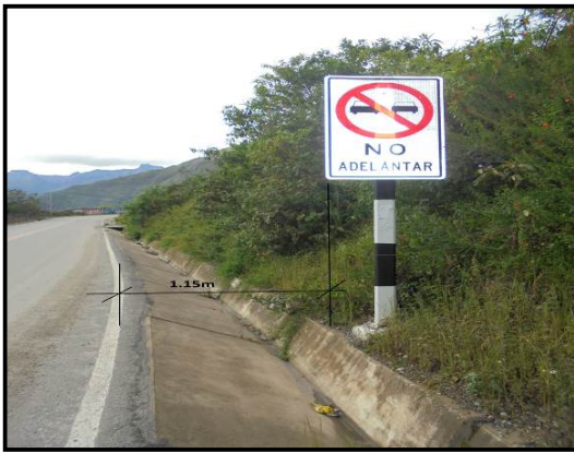
Fotografía 41. En el Km 59+440, señal vertical que no está a una distancia señalada por la norma.
