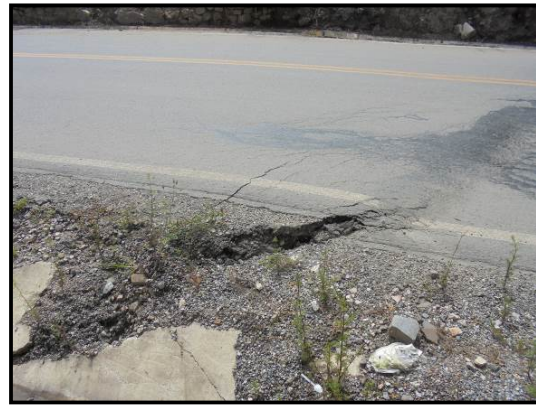
Fotografía 13. En el Km 70+880, debido al asentamiento diferencial ocurrido se genera un fisura que rompe con la continuidad la calzada.
