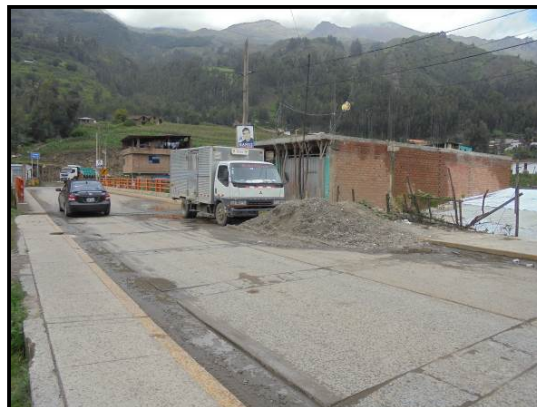
Fotografía 69. En el Km 67+200, presencia de agregados para construcción en la calzada impidiendo el libre tránsito de todo un carril de la vía.
