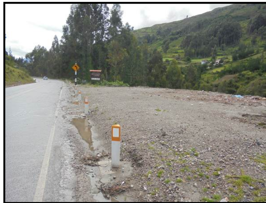
Fotografía 25. En el Km 64+960, presencia de delineadores verticales que impiden el ingreso a la plazuela de cruce, además de no estar alineados a la calzada.
