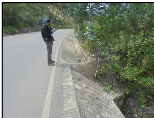
Fotografía 40. En el Km 71+390, mala ubicación de fin de cuneta, se tendría que haber considerado desaguar la cuneta en la alcantarilla.
