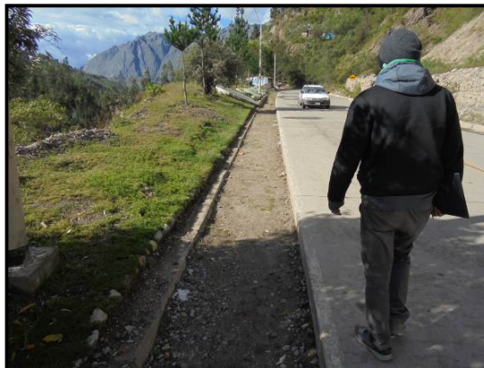
Fotografía 33. Entre Km 74+200 y Km 74+280, la berma no está pavimentada, mostrando una marcada discontinuidad.
