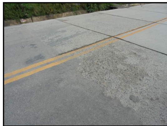
Fotografía 64. En el Km 59+600, desprendimiento de material granular en la junta del pavimento flexible y el pavimento rígido.
