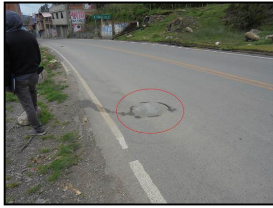
Fotografía 15. En Km 66+850, se advierte la presencia de una tapa (tapa de concreto) de buzón convexo a la superficie de la calzada.
