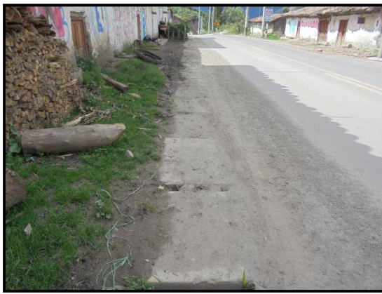
Fotografía 53. En el Km 72+610, acumulación de material granular a lado de la calzada cubriendo la línea de borde.
