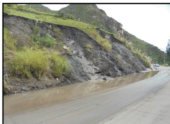
Fotografía 11. En el Km 62+580, el embalsamiento de agua por deslizamiento de lodo impide la clara definición de la calzada.
