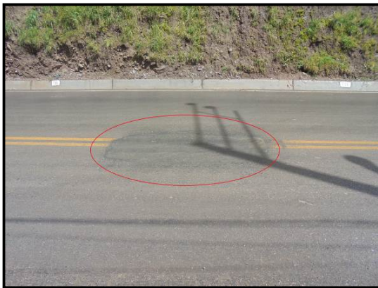
Fotografía 14. En Km 64+710, presencia de un parche en el eje central de la vía
