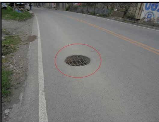
Fotografía 16. En Km 66+870, se advierte la presencia de un buzón sin tapa de concreto.
