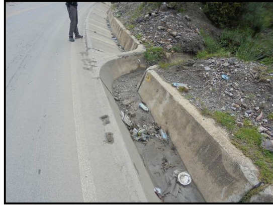
Fotografía 36. En el Km 60+910, presencia de obra de arte que deja mal ubicada el fin de cuneta.
