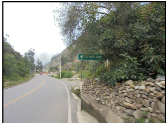
Fotografía 46. En el Km 73+710, vegetación cubre parcialmente la señal vertical, se presume que en poco tiempo será totalmente cubierta.
