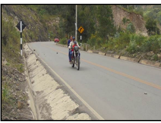
Fotografía 70. En el Km 70+820, presencia de rocas en la calzada, provenientes del talud contiguo de la vía.
