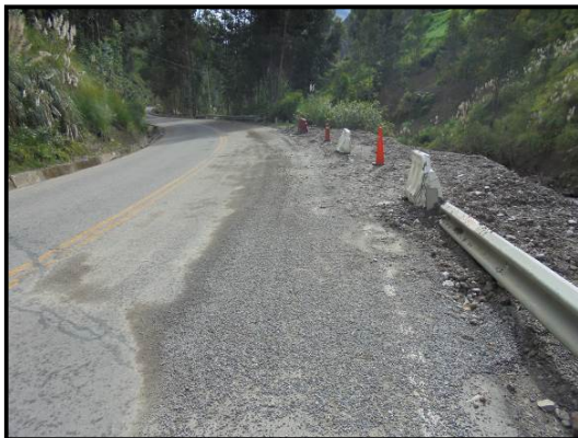
Fotografía 10. En el Km 61+510, presencia de material granular a un lado de la vía que no permite la clara definición de la calzada, además de la barrera de contención incompleta.
