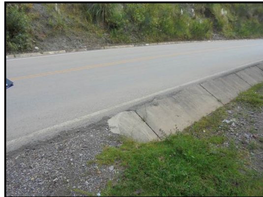
Fotografía 38. En el Km 61+830, mala ubicación de inicio de cuneta, no recaudara adecuadamente las aguas de la calzada.
