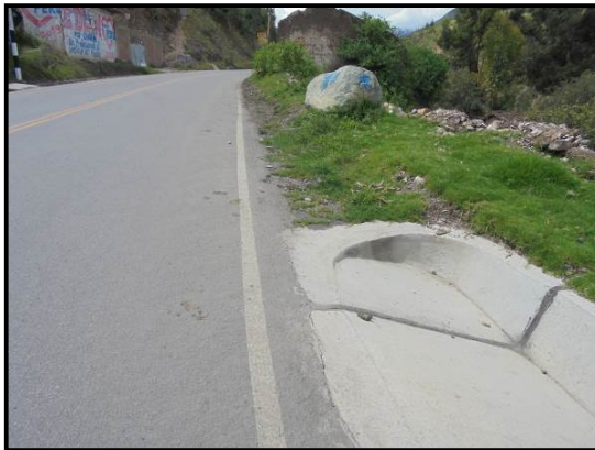
Fotografía 39. En el Km 69+320, mala ubicación de inicio de cuneta, inadecuada recaudación de las aguas.
