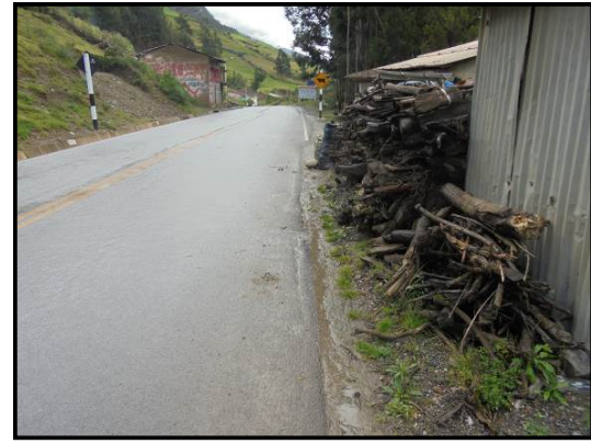
Fotografía 52. En el Km 65+190, presencia elementos externos que afectan a la calzada y genera discontinuidad de la línea de borde.
