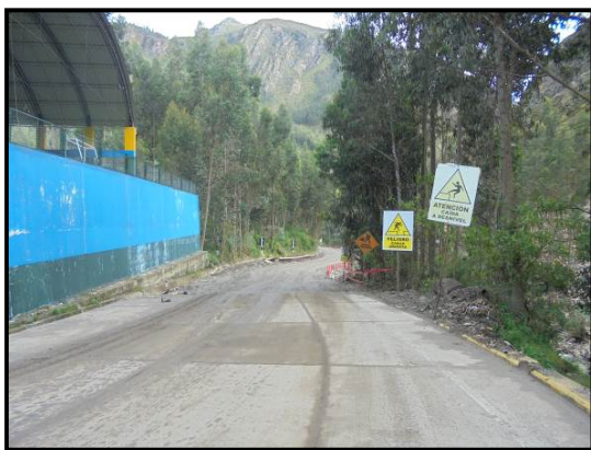
Fotografía 71. En el Km 60+540, presencia de señales verticales provisionales.
