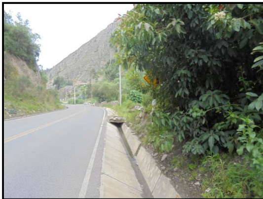
Fotografía 45. En el Km 73+650, vegetación impide la lectura de señal vertical.
