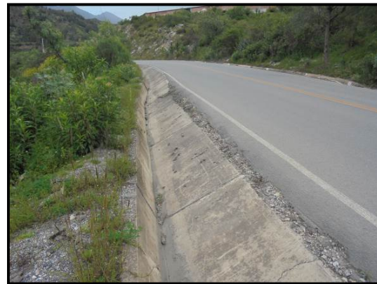
Fotografía 67. En el Km 70+650, mala terminación de la calzada, desprendimiento de material granular.
