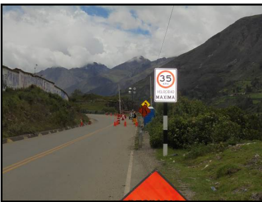
Fotografía 74. En el Km 69+940, punto de control de flujo vehicular por inestabilidad del terraplén.
