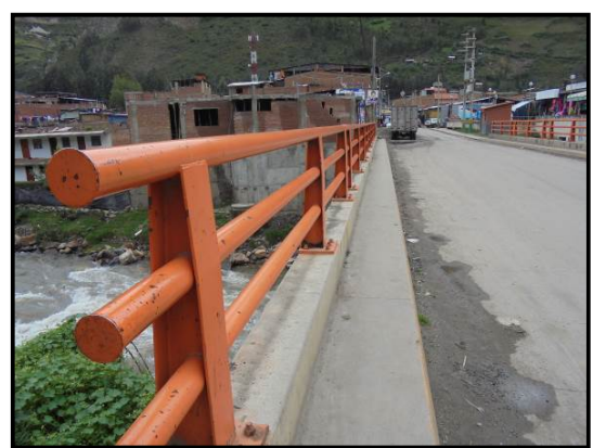
Fotografía 28. En Km 67+160 se ubica el puente “Laos”, de 35m de longitud, compatible con el ancho de la vía, veredas de 60cm de ancho (75cm ancho mínimo), no se define claramente la calzada.
