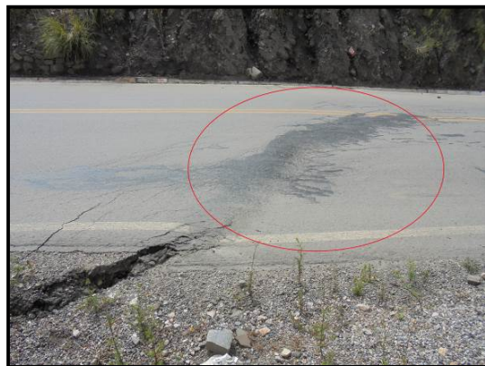
Fotografía 17. En Km 70+880, presencia de tratamiento en la fisura transversal al eje de la calzada.
