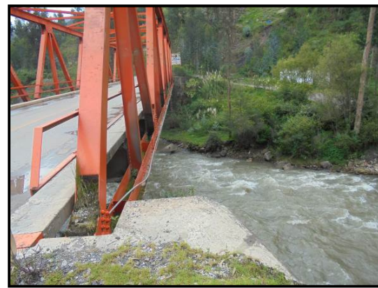
Fotografía 27. El puente “Uchucurhga”, no interseca perpendicularmente al Rio Mosna, necesitando una mayor distancia de la requerida.
