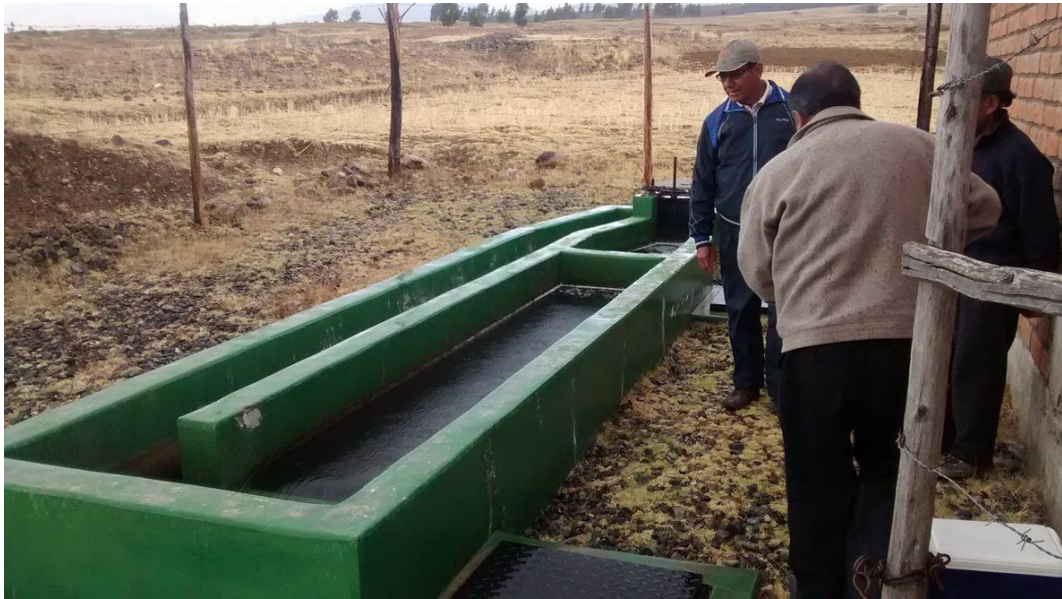
Figura 8: Ingreso del agua al desarenador
