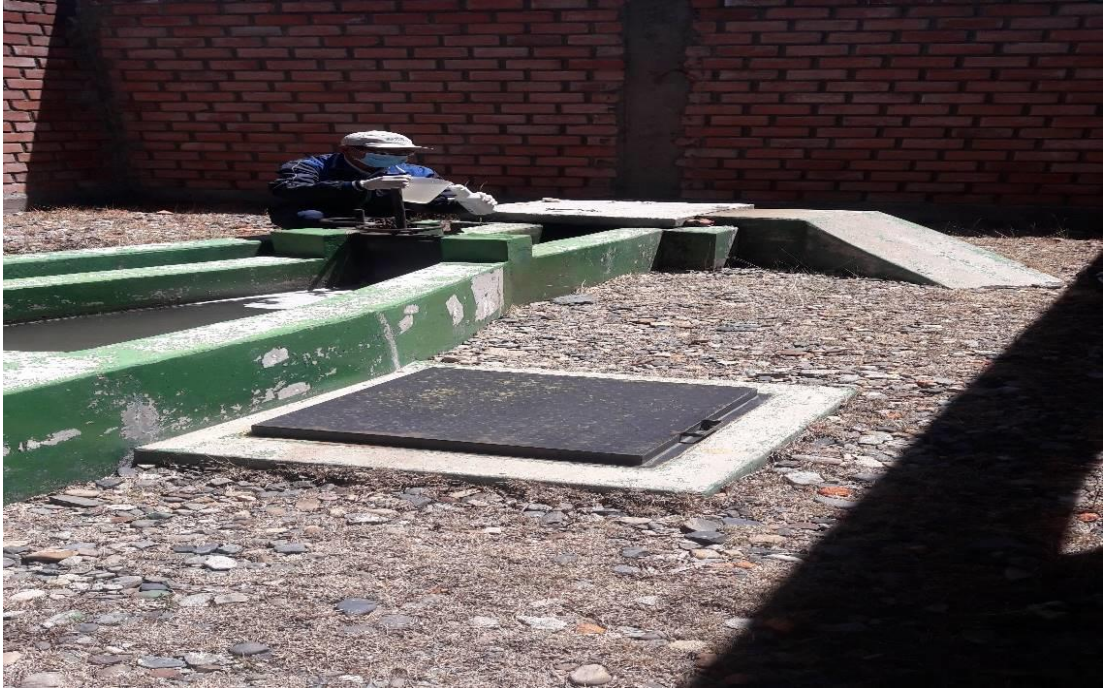
Figura 14: Toma de muestra de agua al ingreso del desarenador
