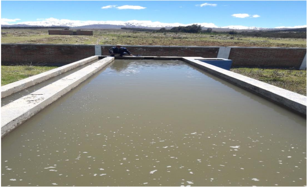
Figura 12: Vista de los filtros
