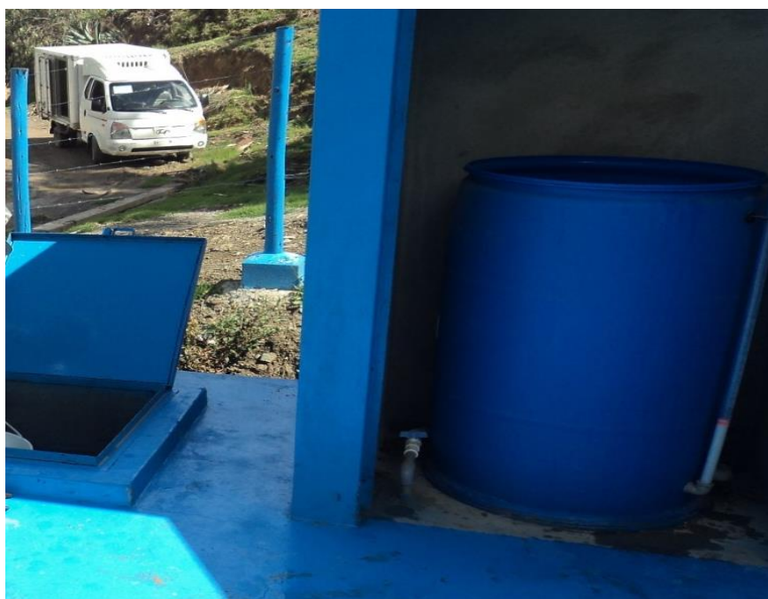
Fotografía 13: Vista general del sistema de cloración por goteo
