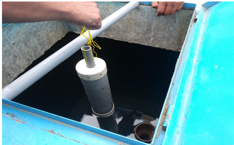
Fotografía 21: Vista de la instalación del sistema de cloración por difusión
