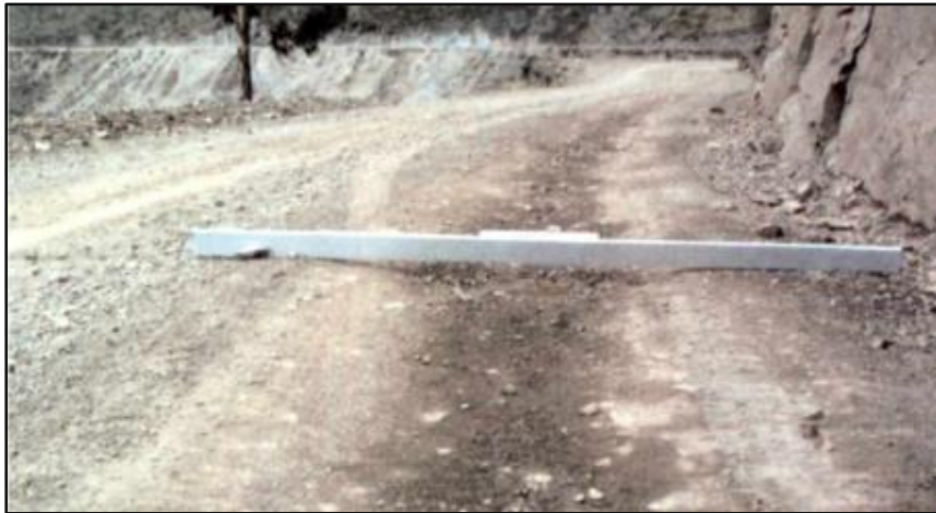
Figura 17. Deformación - Gravedad 3: Huellas/Hundimientos \geq 10 cm.
