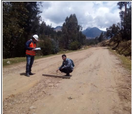
Foto 16: Carretera en malas Condiciones (Daños por Erosion)
