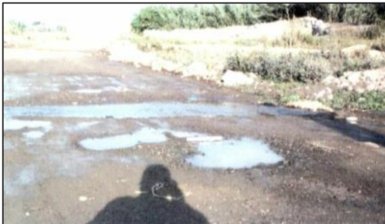
Figura 23. Baches (Huecos) - Gravedad 3: Necesita una reconstrucción.
