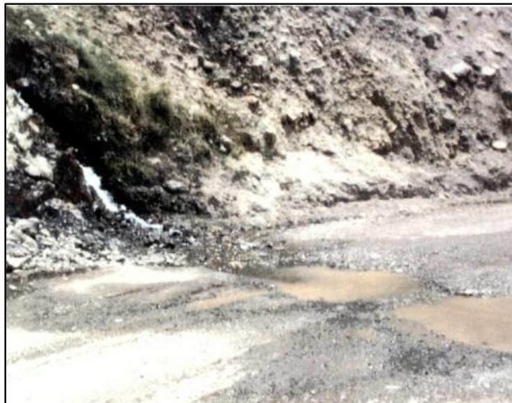
Figura 26. Cruce de aguas
