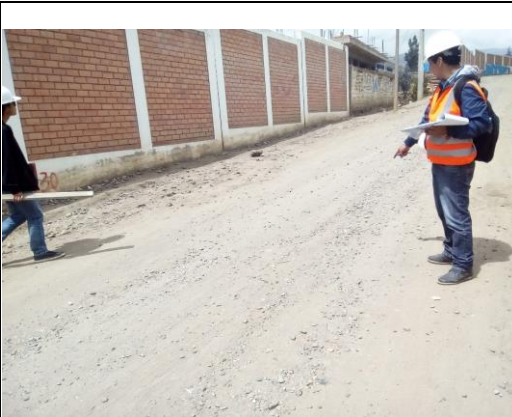
Foto 27: Carretera en malas Condiciones (Daños por Erosion)
