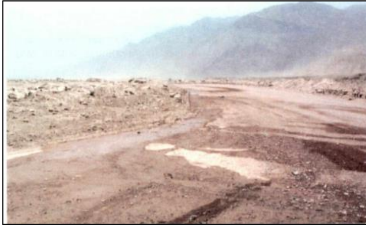
Figura 22. Baches (Huecos) - Gravedad 2: Necesita una capa de material adicional.
