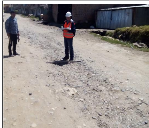
Foto 06: Carretera en malas Condiciones KM 01+000 (Daños por Erosion)
