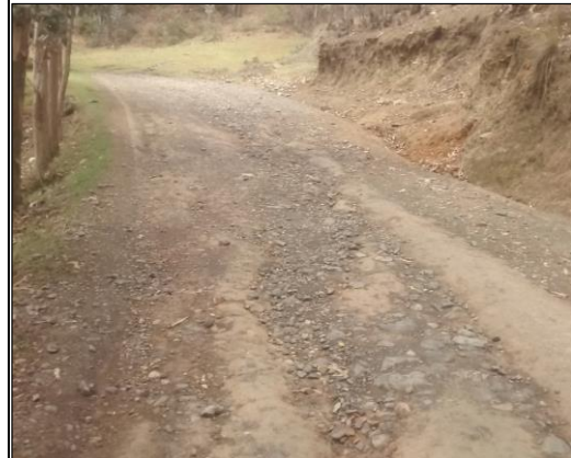
Foto 40: Carretera en malas Condiciones (Daños por Erosion)
