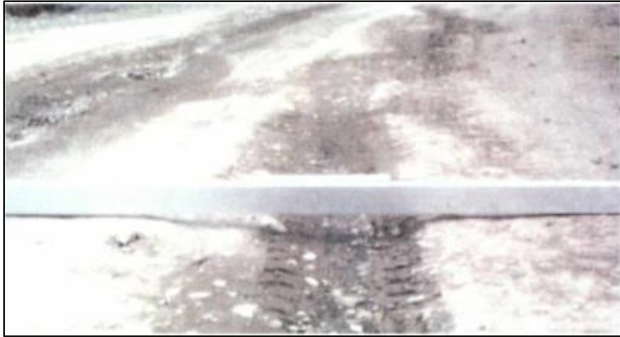
Figura 19. Erosión - Gravedad 2: Profundidad entre 5 cm y 10 cm. Fuente: Manual de Carreteras de Mantenimiento, MTC-2014.
