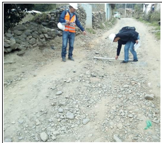
Foto 30: Carretera en malas Condiciones (Daños por Erosion) Km 04+950
