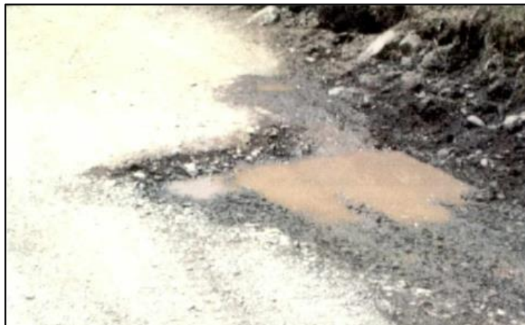
Figura21. Baches (Huecos) - Gravedad 1: Pueden repararse por mantenimiento rutinario.
