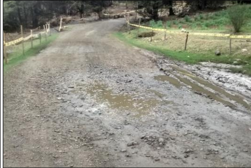
Foto 37: Carretera en malas Condiciones (Daños por Deformacion) Km 06+000
