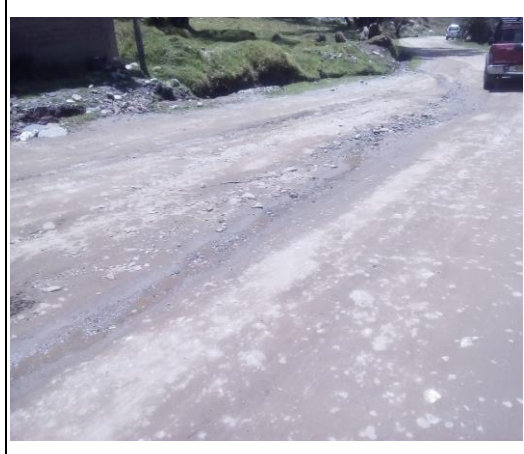
Foto 14: Carretera en malas Condiciones (Daños por Erosion)
