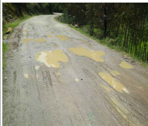
Foto 41: Carretera en malas Condiciones (Daños por Baches)
