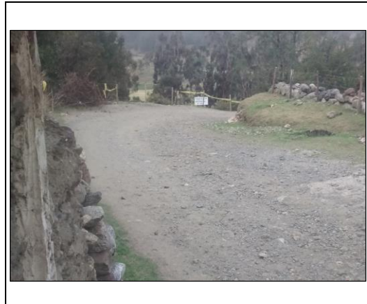
Foto 36: Carretera en malas Condiciones (Daños por Baches) Km 05+925
