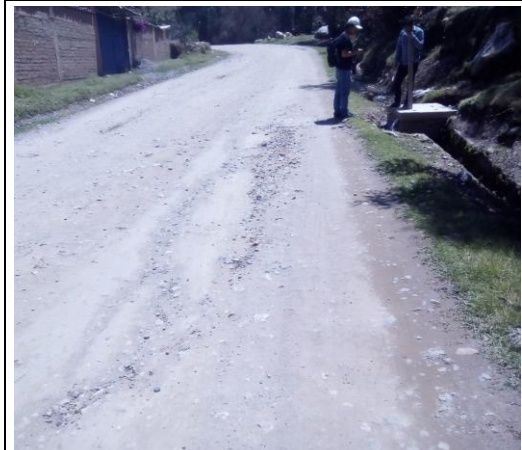
Foto 12: Carretera en malas Condiciones KM 02+000 (Daños por Erosion)
