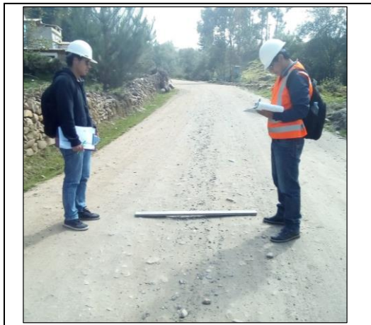
Foto 18: Carretera en malas Condiciones (Daños por Encalaminado)
