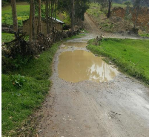
Foto 43: Carretera en malas Condiciones (Daños por Deformacion) Km 07+115
